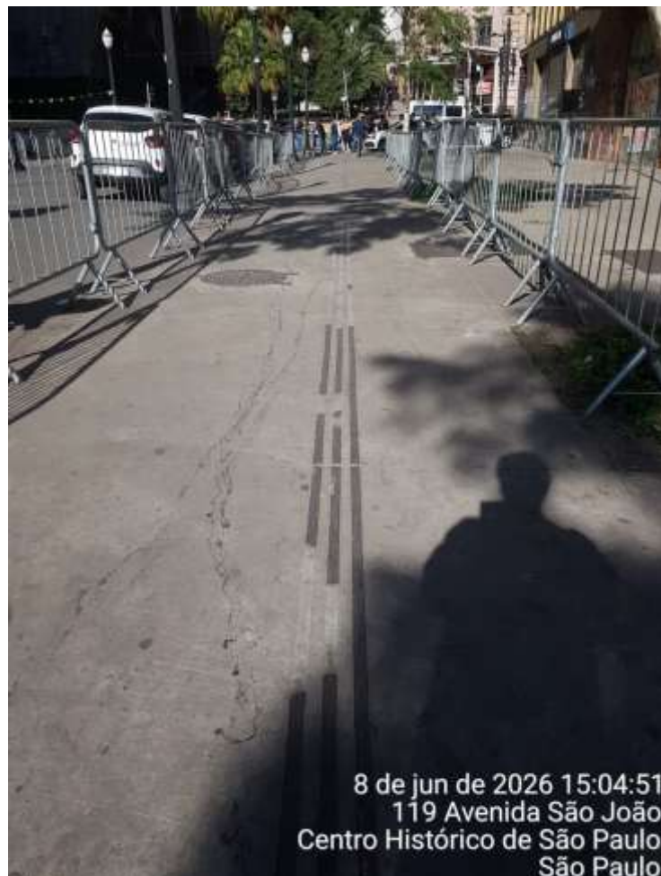
Falhas e/ou ausência do Piso Podotátil
