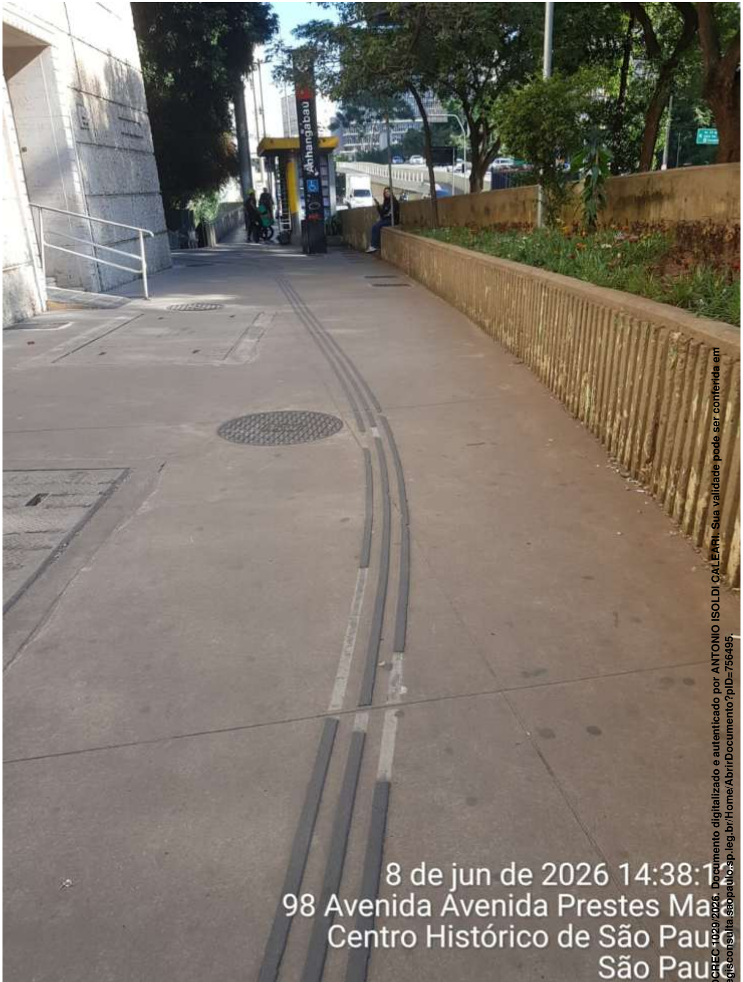
Falhas e/ou ausência do Piso Podotátil
