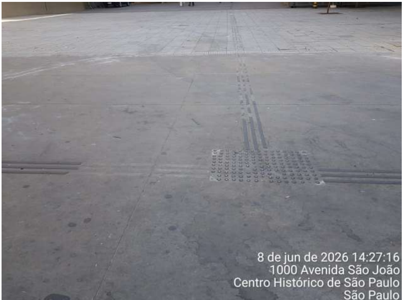
Falhas e/ou ausência do Piso Podotátil
