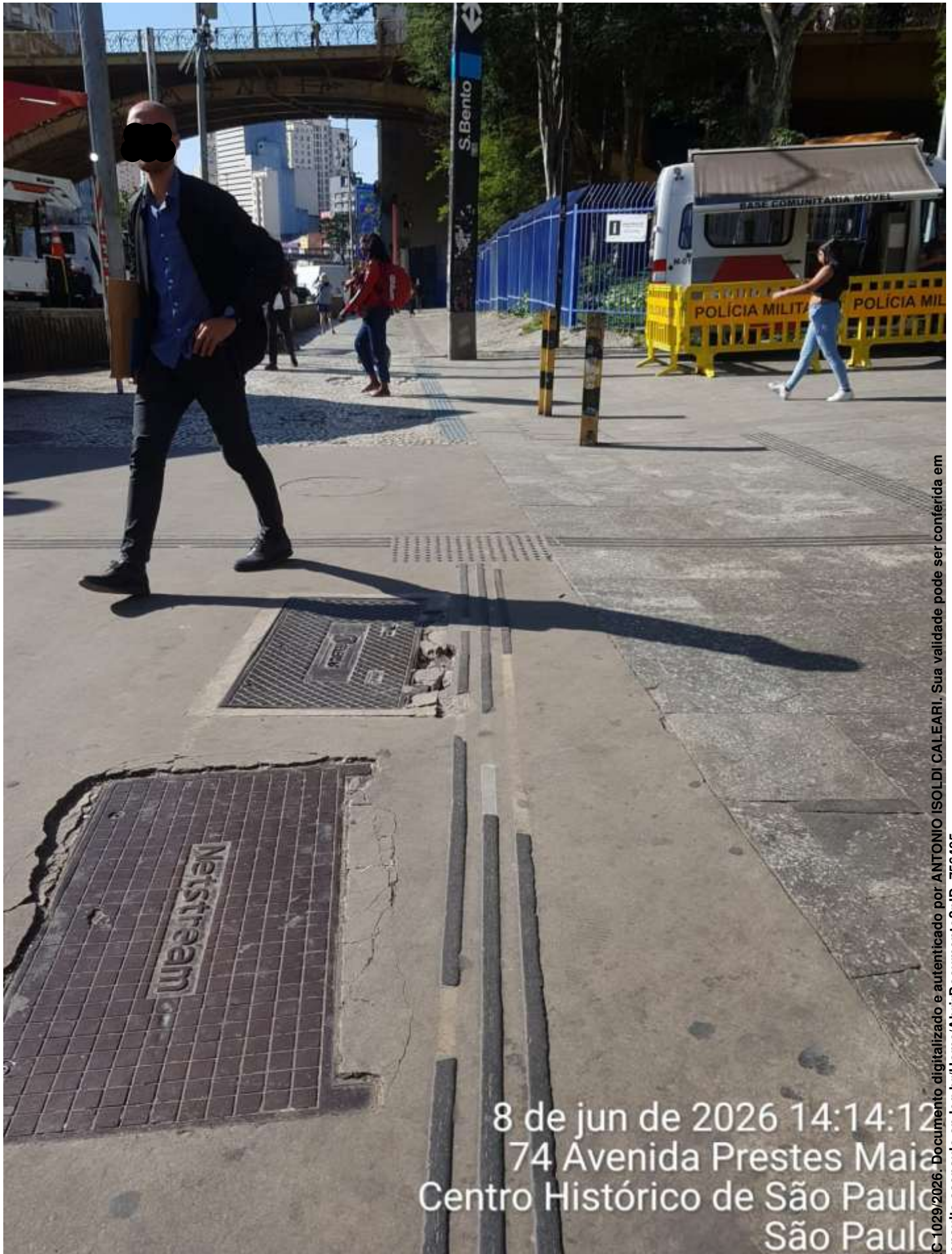
Falhas e/ou ausência do Piso Podotátil
