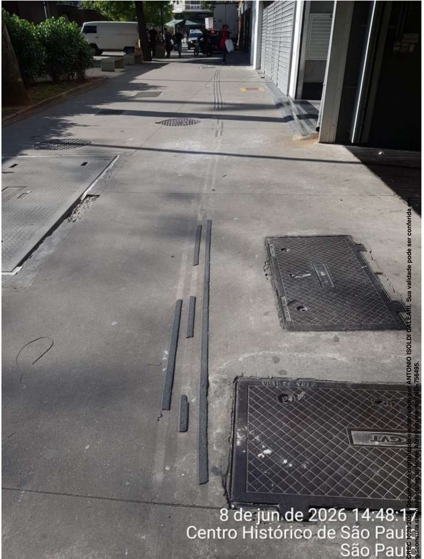
Falhas e/ou ausência do Piso Podotátil
