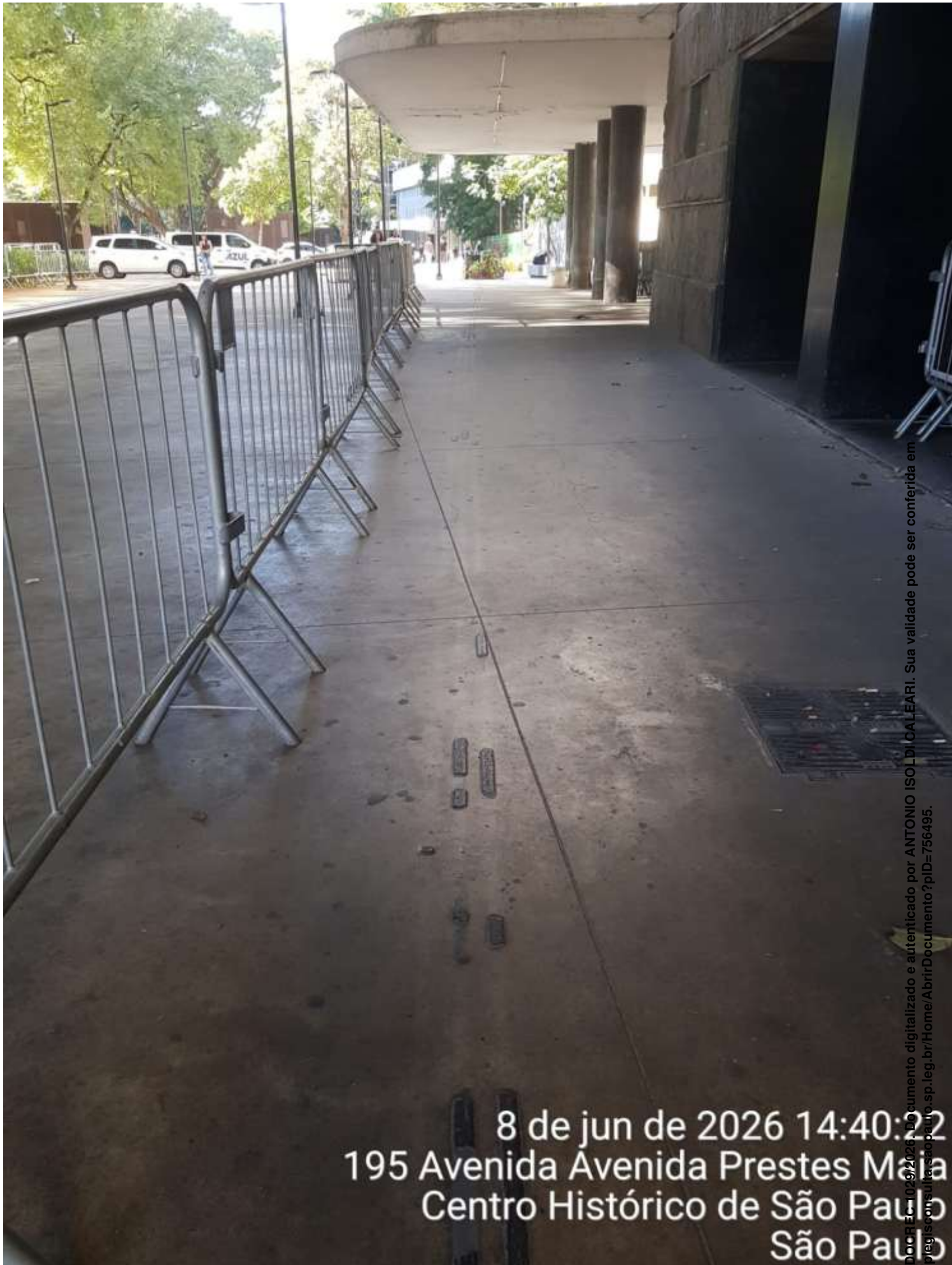
Falhas e/ou ausência do Piso Podotátil
