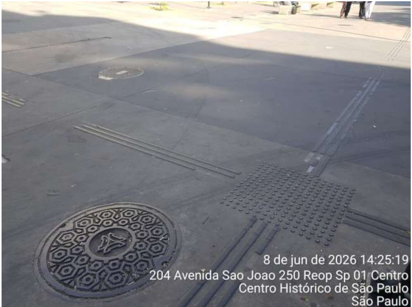
Falhas e/ou ausência do Piso Podotátil
