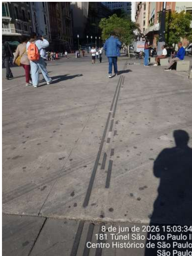
Falhas e/ou ausência do Piso Podotátil
