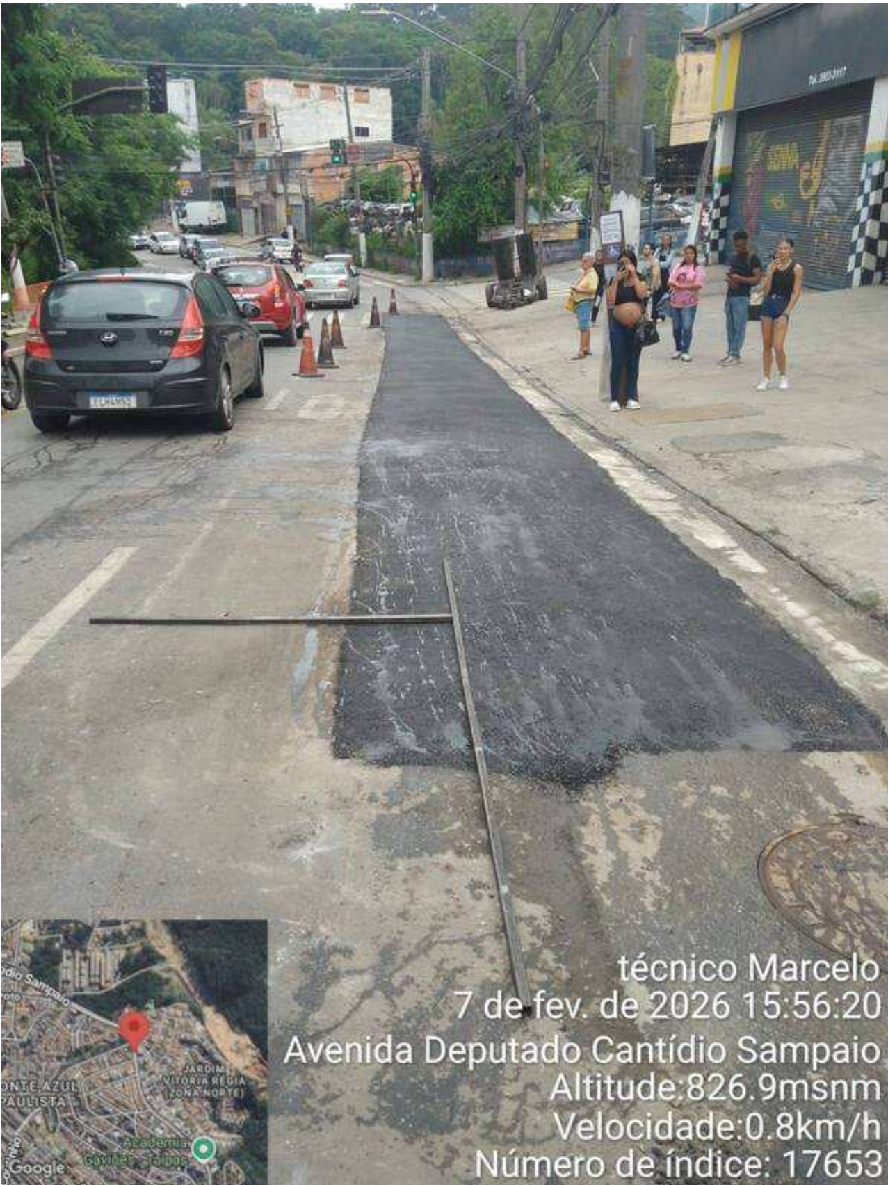
8 | ACABAMENTO → Irregularidade da via após caixa pronta: Item de OS APLICAÇÃO DE MASSA DA CONCORDÂNCIA Origem: 15107519 - (Foto Capturada Em: 08/02/26 19:43, Por: mxintadm)
