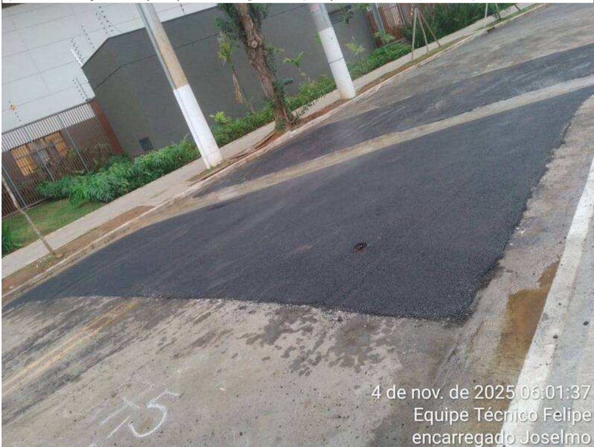
8 | ACABAMENTO → Irregularidade da via após caixa pronta: Item de OS Origem: 14409012 - (Foto Capturada Em: 05/11/25 03:51, Por: mxintadm)
