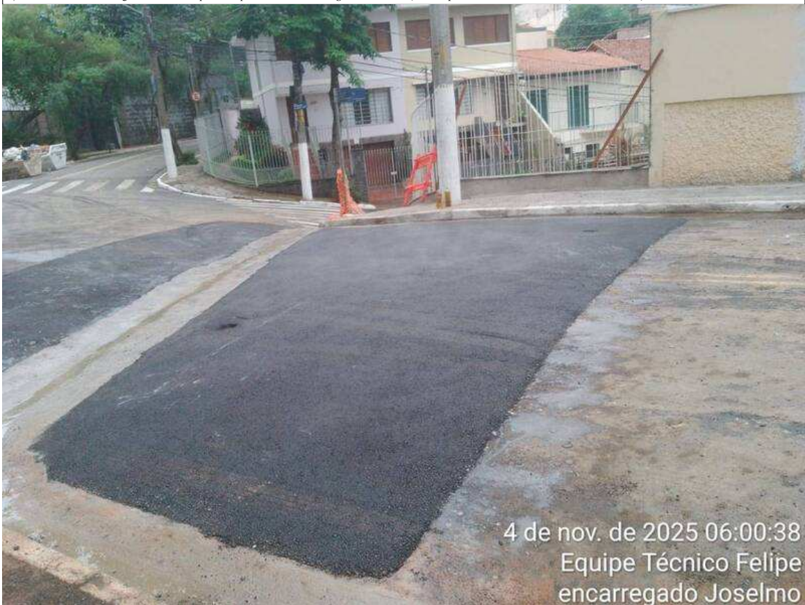
10 | ACABAMENTO → Irregularidade da via após caixa pronta: Item de OS Origem: 14409012 - (Foto Capturada Em: 05/11/25 03:51, Por: mxintadm)
