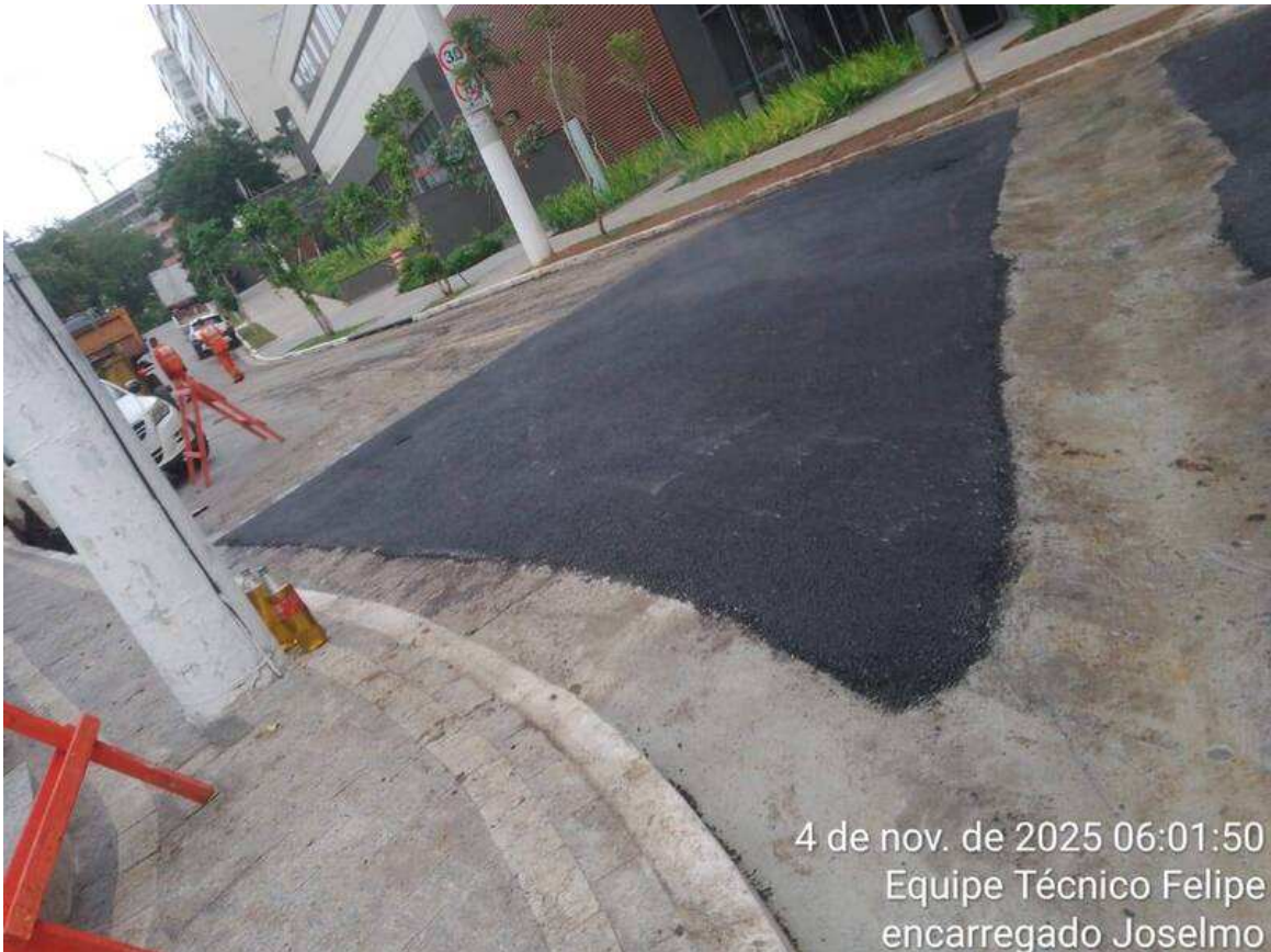
9 | ACABAMENTO → Irregularidade da via após caixa pronta: Item de OS Origem: 14409012 - (Foto Capturada Em: 05/11/25 03:51, Por: mxintadm)
