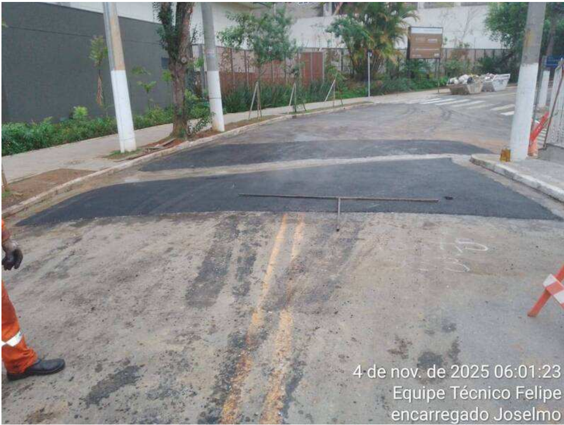
7 | ACABAMENTO → Irregularidade da via após caixa pronta: Item de OS Origem: 14409012 - (Foto Capturada Em: 05/11/25 03:51, Por: mxintadm)
