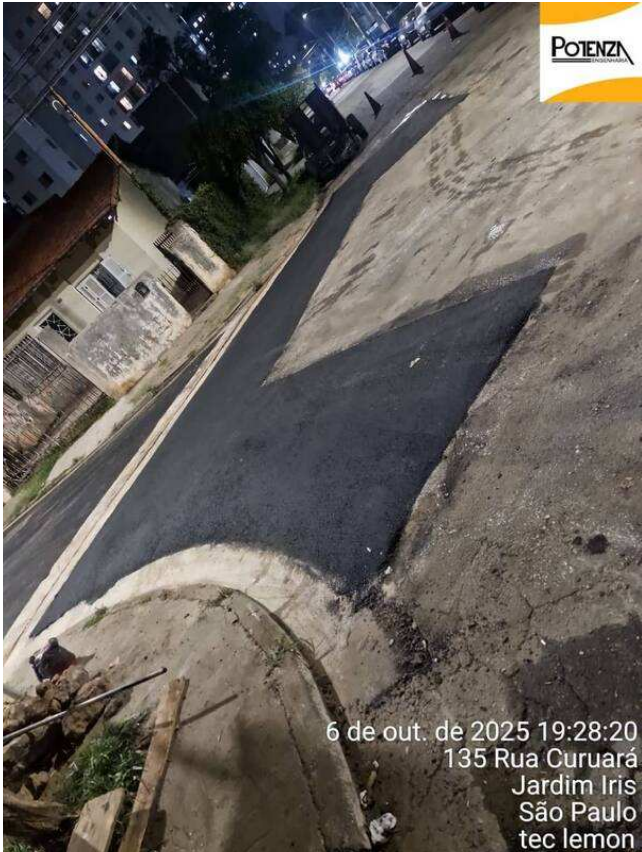
13 | ACABAMENTO → Irregularidade da via após caixa pronta: Item de OS Origem: 14230447 - (Foto Capturada Em: 07/10/25 22:05, Por: mxintadm)
