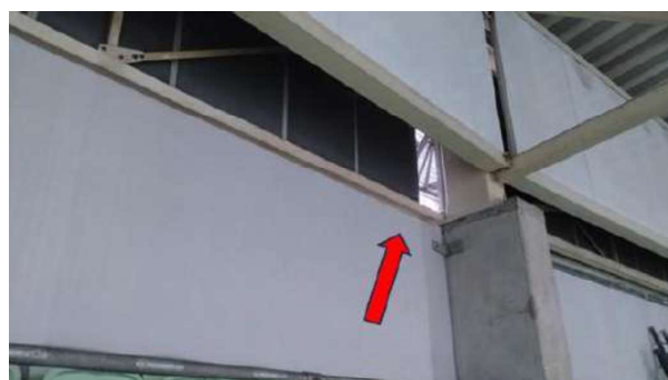
Figura 38 - Falhas de vedação
