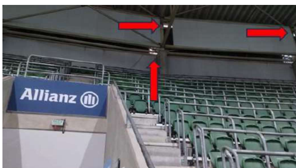
Figura 37 - Falhas de vedação
