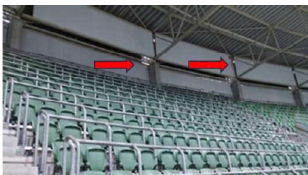
Figura 41 - Falhas de vedação
