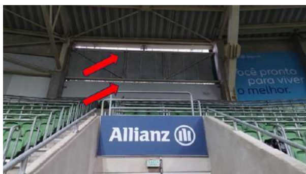
Figura 42 - Falhas de vedação
