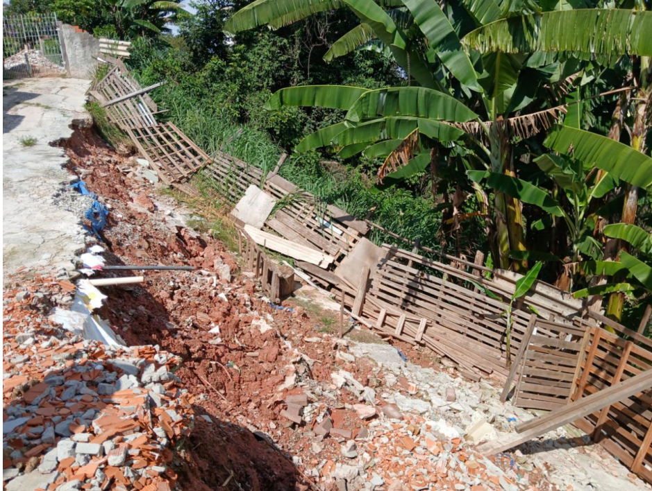
Foto 7: De acordo com relato de moradores houve avanço do deslizamento no dia 10/02/2025. Destacam-se ainda presença de bananeiras no topo do talude.
