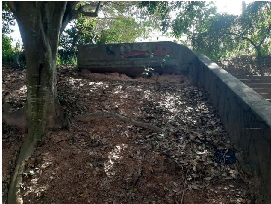
Foto 10: Feições erosivas na base da escadaria que conecta a R. Praça Santo Epifânio com a R. José Piragibe (vista de baixo para cima).
