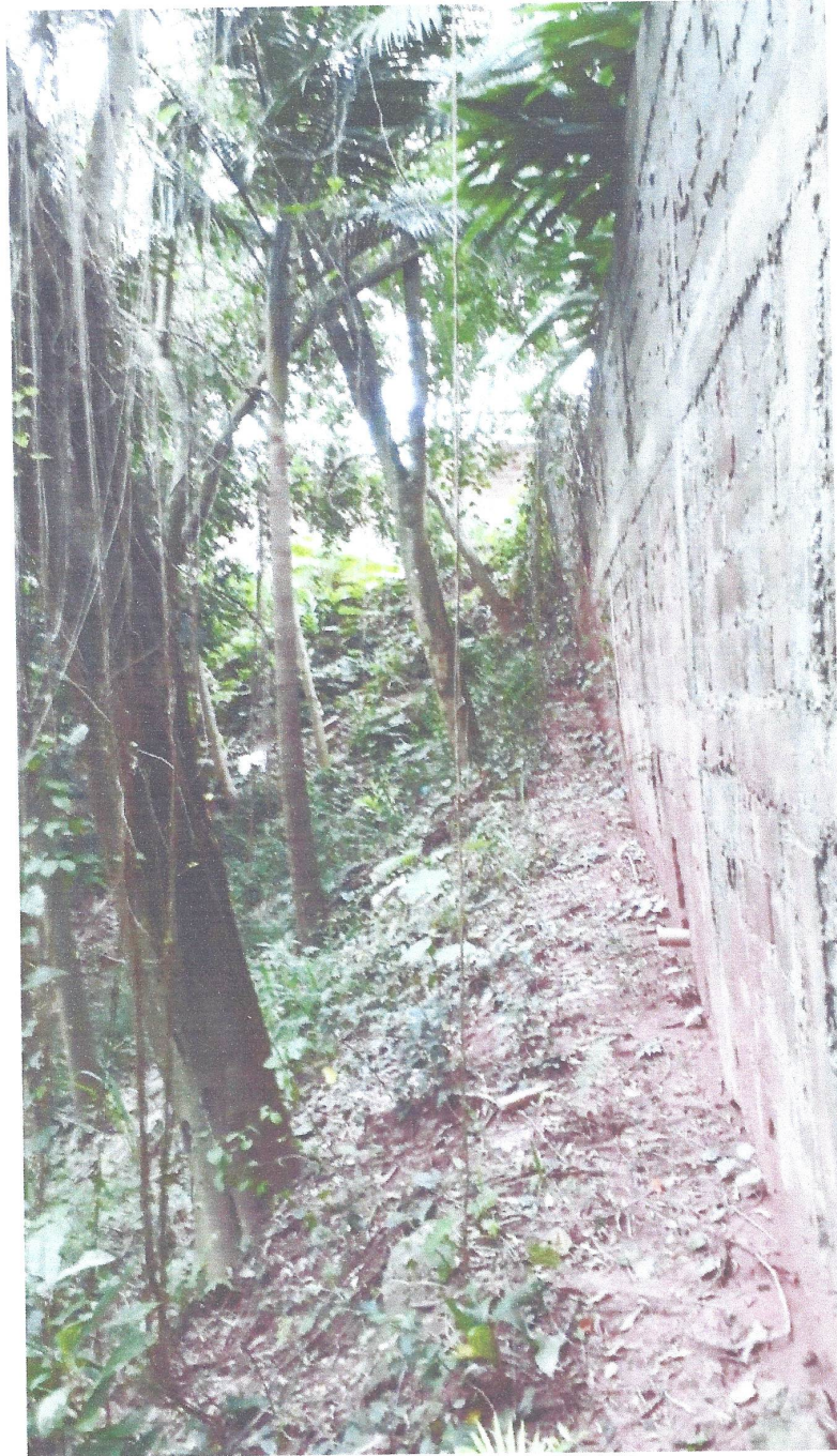
(imagem C) Vista lateral do muro denotando inclinação.
