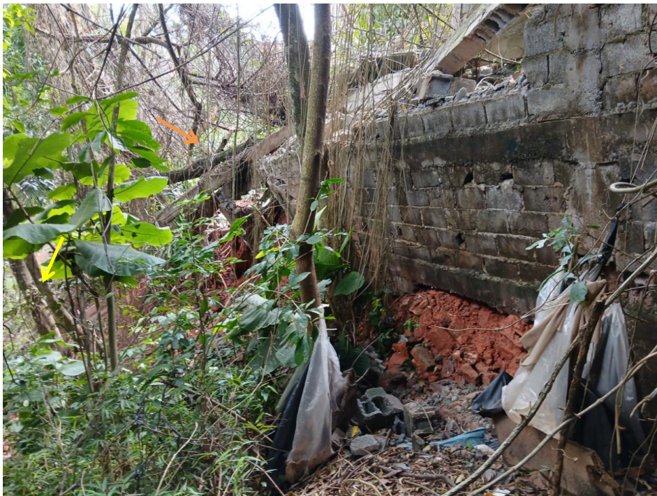
Foto 4: Deslizamento no fundo da moradia situada no topo da encosta, com desabamento de muro. Seta laranja indica árvores caídas. Seta amarela indica exemplos de árvores inclinadas.
