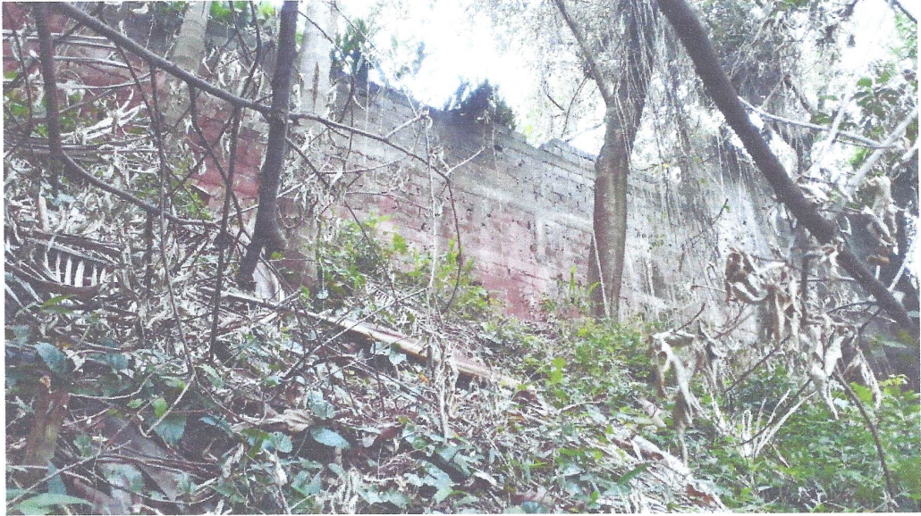
(imagem A) Vista do muro de arrimo com problema de contenção.
