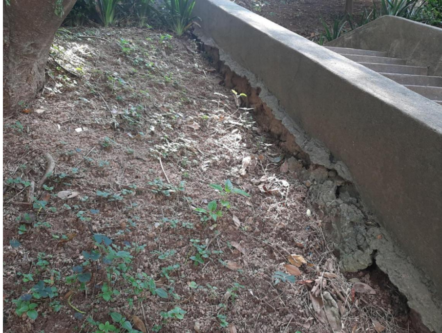
Foto 11: Detalhe de trecho da escadaria em que podem ser observadas feições erosivas na lateral da escadaria da praça.
