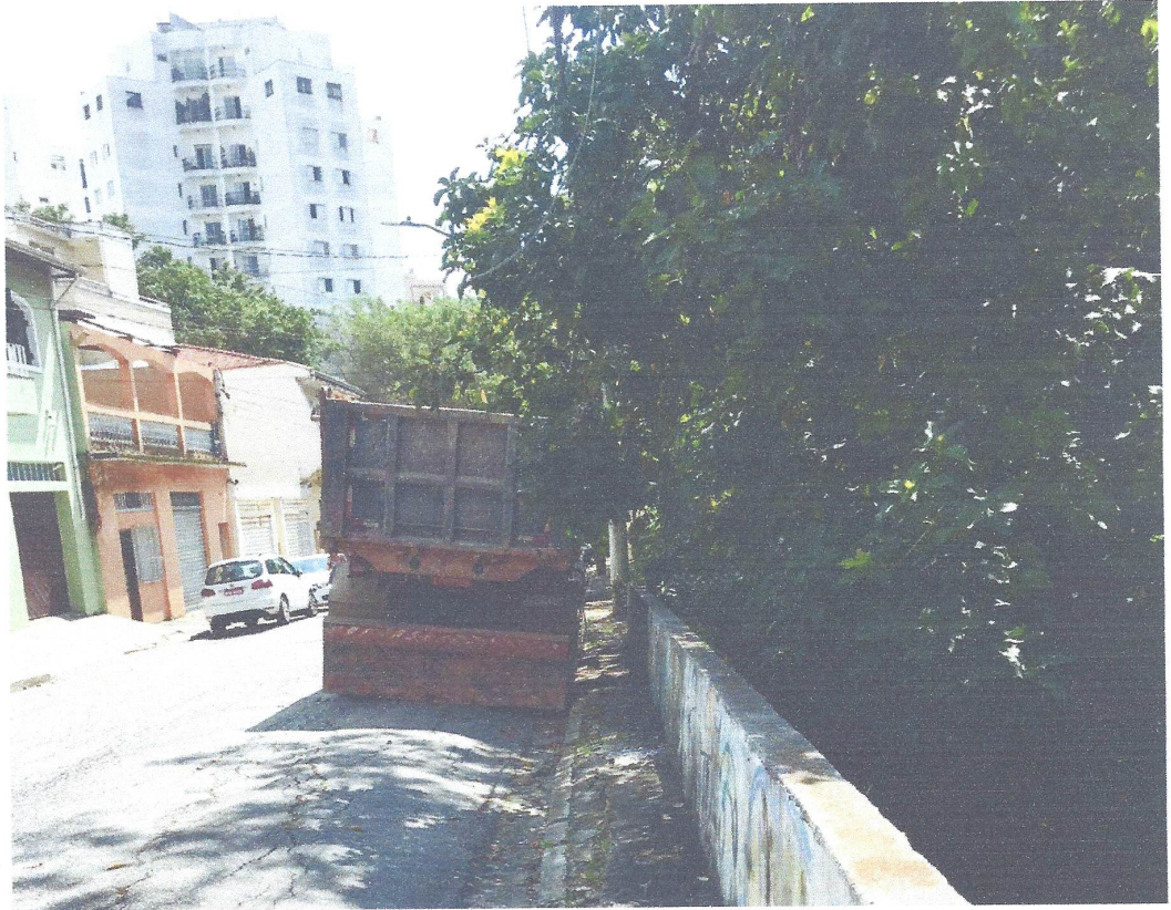
(imagem H) Local de estacionamento de caminhões pesados, tipo basculante onde está ocorrendo o afundamento da via pública e da calçada.
