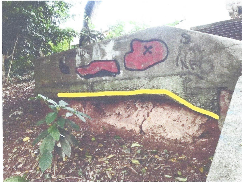
(imagem I) Existem pontos de erosão ao longo de toda a escadaria. A linha amarela mostra o nível do terreno na época de sua construção.
