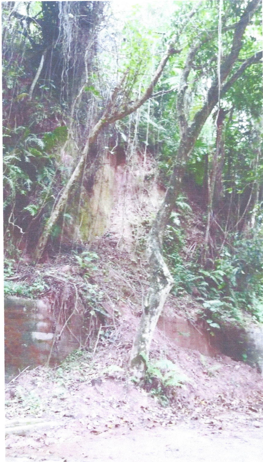
(imagem J) Deslizamento de terra ocorrido no passado junto ao muro de arrimo inferior.
