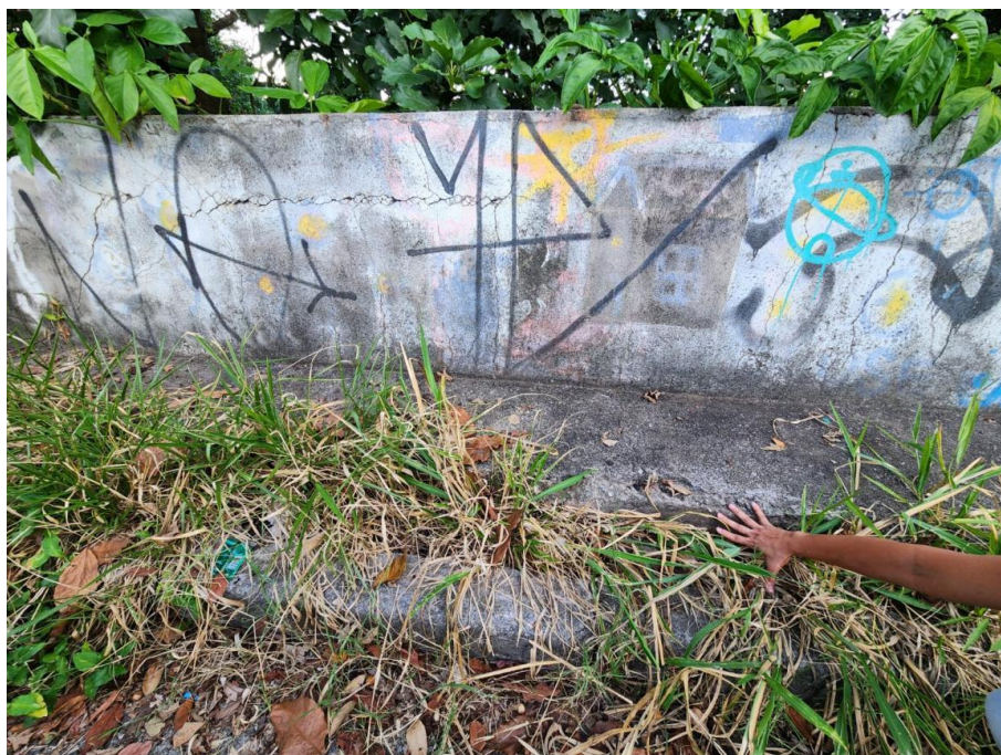
Foto 4: Desnível de aproximadamente 15,0 cm do terreno.
