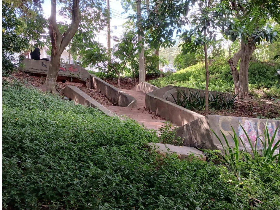
Foto 14: Escadaria que conecta a R. Praça Santo Epifânio com a R. José Piragibe (vista da porção inferior da praça). Destacam-se feições erosivas na lateral e na base da escadaria da praça.
