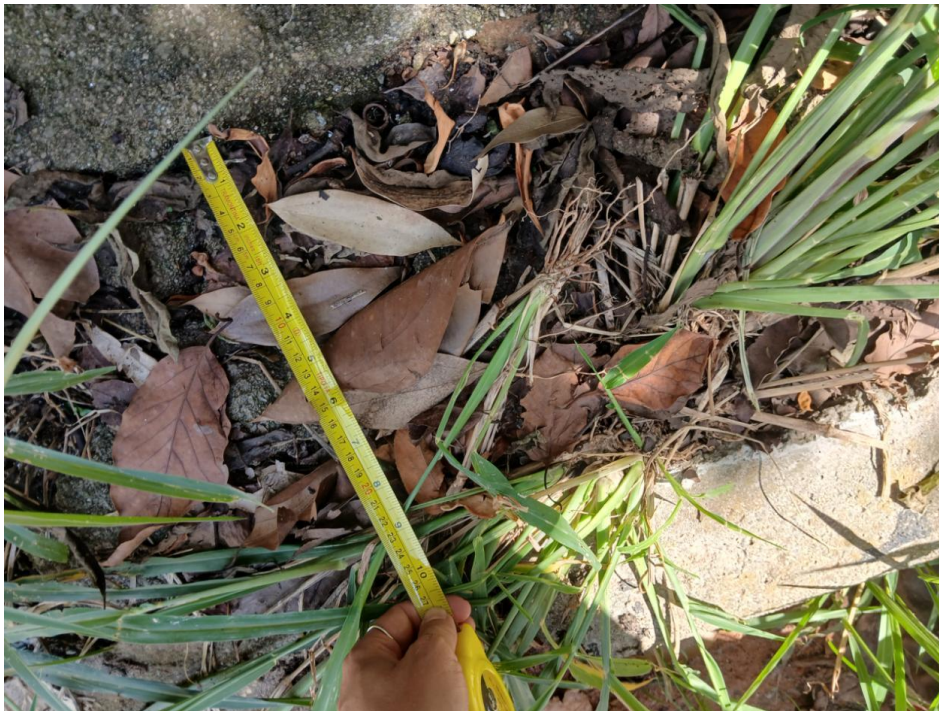
Foto 12: Desnível de aproximadamente 22,0cm do terreno.
