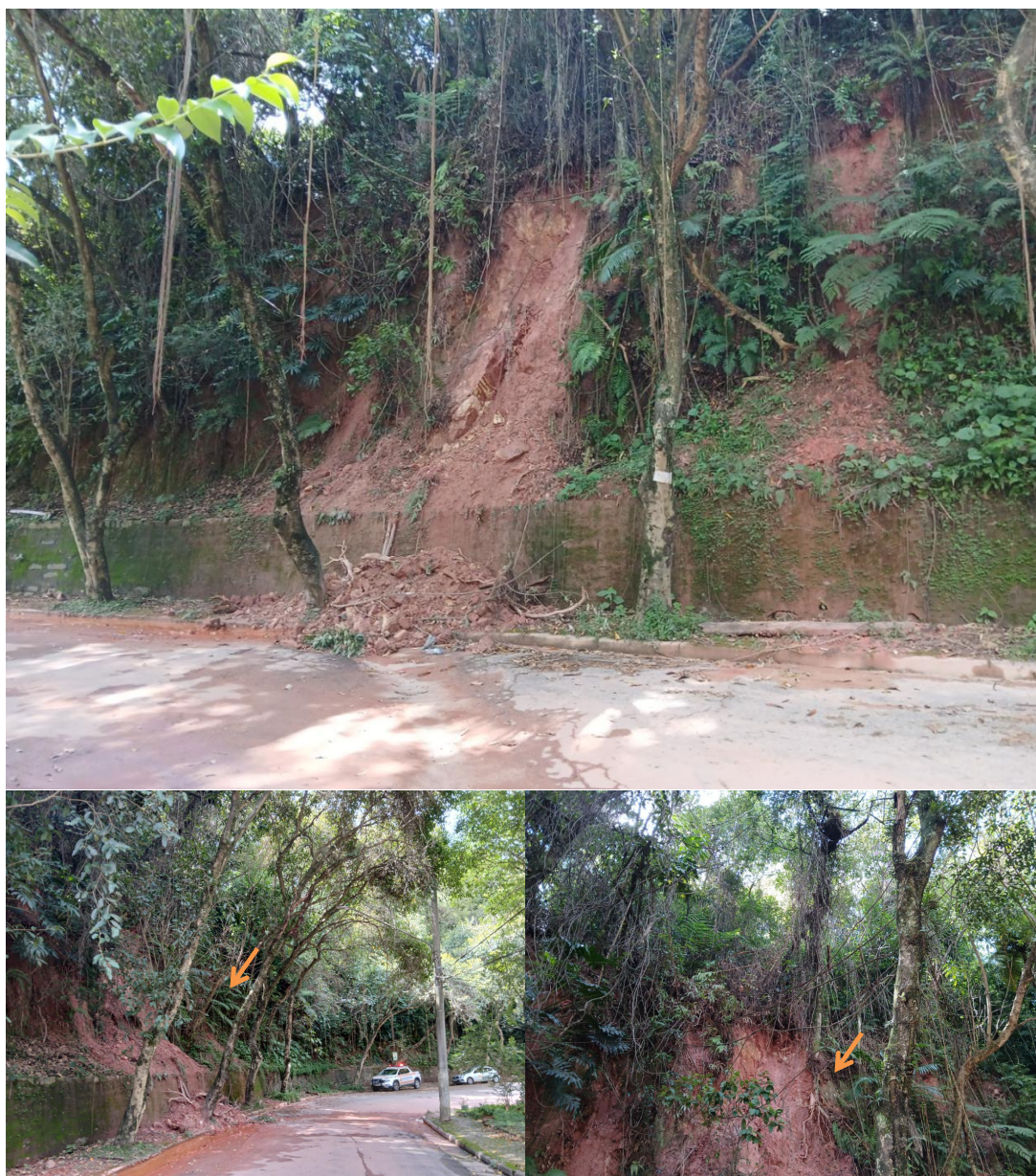
Foto 9: Prancha com registros fotográficos de movimentação do terreno, cicatriz de escorregamento com solo mobilizado na calçada, presença e árvores inclinadas e árvore com raiz exposta.
