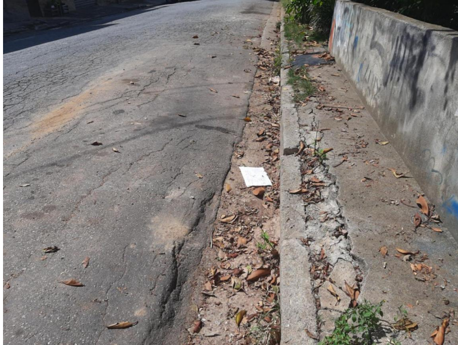
Foto 5: Desnível de aproximadamente 15,0 cm do terreno, trecho com reparos improvisados.
