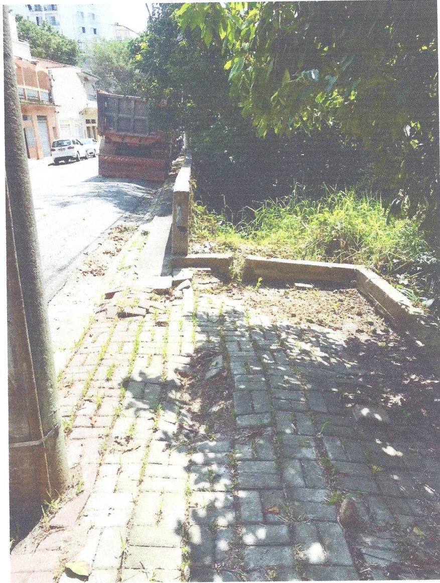
(imagem G) Afundamento da calçada e da via pública na parte superior da Praça Santo Epifânio.
