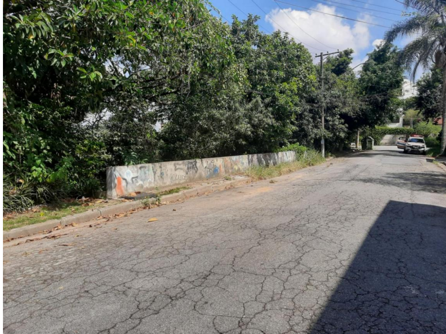
Foto 1: O trecho vistoriado se localiza no topo da Praça Santo Epifânio. Muro de contenção encontra-se abaixo do nível da rua, apresenta aprox. 2,0m de altura e 13,0m de comprimento.
