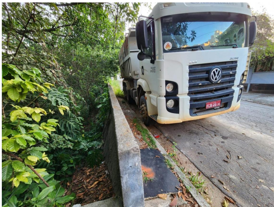
Foto 8: Veículo de grande porte estacionado acima do talude com muro de contenção.
