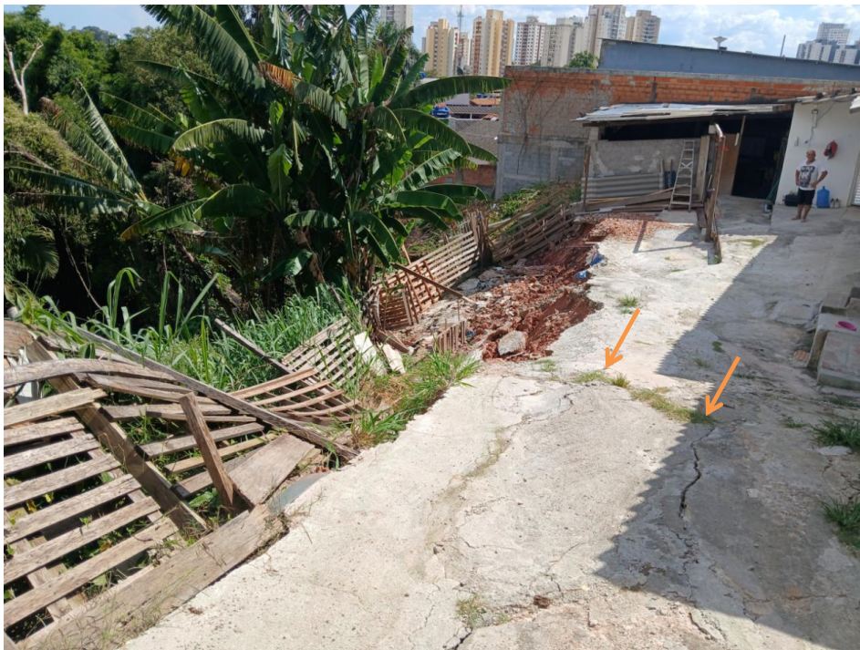
Foto 6: Vista da porção superior da cicatriz de escorregamento. A partir da moradia do topo da encosta. Setas indicam trincas no terreno.
