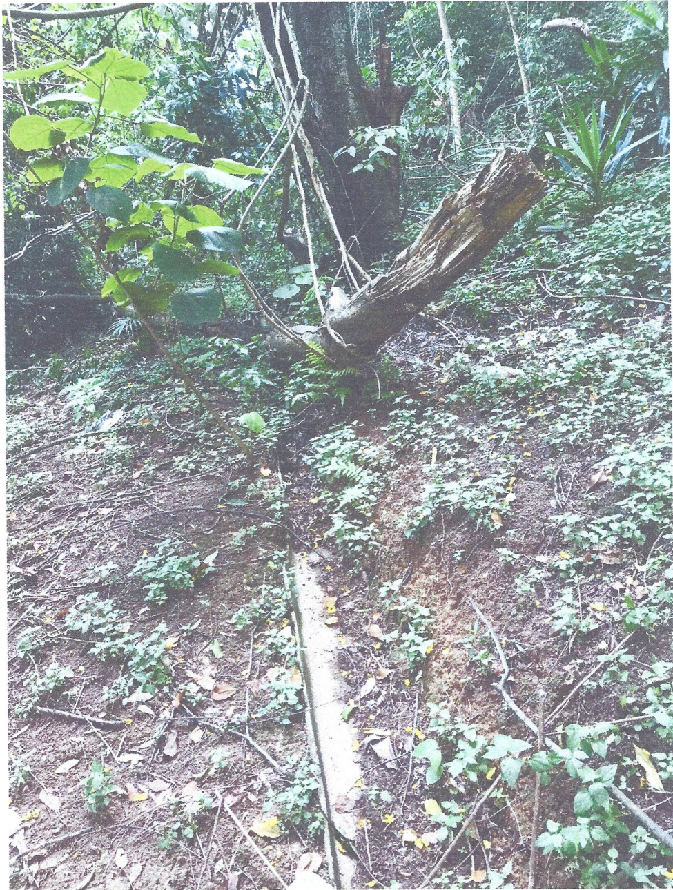
(imagem K) Vista parcial da calha assoreada.
