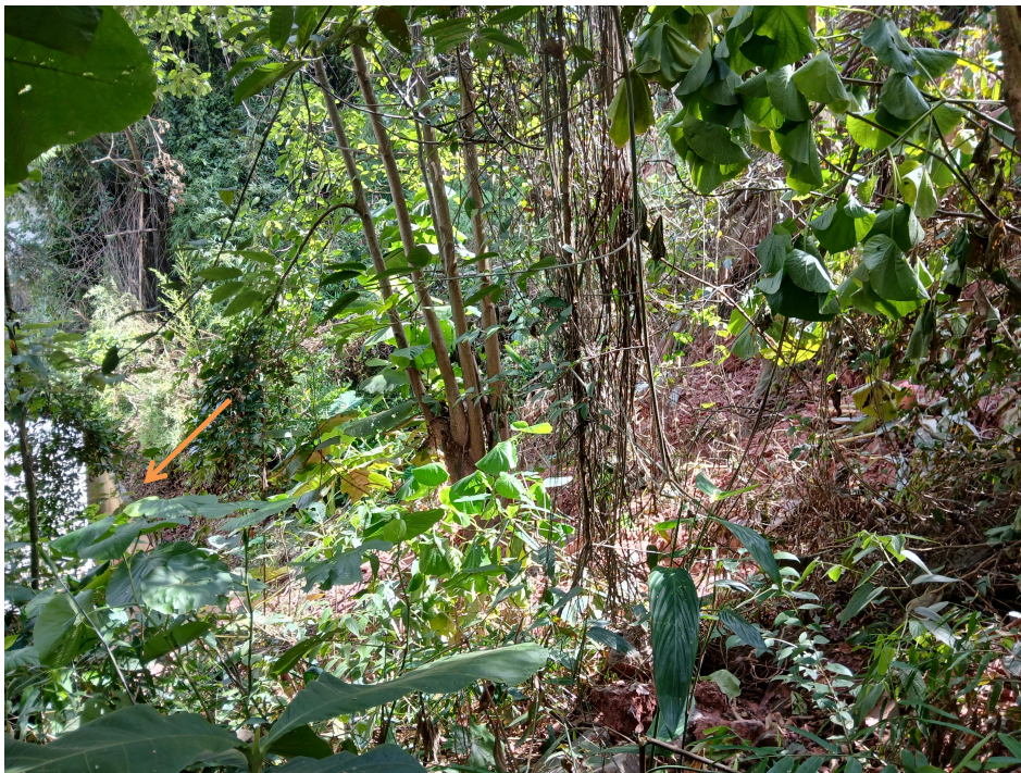
Foto 8: Seta laranja indica muro da moradia localizada na base da encosta, com leve embarrigamento.
