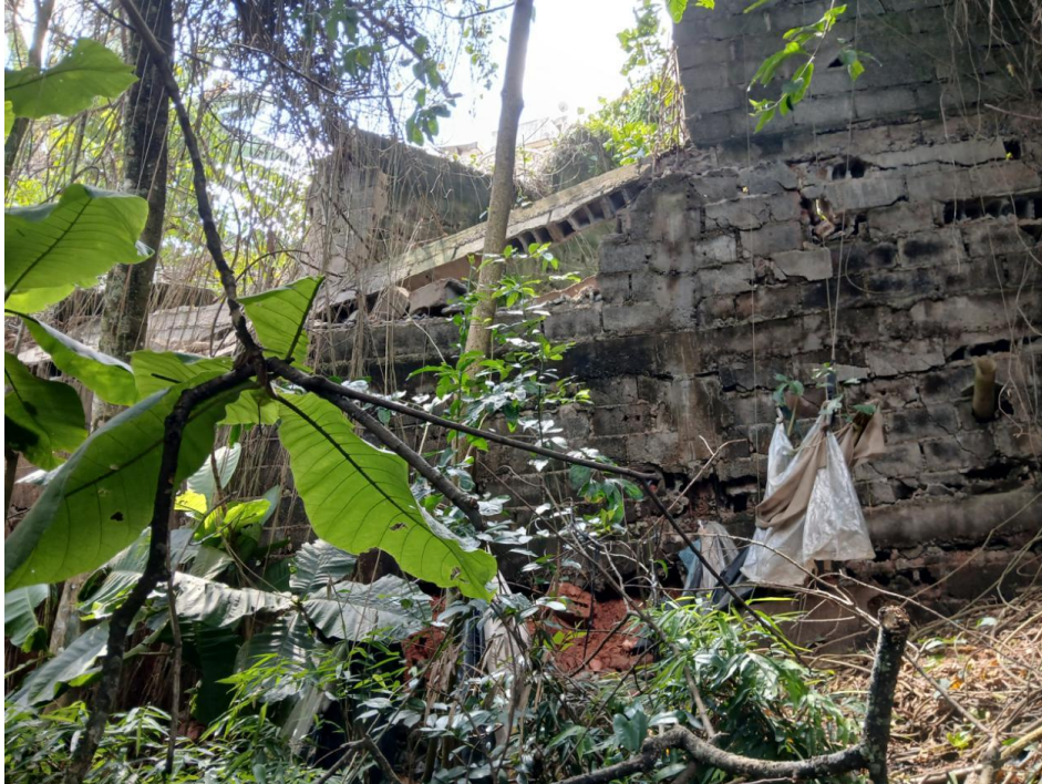
Foto 3: Deslizamento no fundo da moradia localizada no topo da encosta.
