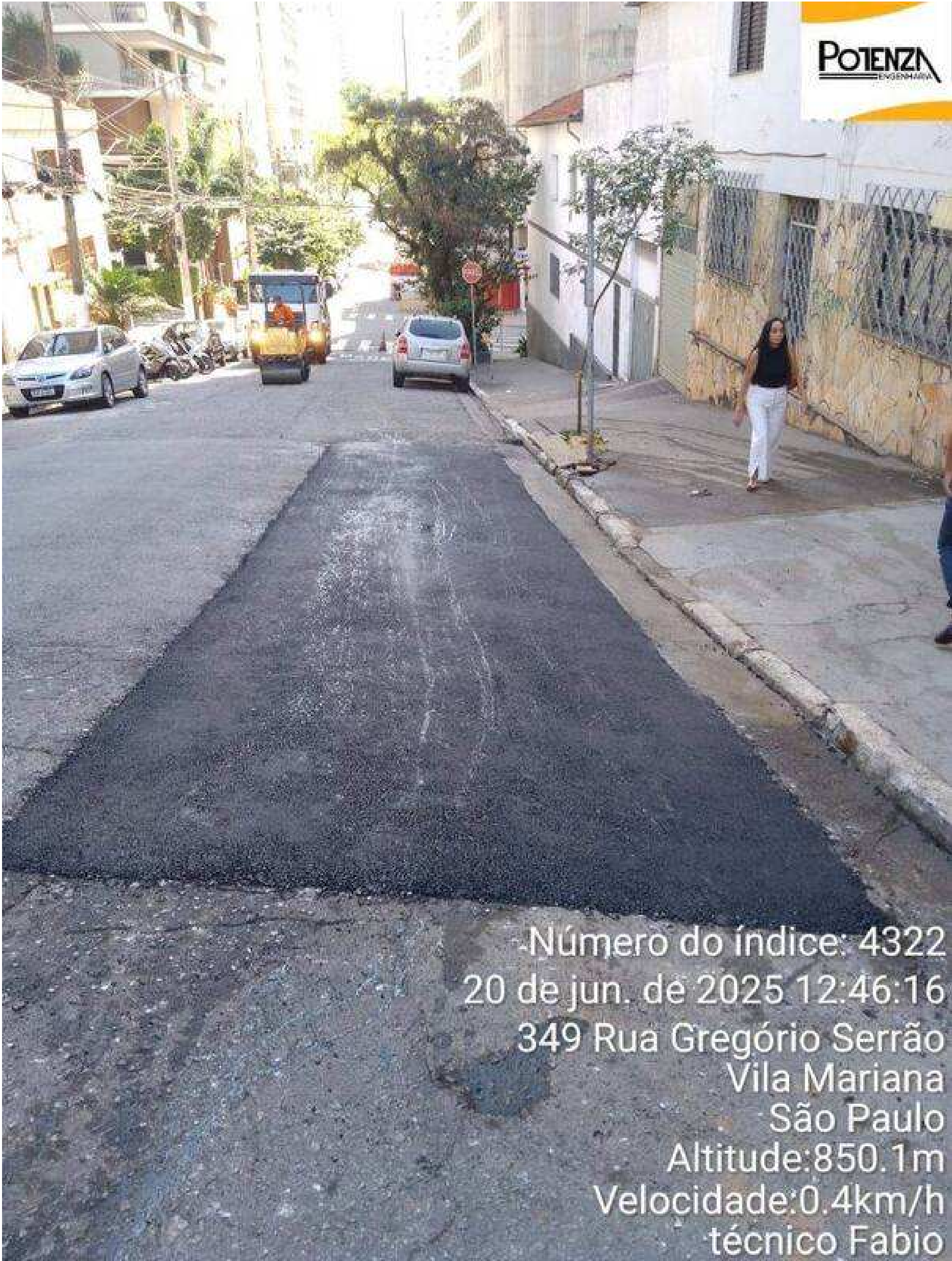
7 | ACABAMENTO → Irregularidade da via após caixa pronta: Item de OS APLICAÇÃO DE MASSA DA CONCORDÂNCIA Origem: 12680291 - (Foto Capturada Em: 24/06/25 03:20, Por: mxintadm)
