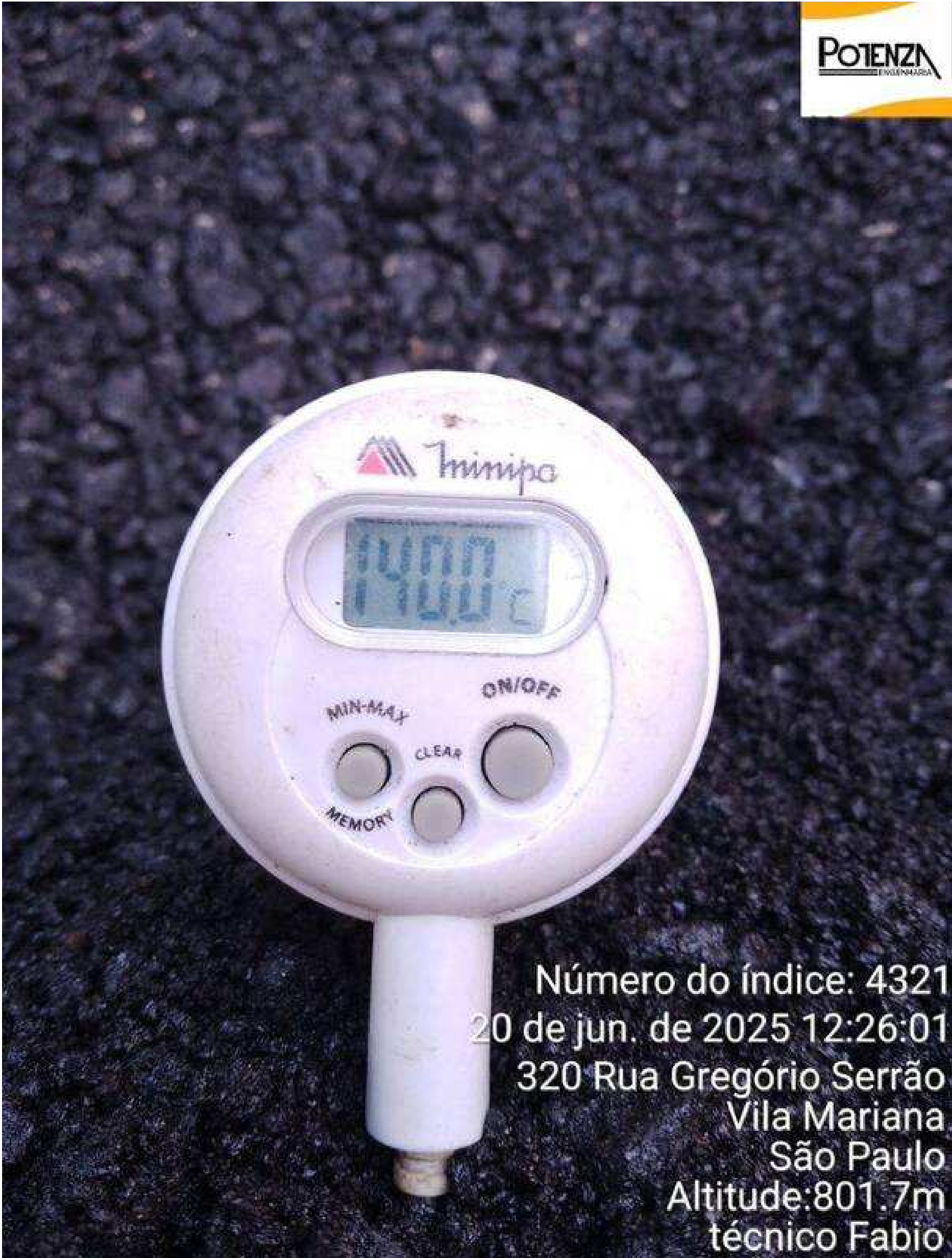
6 | ACABAMENTO → Irregularidade da via após caixa pronta: Item de OS APLICAÇÃO DE MASSA DA CONCORDÂNCIA Origem: 12680291 - (Foto Capturada Em: 24/06/25 03:20, Por: mxintadm)
