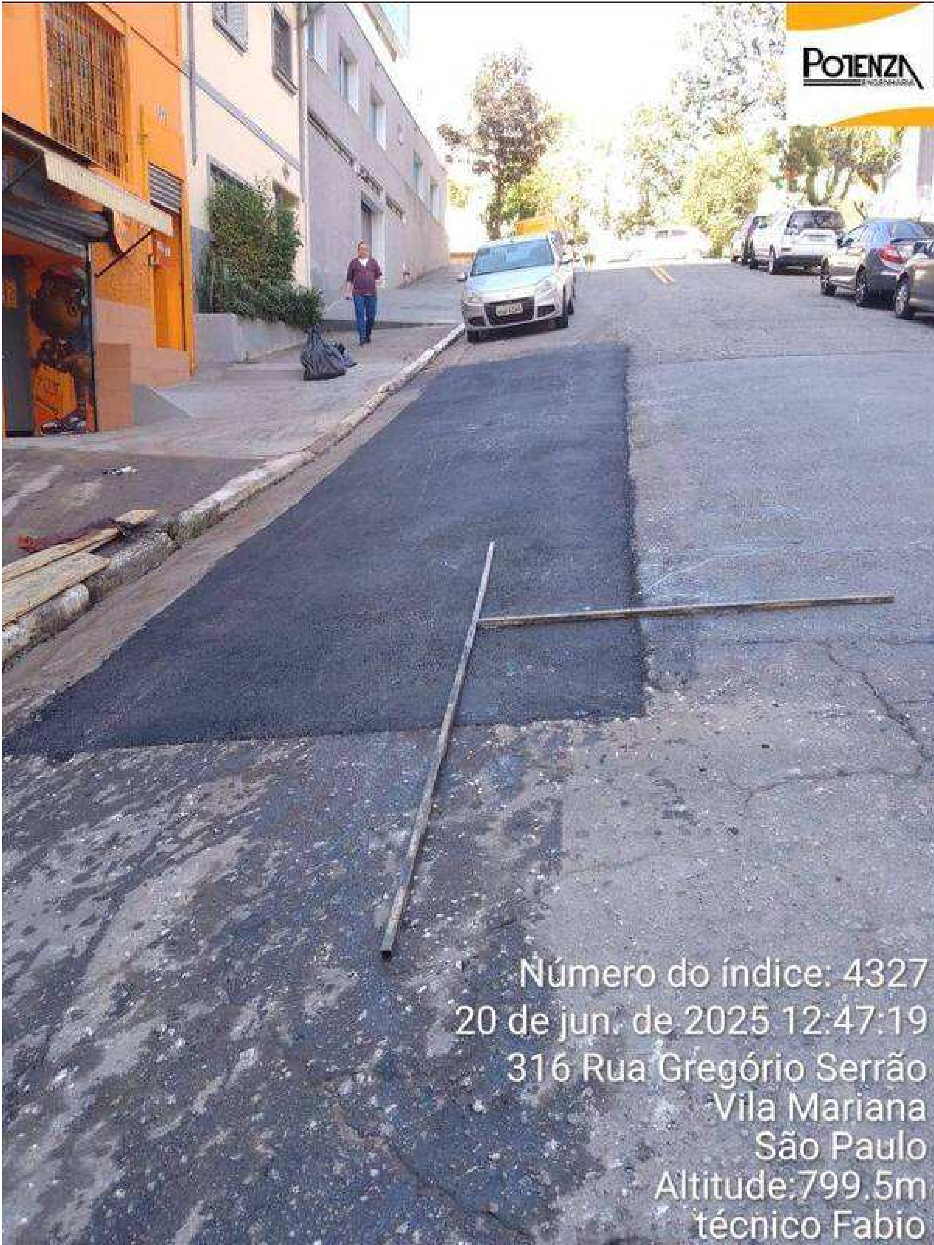
8 | ACABAMENTO → Irregularidade da via após caixa pronta: Item de OS APLICAÇÃO DE MASSA DA CONCORDÂNCIA Origem: 12680291 - (Foto Capturada Em: 24/06/25 03:20, Por: mxintadm)
