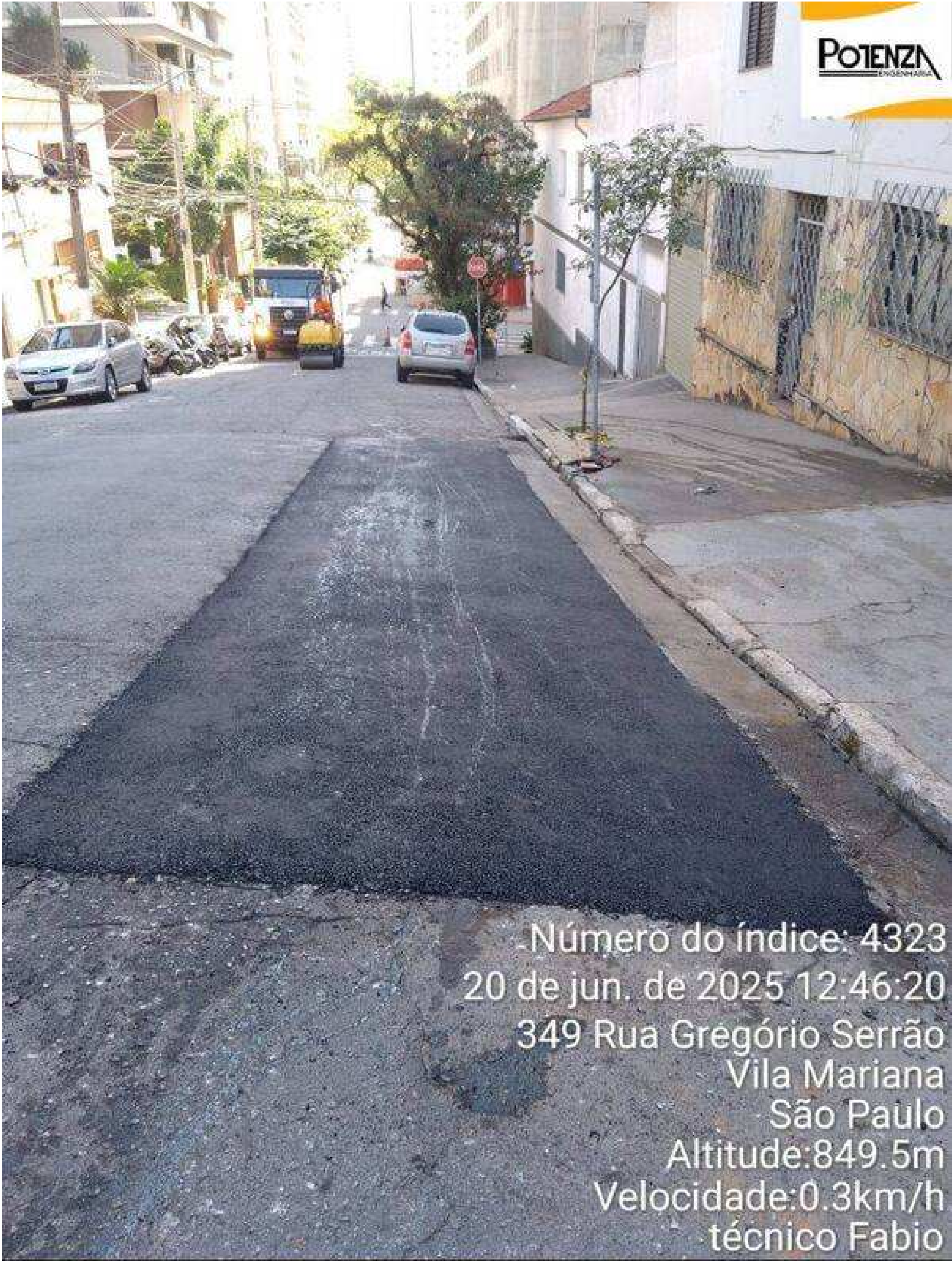
9 | ACABAMENTO → Irregularidade da via após caixa pronta: Item de OS APLICAÇÃO DE MASSA DA CONCORDÂNCIA Origem: 12680291 - (Foto Capturada Em: 24/06/25 03:20, Por: mxintadm)
