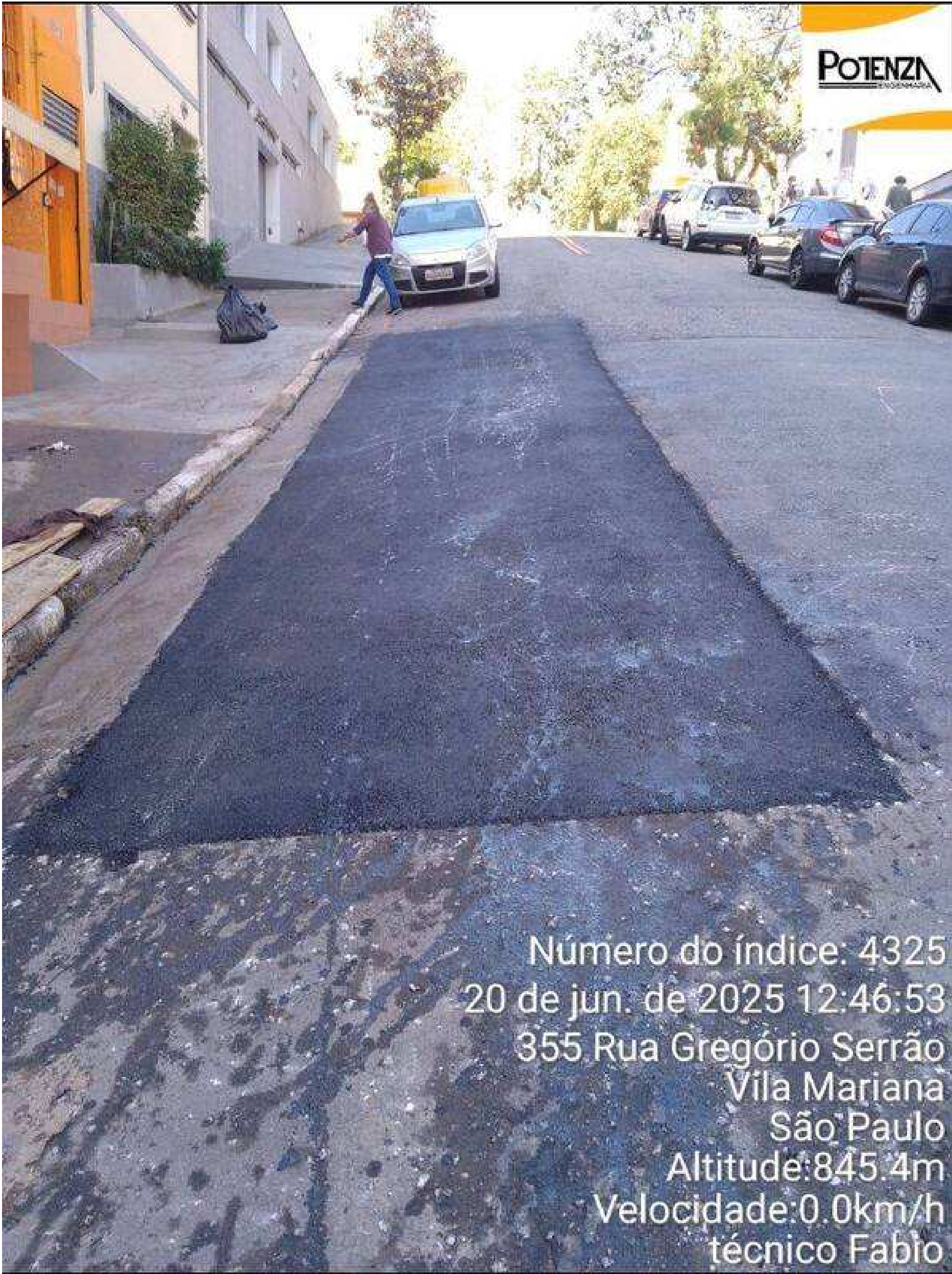
10 | ACABAMENTO → Irregularidade da via após caixa pronta: Item de OS APLICAÇÃO DE MASSA DA CONCORDÂNCIA Origem: 12680291 - (Foto Capturada Em: 24/06/25 03:20, Por: mxintadm)
