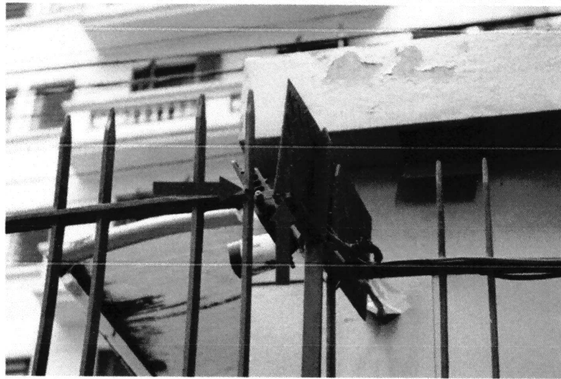
Foto 14 - Ponto de solda rompido com a torção do gradil causada pelas raízes da árvore
