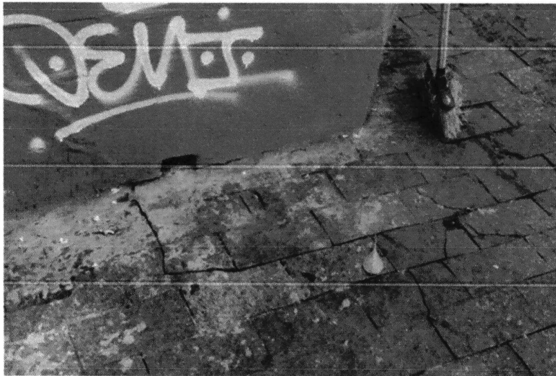
Foto 7 – Fissuras na calçada externa do condomínio devido às raízes da árvore
