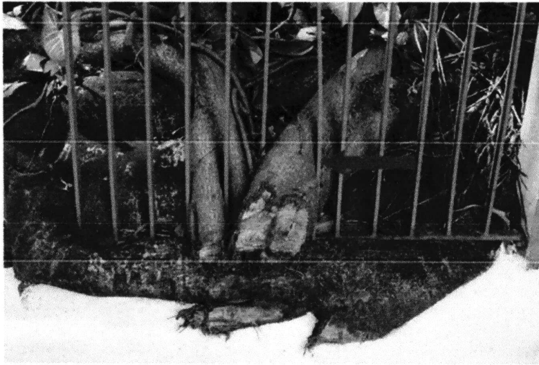
Foto 12 = Raízes da árvore causando abertura entre as barras do gradil do condomínio
