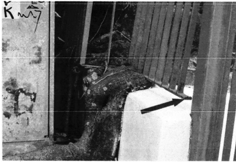
Foto 10 – Raízes da árvore causando torção e rompimento da solda do gradil do condomínio
