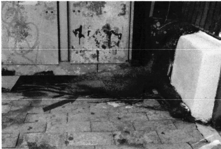
Foto 9 – Raízes da árvore penetrando sob loja de comércio na calçada
