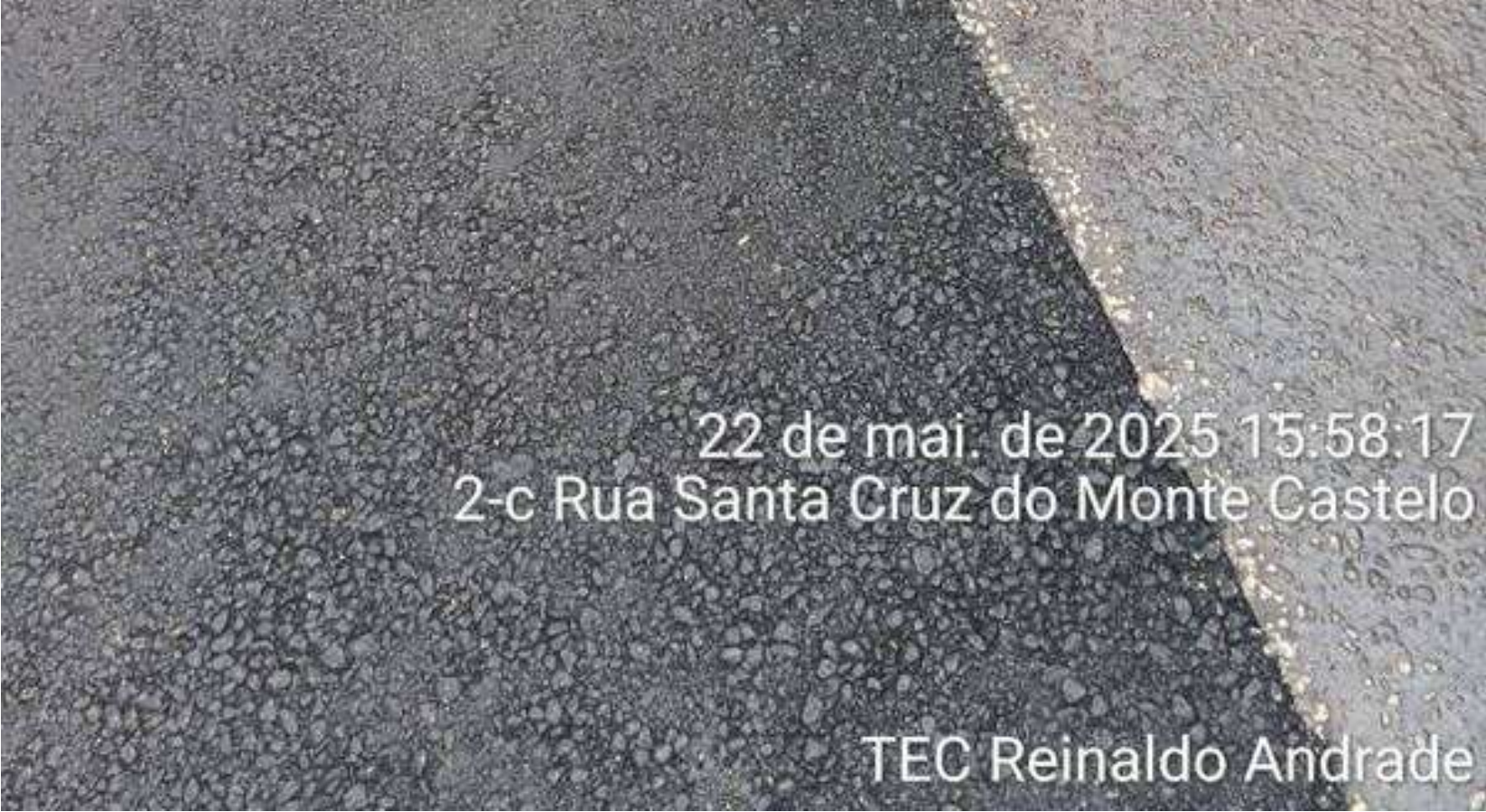
11 | ACABAMENTO → Irregularidade da via após caixa pronta: Item de OS Origem: 12284857 - (Foto Capturada Em: 23/05/25 23:56, Por: mxintadm)
