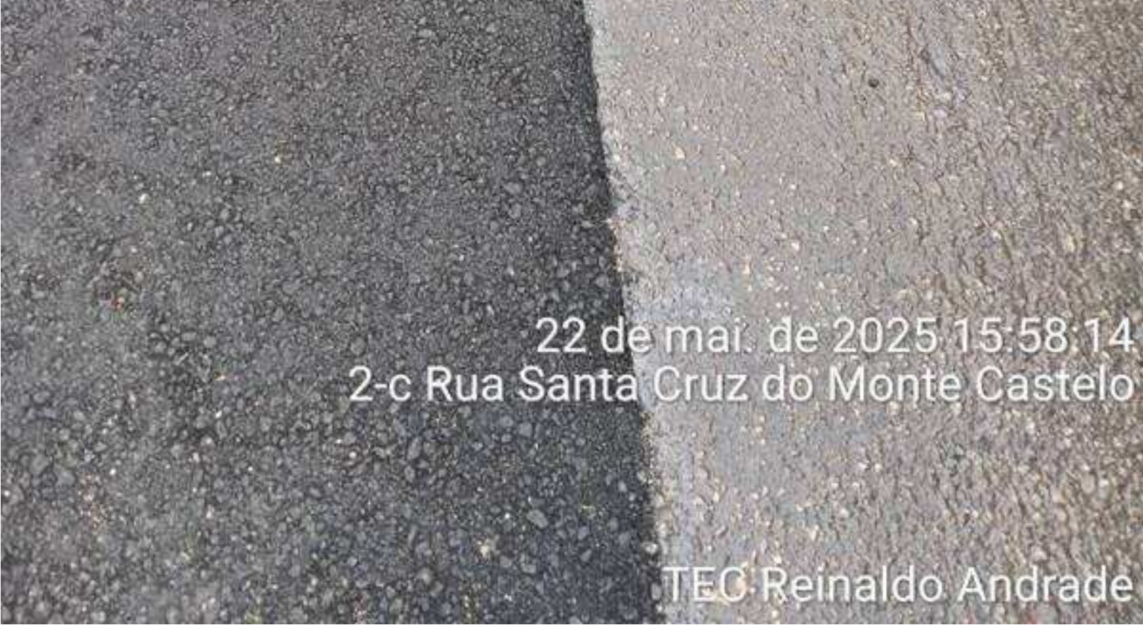
9 | ACABAMENTO → Irregularidade da via após caixa pronta: Item de OS Origem: 12284857 - (Foto Capturada Em: 23/05/25 23:56, Por: mxintadm)
