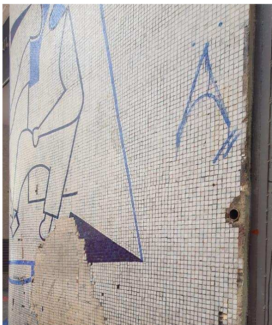
Figura 14. Peças quebradas, pichação em azul e sujidades generalizadas. Foto: Ana Carolina Modinger, 19/03/2025. Fonte: Acervo DPH/NMOA.
