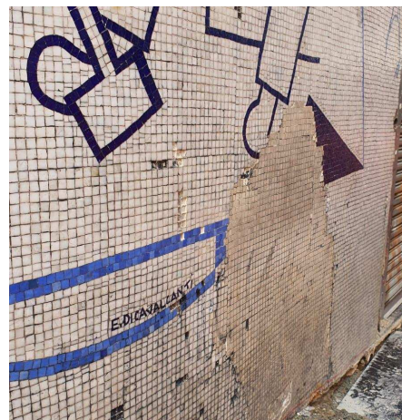
Foto 13: Manchas de pichação. Pastilhas faltantes, quebradas e trincadas. Foto: Ana Carolina Modinger, 19/03/2025. Fonte: Acervo DPH/NMOA.
