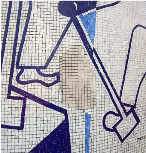
Figura 10. Primeiro trecho da intervenção malsucedida, em que é possível notar a clara diferença de tons e a desconsideração em relação ao traçado das figuras que compõem o painel. Foto: Eloá Cristine Costa da Silva, 19/03/2025. Fonte: Acervo DPH/NMOA.
