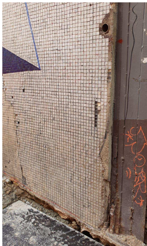
Figura 15. Pastilhas faltantes, quebradas e trincadas. Foto: Ana Carolina Modinger, 19/03/2025. Fonte: Acervo DPH/NMOA.
