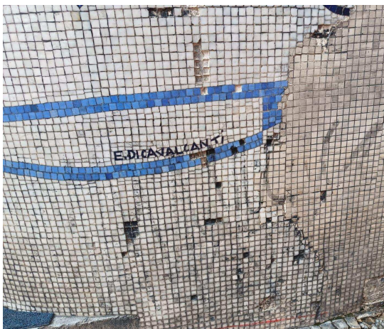
Figura 12. Peças faltantes, quebradas e trincadas. Sujidade e manchas remanescentes de pichação. Foto: Eloá Cristine Costa da Silva, 19/03/2025. Fonte: Acervo DPH/NMOA.
