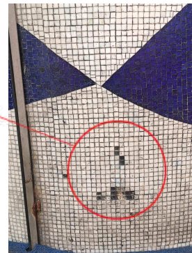
Figuras 06, 07 e 08. Danos ampliados referente a área do painel visualizado na figura 04. Nota-se pastilhas faltantes e presença de sujidades. Fotos: Eloá Cristine Costa da Silva, 19/03/2025. Fonte: Acervo DPH/NMOA.
