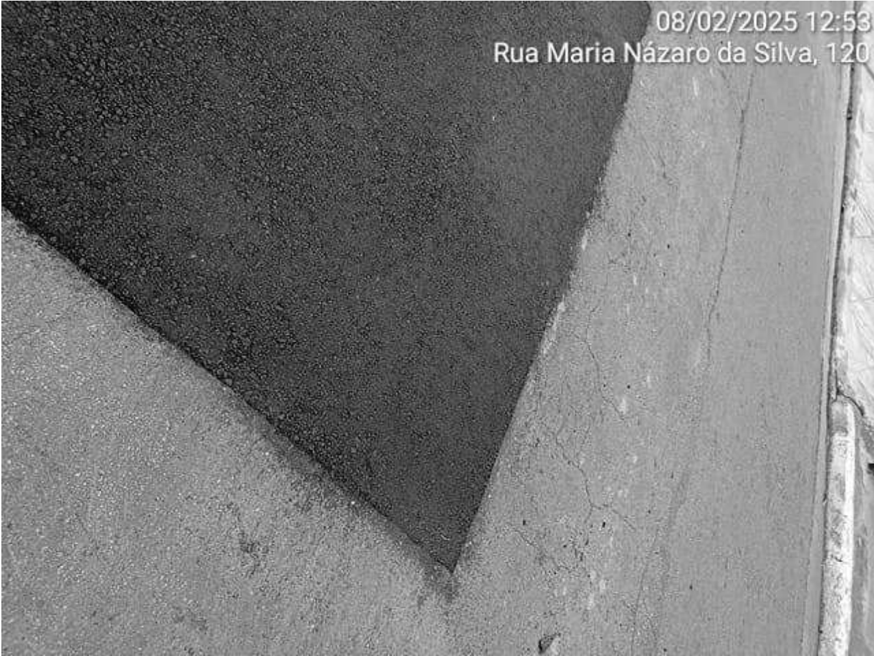
8 | ACABAMENTO → Irregularidade da via após caixa pronta: Item de OS Origem: 11195497 - (Foto Capturada Em: 09/02/25 21:51, Por: mxintadm)
