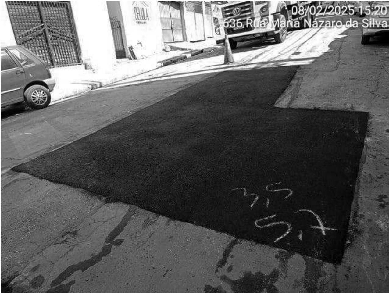
4 | ACABAMENTO → Irregularidade da via após caixa pronta: Item de OS Origem: 11201798 - (Foto Capturada Em: 10/02/25 22:32, Por: mxintadm)
