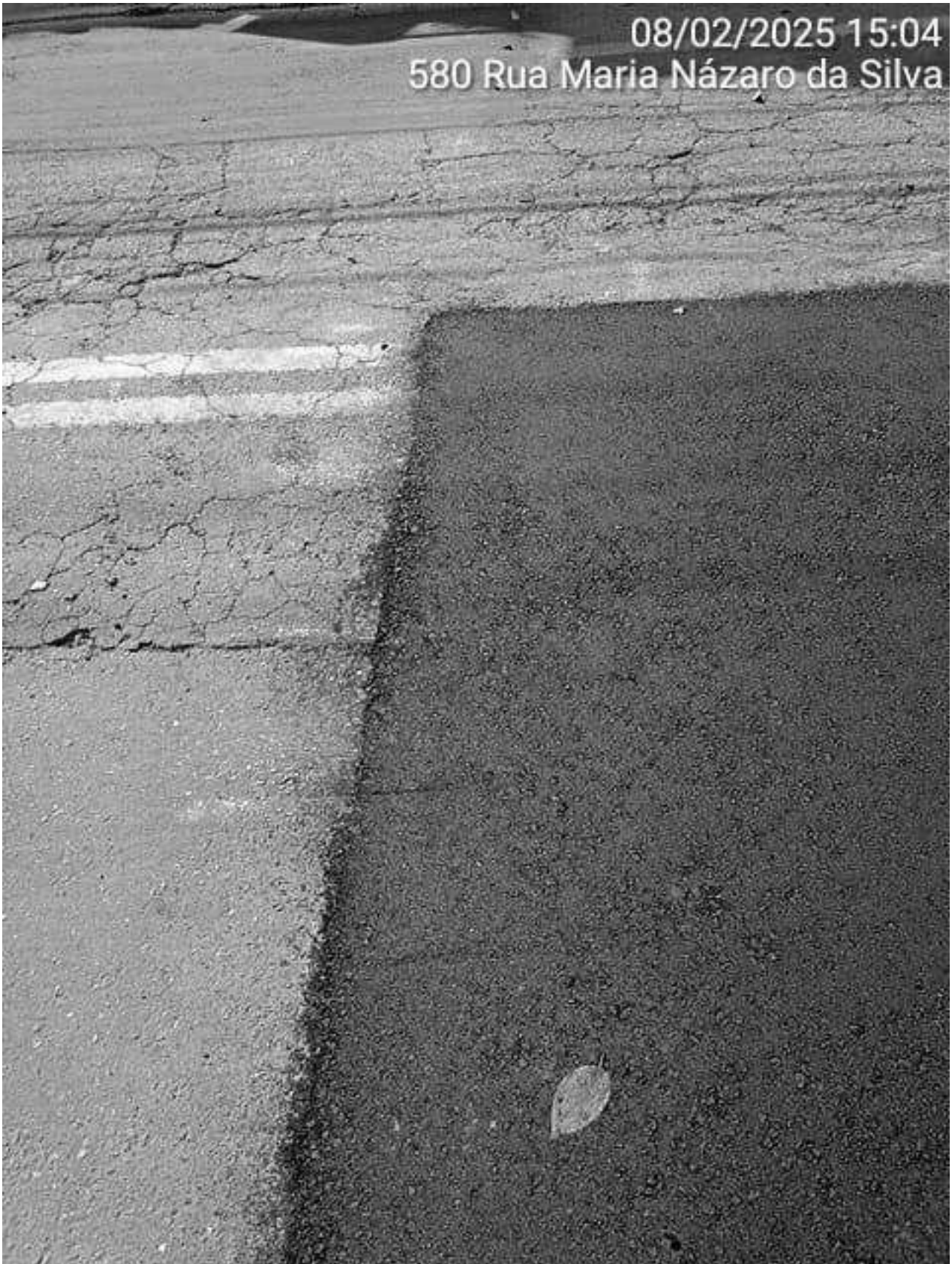
8 | ACABAMENTO → Irregularidade da via após caixa pronta: Item de OS Origem: 11201836 - (Foto Capturada Em: 10/02/25 22:27, Por: mxintadm)
