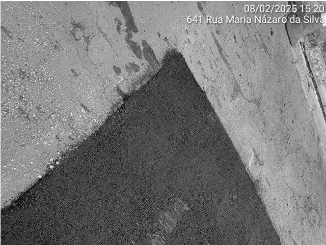
10 | ACABAMENTO → Irregularidade da via após caixa pronta: Item de OS Origem: 11201800 - (Foto Capturada Em: 10/02/25 22:30, Por: mxintadm)
