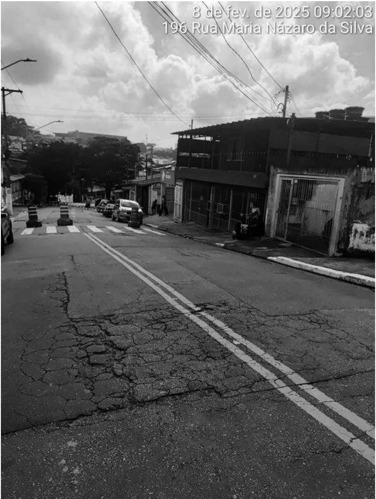
2 | Demarcação da caixa: Item de OS Origem: 11201837 - (Foto Capturada Em: 08/02/25 09:03, Por: mxintadm)
