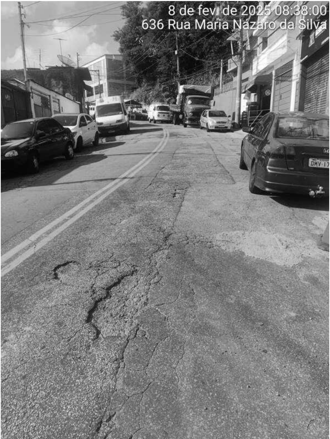
2 | Demarcação da caixa: Item de OS Origem: 11201797 - (Foto Capturada Em: 08/02/25 08:39, Por: mxintadm)
