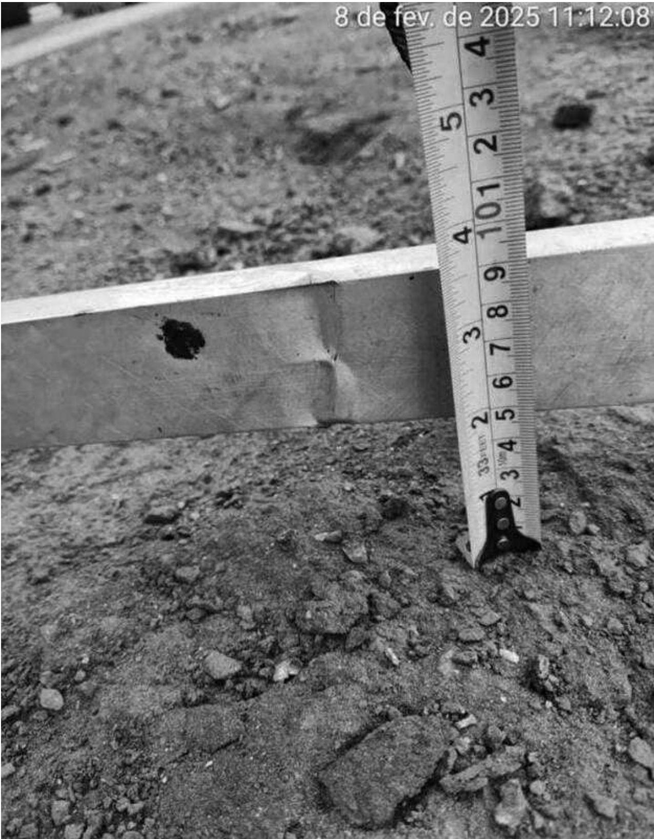
12 | PROFUNDIDADE → Registro da profundidade mais rasa da caixa com uso da trena: Item de OS Origem: 11201836 - (Foto Capturada Em: 10/02/25 22:28, Por: mxintadm)
