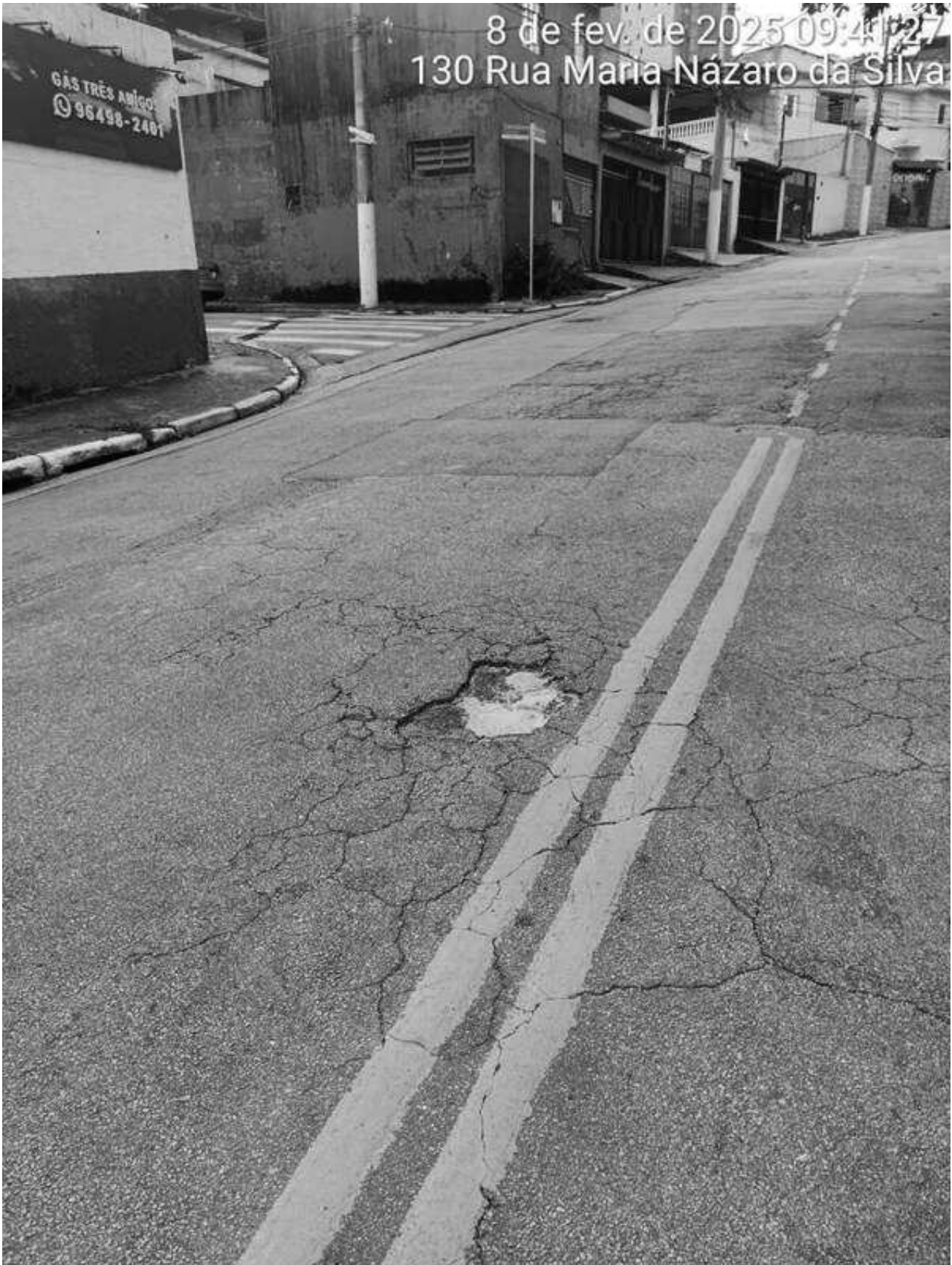
2 | Demarcação da caixa: Item de OS Origem: 11195496 - (Foto Capturada Em: 08/02/25 09:42, Por: mxintadm)
