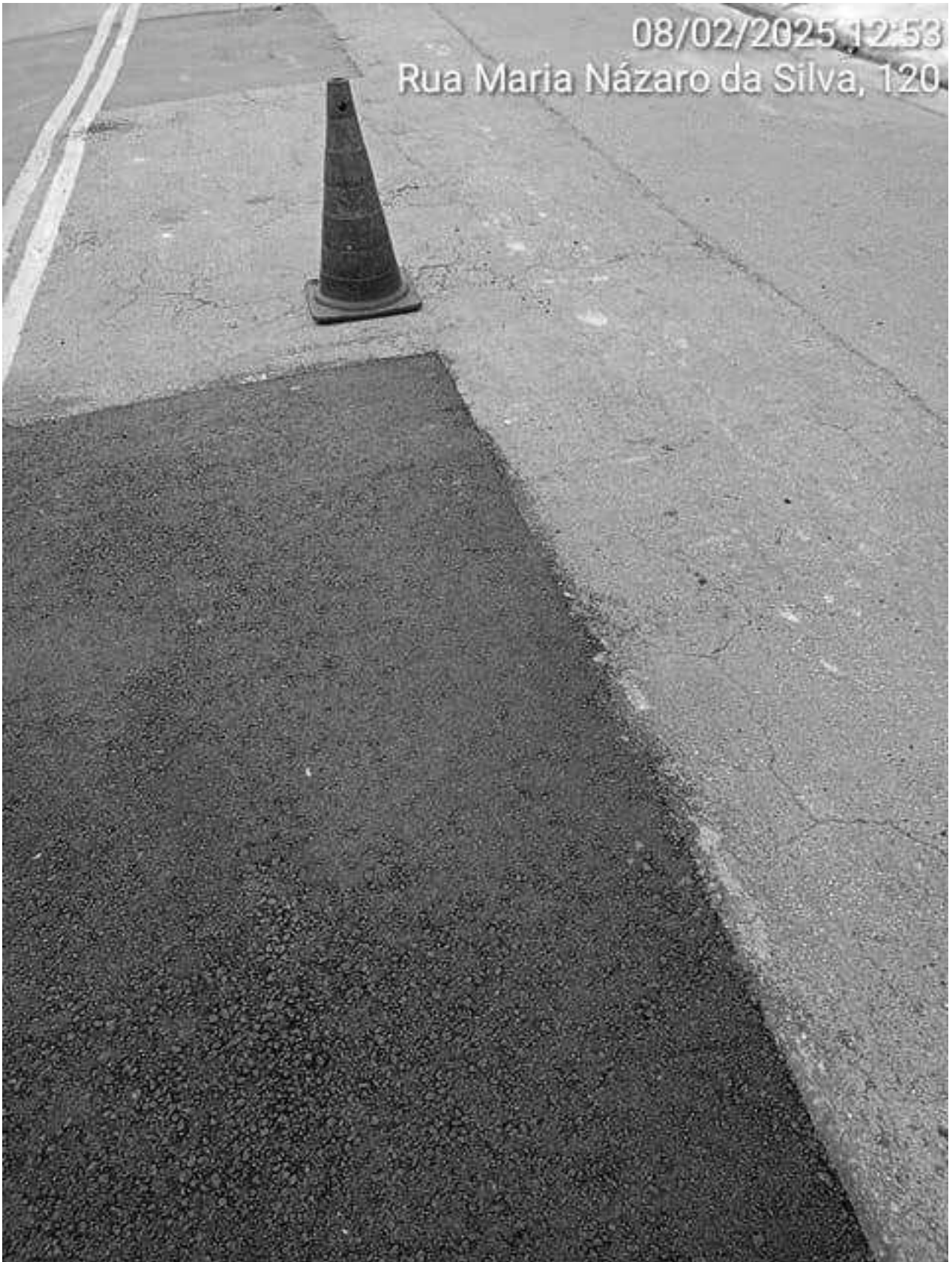
7 | ACABAMENTO → Irregularidade da via após caixa pronta: Item de OS Origem: 11195497 - (Foto Capturada Em: 09/02/25 21:50, Por: mxintadm)
