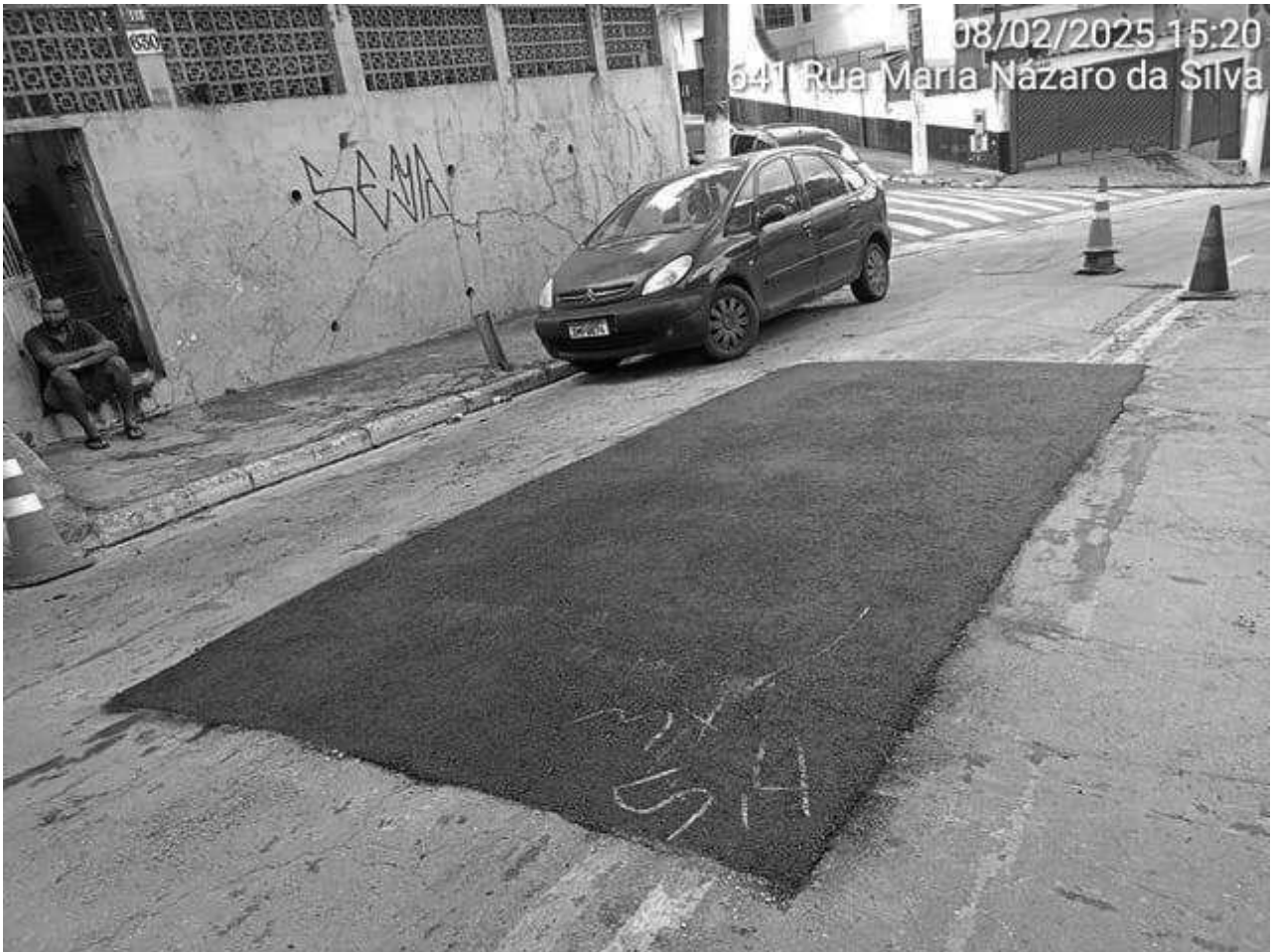
6 | ACABAMENTO → Irregularidade da via após caixa pronta: Item de OS Origem: 11201800 - (Foto Capturada Em: 10/02/25 22:30, Por: mxintadm)
