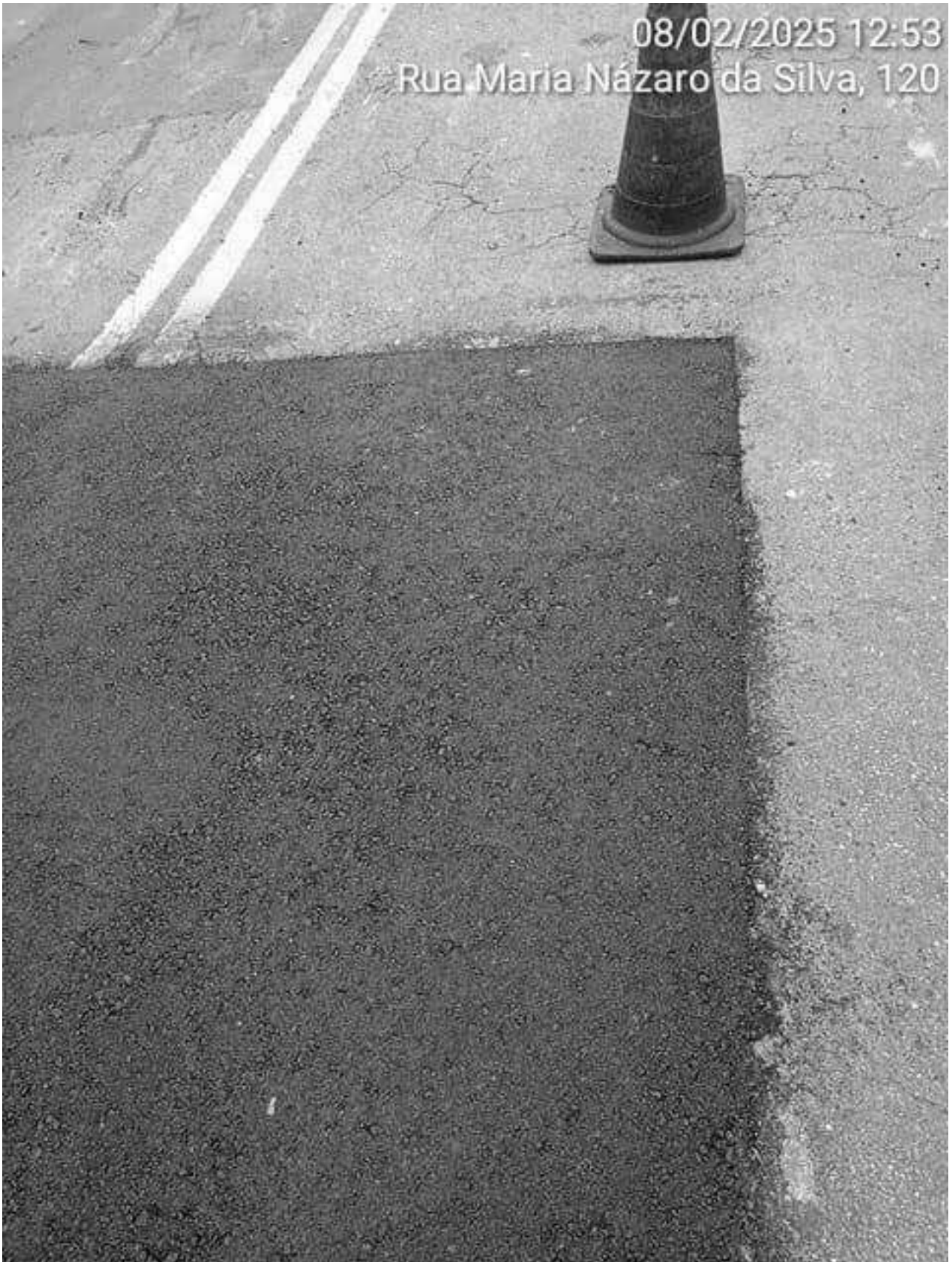
6 | ACABAMENTO → Irregularidade da via após caixa pronta: Item de OS Origem: 11195497 - (Foto Capturada Em: 09/02/25 21:50, Por: mxintadm)
