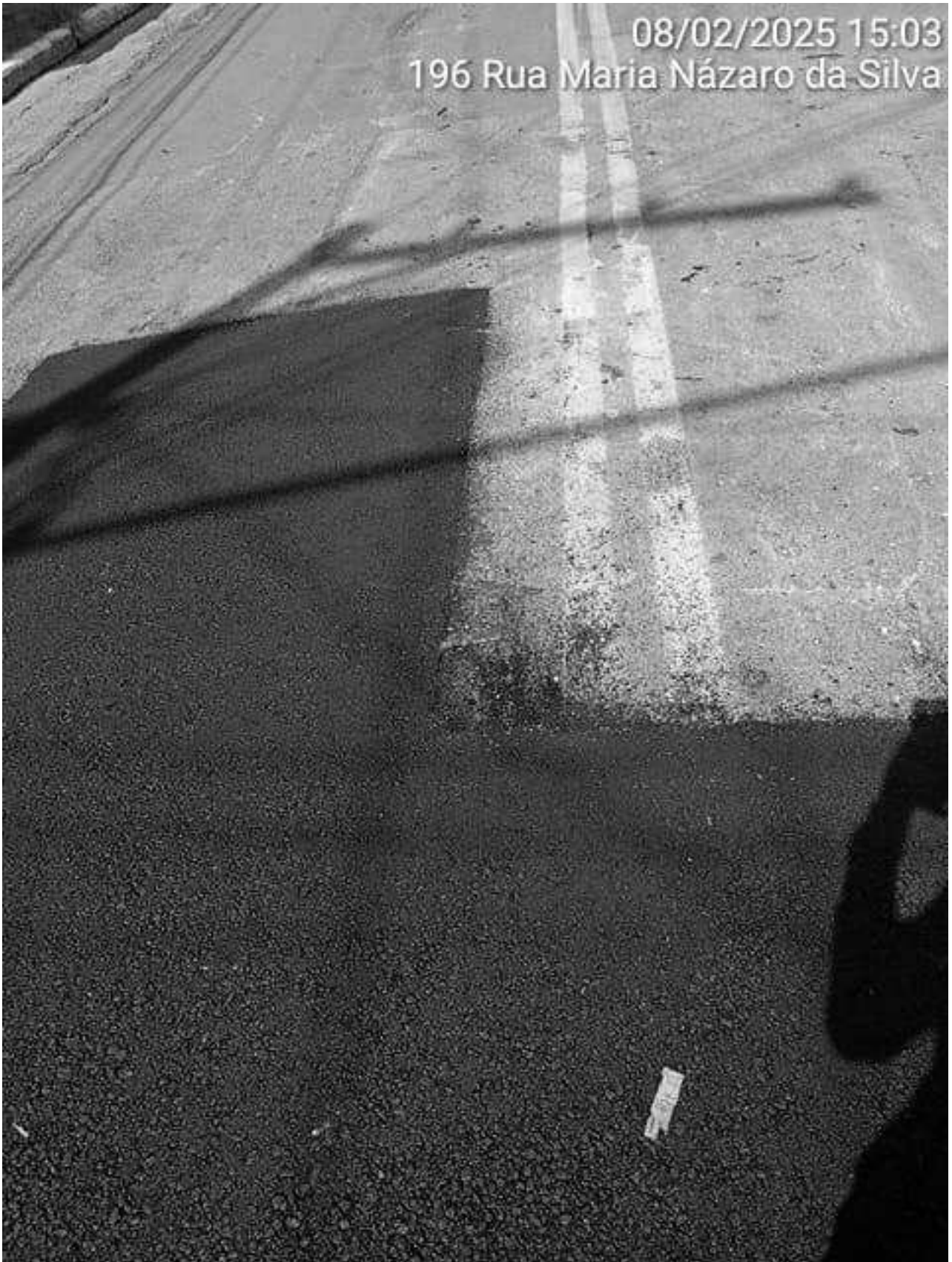
7 | ACABAMENTO → Irregularidade da via após caixa pronta: Item de OS Origem: 11201838 - (Foto Capturada Em: 10/02/25 22:24, Por: mxintadm)
