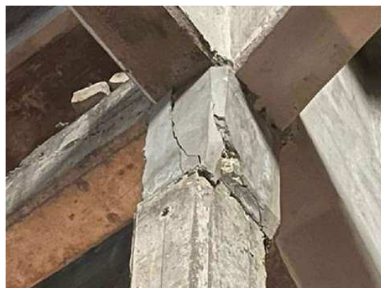
ES - 17 – Detalhe de trinca no topo do pilar
