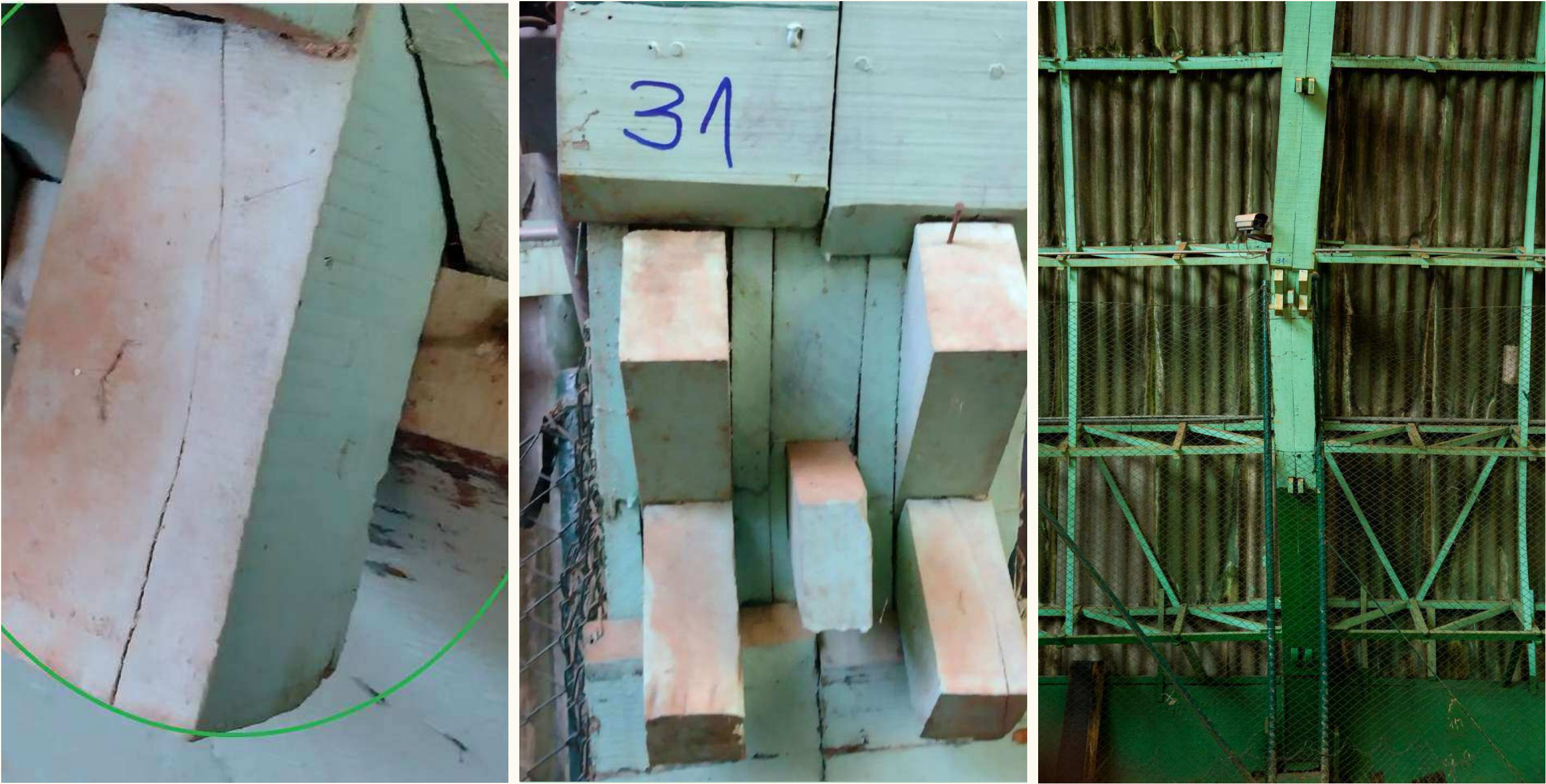
FOTOS DE PATOLOGIA DE RUPTURA DE PEÇAS NO NÓ 31 E FOTO DE DEMONSTRANDO DESLOCAMENTO HORIZONTAL DO MESMO
