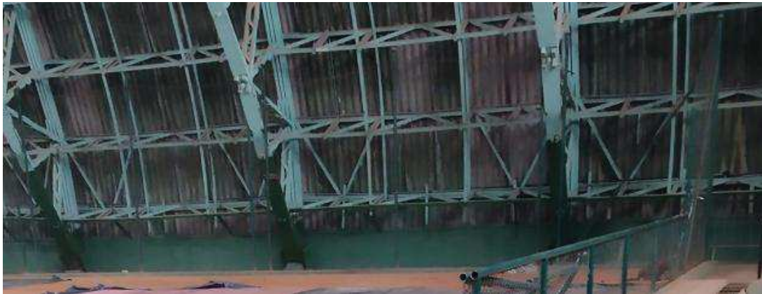
Terças radiais com flechas excessivas
