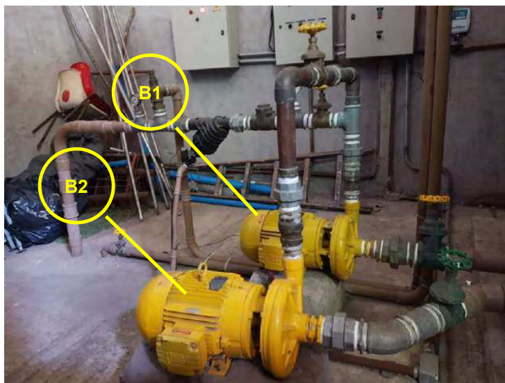
Imagem 4 – Bombas do sistema de Irrigação
