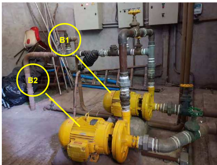
Imagem 4 – Bombas do sistema de Irrigação
