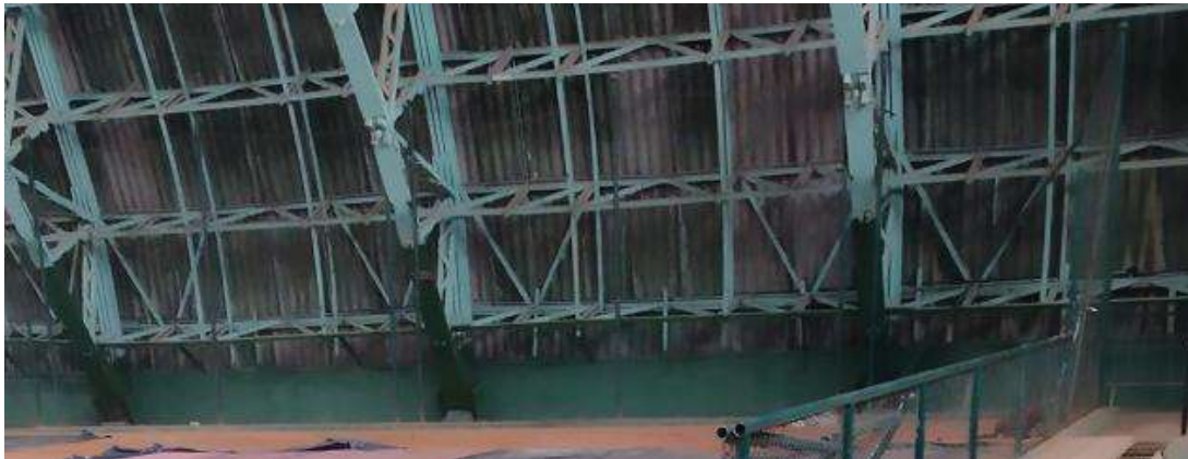
Terças radiais com flechas excessivas
