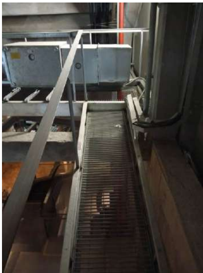
ES - 20 - Vista de passarela metálica e equipamentos fixados na estrutura da arquibancada
