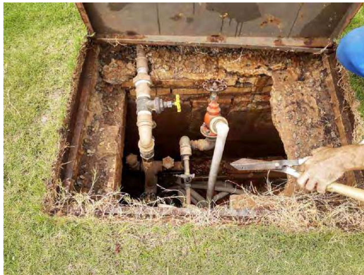
Imagem 7 - Registro do sistema de irrigação
