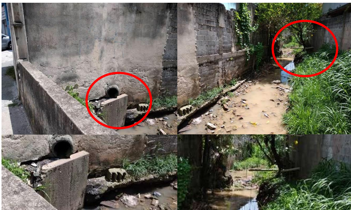
FOTO 4- VISTA DOS POTENCIAIS PONTOS DE LANÇAMENTOS CONSTATADOS NA PORÇÃO À JUSANTE DO CURSO D'ÁGUA NO TRECHO DO NÚCLEO URBANO LOTEAMENTO SD/ AC. R. LUIZ ROTTA. REGISTRO EM 28/12/2023.
