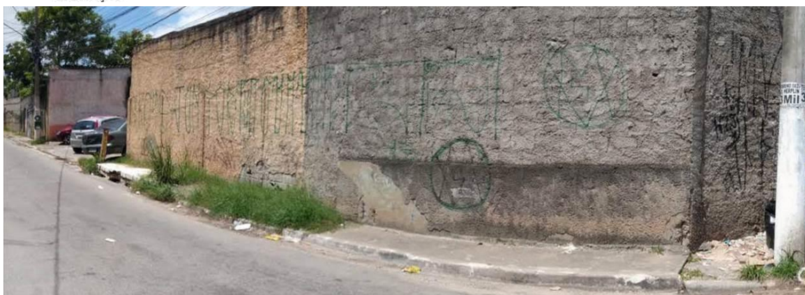
FOTO 5- MURO DE DIVISA DO IMÓVEL ADJACENTE A RUA SAMARINDA, ONDE O GUARDA CORPO DA PONTE E TODA A EXTENSÃO DE AMBAS AS MARGENS DO CURSO D'ÁGUA FORAM VEDADOS, IMPOSSIBILITANDO A VAZÃO DO DEFLÚVIO PARA O INTERIOR DO CANAL. REGISTRO EM 28/12/2023.
