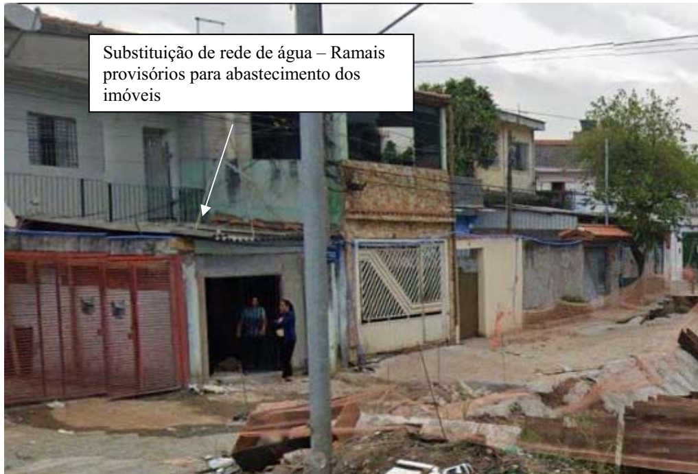
Imagem 04: Av Deputado José Aristodemo Pinotti - Google Maps, abril de 2023 – Ocorrência de afundamento na pista e desmoronamento de parte da margem – Substituição de rede de água
