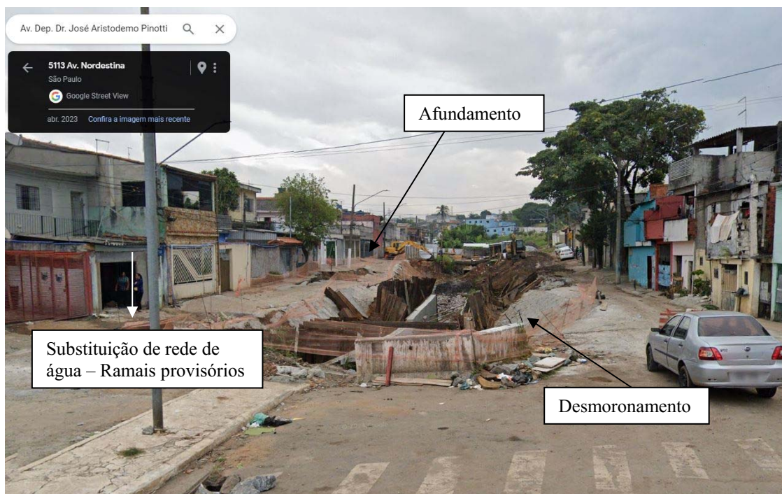
Imagem 03: Av Deputado José Aristodemo Pinotti - Google Maps, abril de 2023 – Ocorrência de afundamento na pista e desmoronamento de parte da margem – Substituição de rede de água e esgoto
