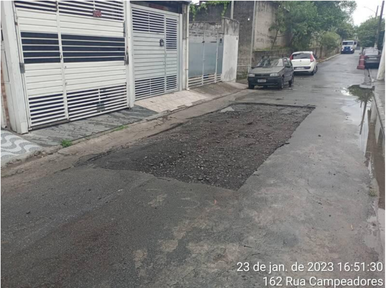
17 | ACABAMENTO → Irregularidade da via após caixa pronta: Item de OS APLICAÇÃO DE MASSA Origem: 6608901 - (Foto Capturada Em: 08/03/23 12:59, Por: mxintadm)
