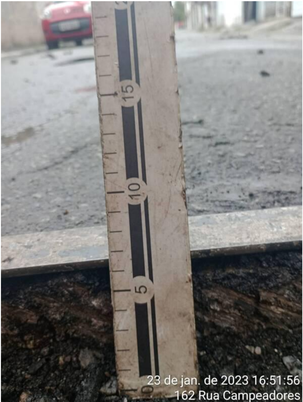
19 | ACABAMENTO → Irregularidade da via após caixa pronta: Item de OS APLICAÇÃO DE MASSA Origem: 6608901 - (Foto Capturada Em: 08/03/23 12:59, Por: mxintadm)
