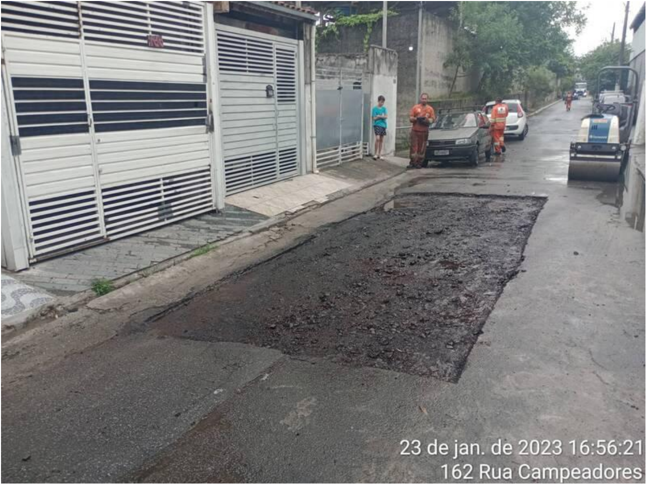
14 | ACABAMENTO → Irregularidade da via após caixa pronta: Item de OS APLICAÇÃO DE MASSA Origem: 6608901 - (Foto Capturada Em: 08/03/23 12:59, Por: mxintadm)
