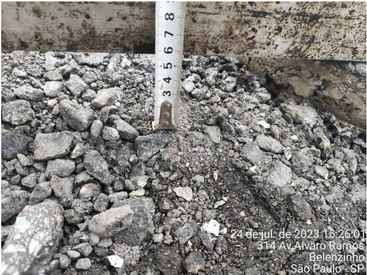
11 | ACABAMENTO → Irregularidade da via após caixa pronta: Item de OS APLICAÇÃO DE MASSA Origem: 7527159 - (Foto Capturada Em: 25/07/23 06:28, Por: mxintadm)
