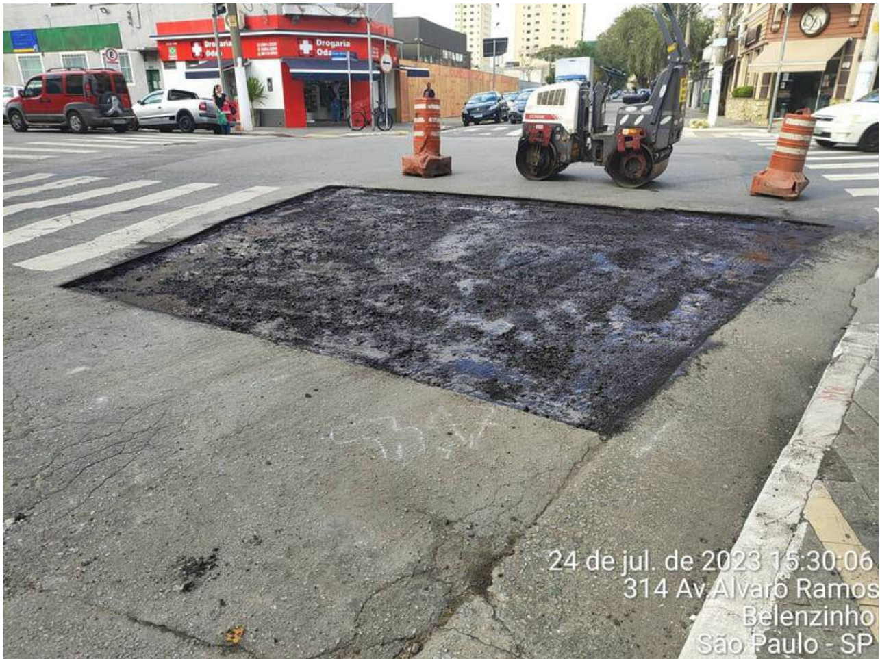
7 | ACABAMENTO → Irregularidade da via após caixa pronta: Item de OS APLICAÇÃO DE MASSA Origem: 7527159 - (Foto Capturada Em: 25/07/23 06:28, Por: mxintadm)
