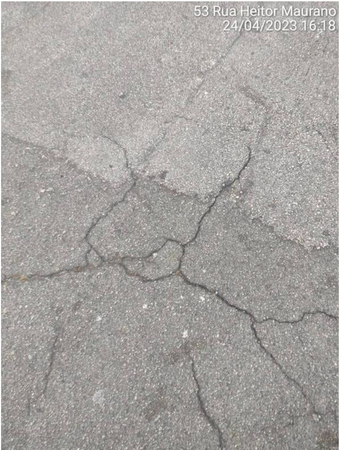
4 | ACABAMENTO → Irregularidade da via após caixa pronta: Item de OS APLICAÇÃO DE MASSA Origem: 6906127 - (Foto Capturada Em: 25/04/23 17:33, Por: mxintadm)
