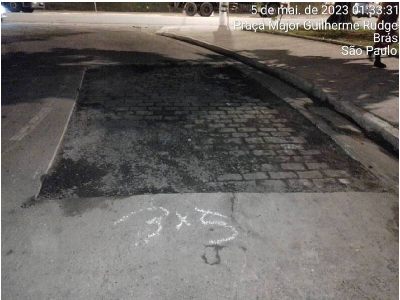
6 | ACABAMENTO → Irregularidade da via após caixa pronta: Item de OS APLICAÇÃO DE MASSA Origem: 6902534 - (Foto Capturada Em: 08/05/23 14:52, Por: mxintadm)
