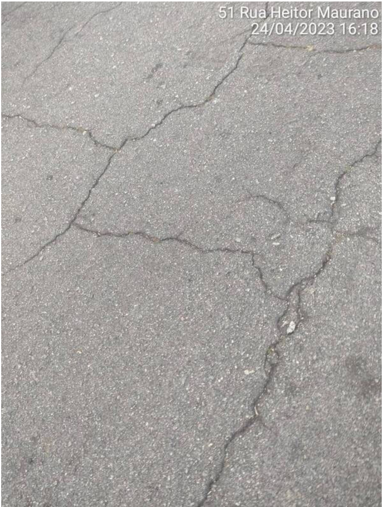
9 | ACABAMENTO → Irregularidade da via após caixa pronta: Item de OS APLICAÇÃO DE MASSA Origem: 6906127 - (Foto Capturada Em: 25/04/23 17:33, Por: mxintadm)
