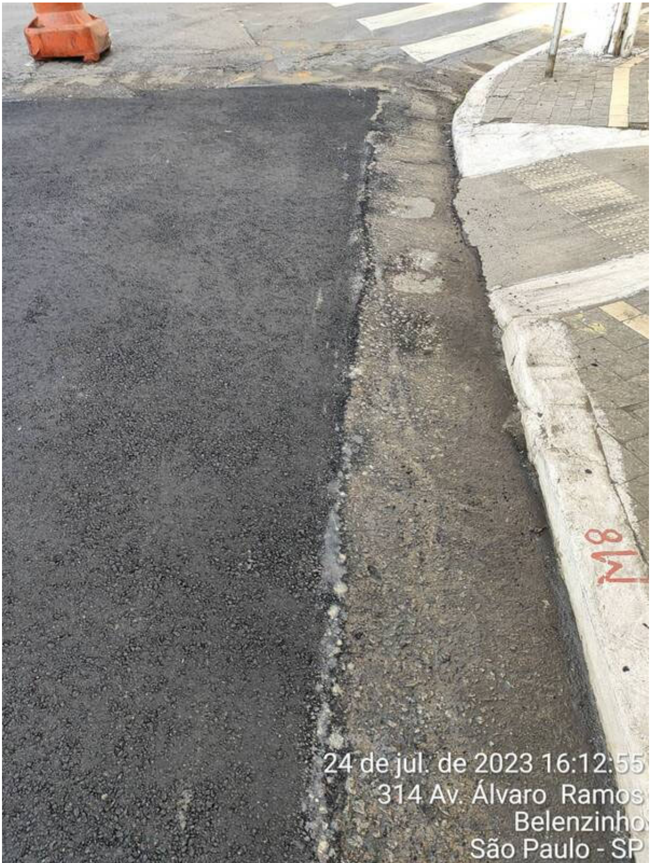
5 | ACABAMENTO → Irregularidade da via após caixa pronta: Item de OS APLICAÇÃO DE MASSA Origem: 7527159 - (Foto Capturada Em: 25/07/23 06:28, Por: mxintadm)
