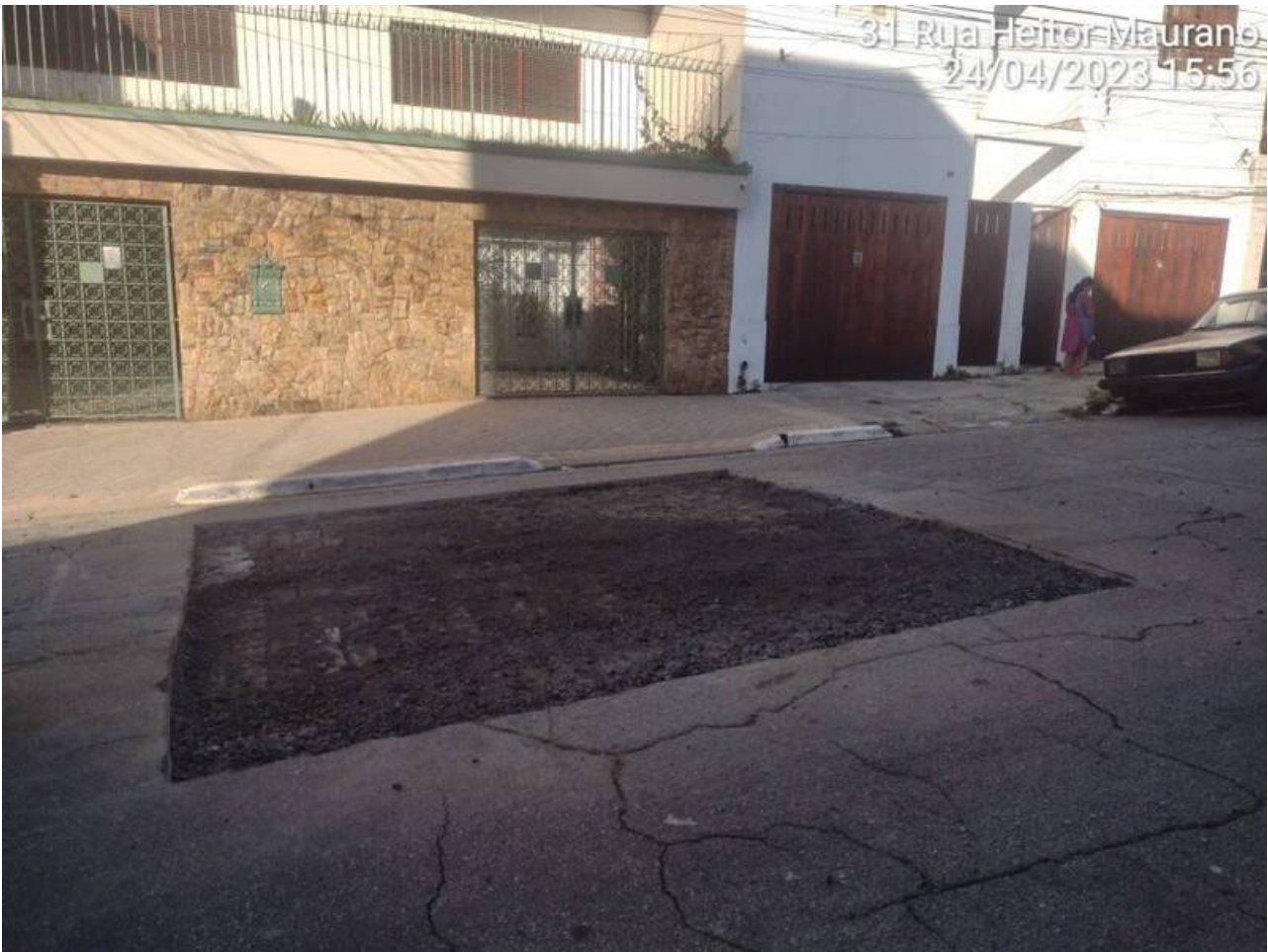
3 | ACABAMENTO → Irregularidade da via após caixa pronta: Item de OS APLICAÇÃO DE MASSA Origem: 6906127 - (Foto Capturada Em: 25/04/23 17:33, Por: mxintadm)
