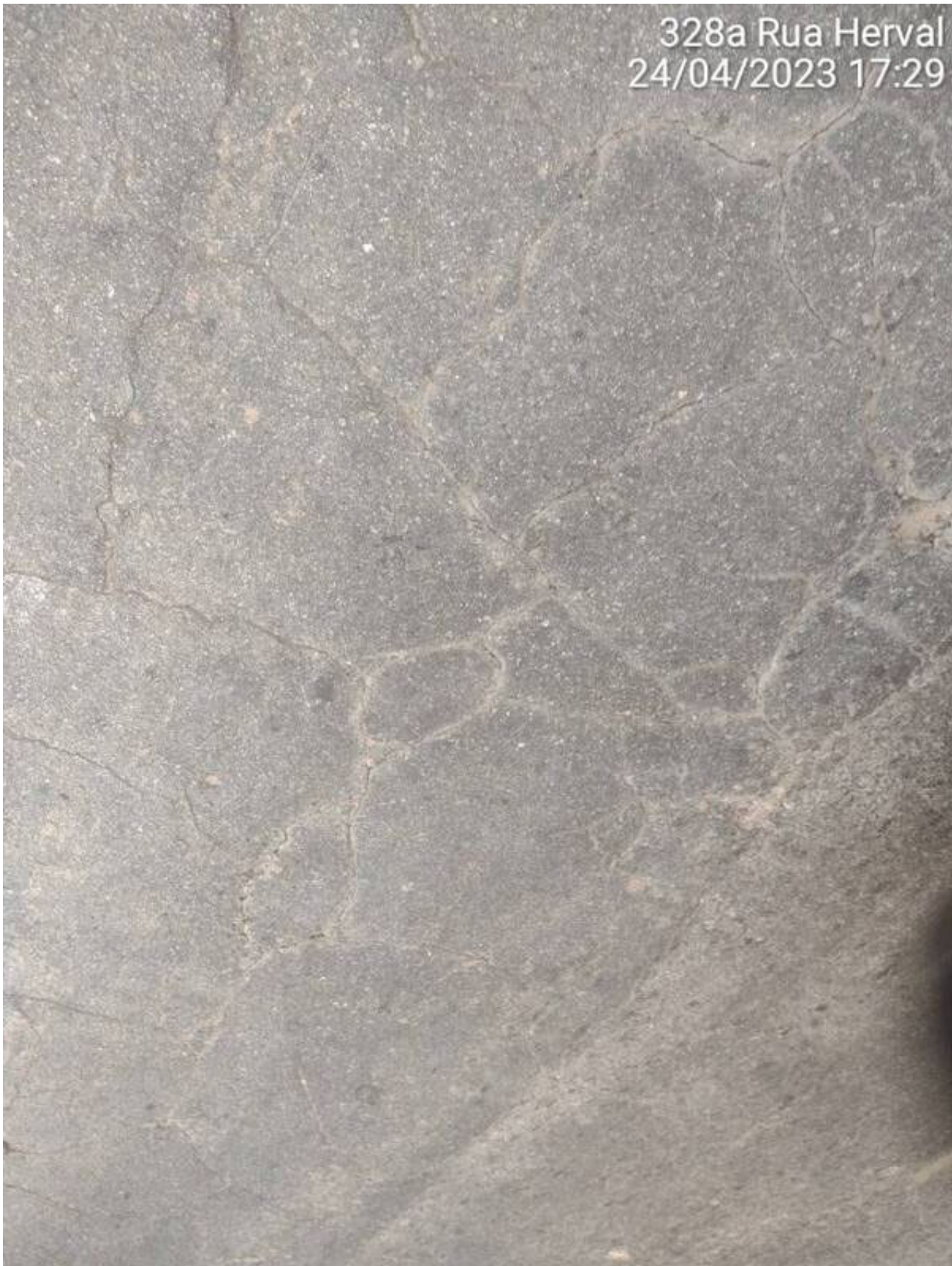
8 | ACABAMENTO → Irregularidade da via após caixa pronta: Item de OS APLICAÇÃO DE MASSA Origem: 6924447 - (Foto Capturada Em: 25/04/23 17:33, Por: mxintadm)
