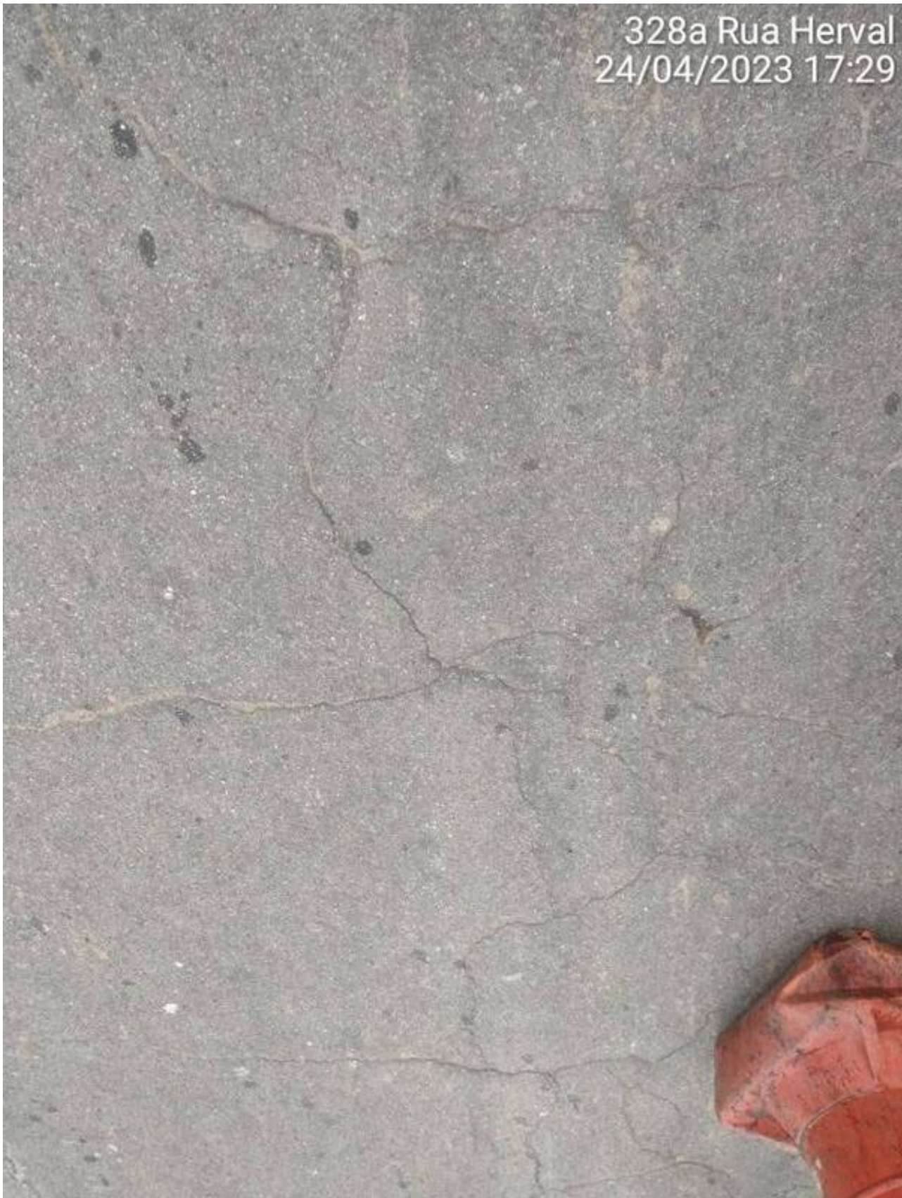
2 | ACABAMENTO → Irregularidade da via após caixa pronta: Item de OS APLICAÇÃO DE MASSA Origem: 6924447 - (Foto Capturada Em: 25/04/23 17:33, Por: mxintadm)
