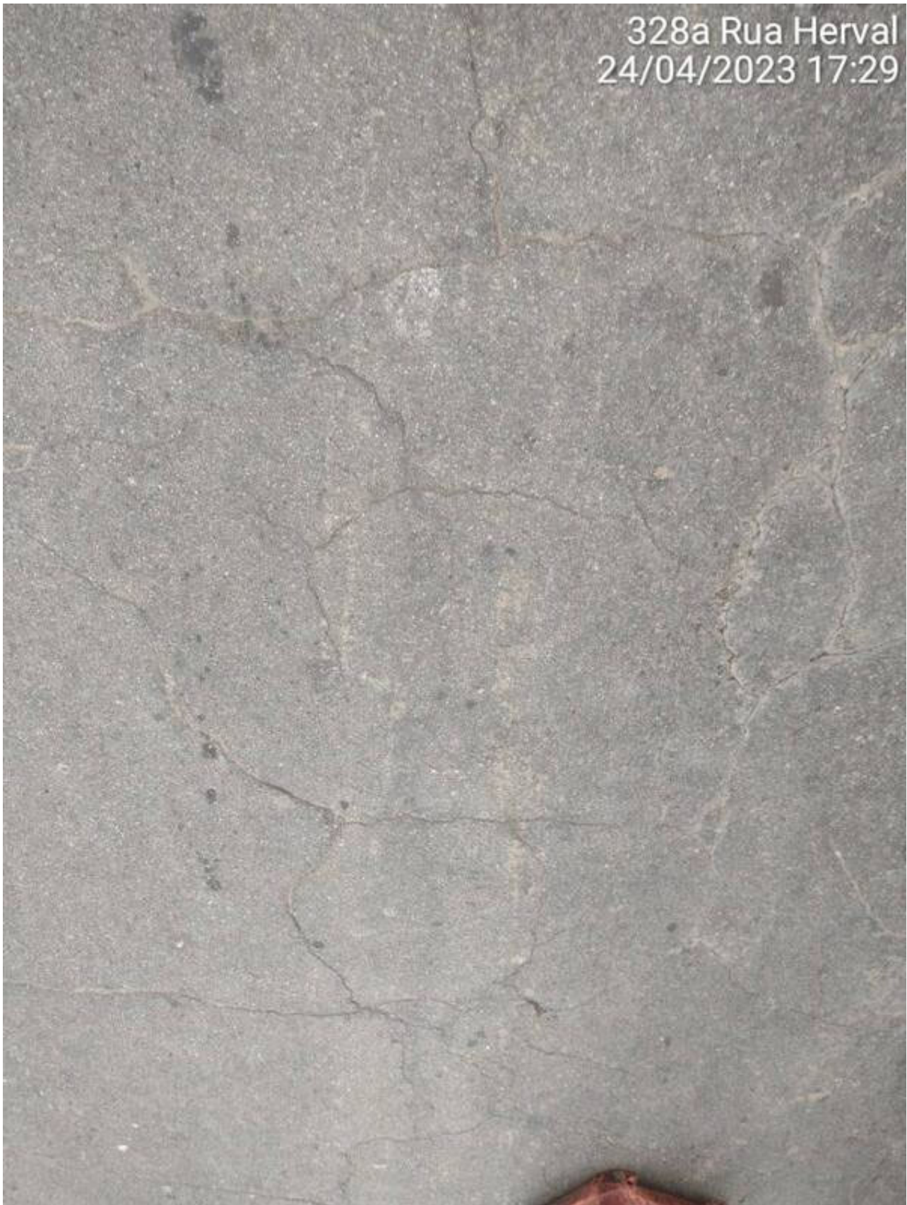
7 | ACABAMENTO → Irregularidade da via após caixa pronta: Item de OS APLICAÇÃO DE MASSA Origem: 6924447 - (Foto Capturada Em: 25/04/23 17:33, Por: mxintadm)
