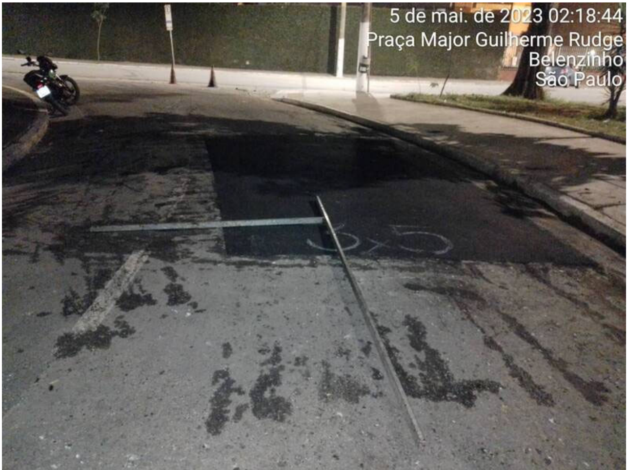
8 | ACABAMENTO → Irregularidade da via após caixa pronta: Item de OS APLICAÇÃO DE MASSA Origem: 6902534 - (Foto Capturada Em: 08/05/23 14:52, Por: mxintadm)
