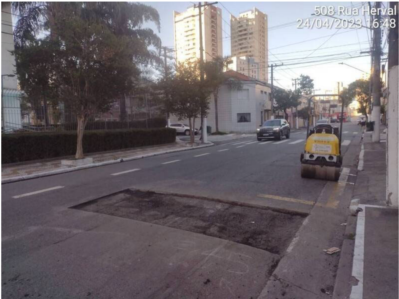
6 | ACABAMENTO → Irregularidade da via após caixa pronta: Item de OS APLICAÇÃO DE MASSA Origem: 6924447 - (Foto Capturada Em: 25/04/23 17:33, Por: mxintadm)
