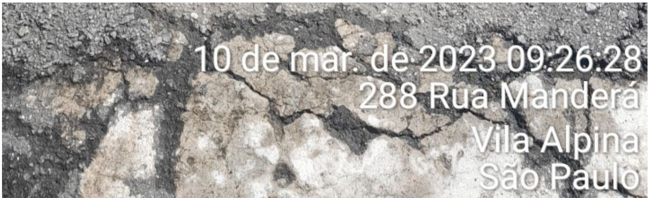
4 | OS TAPA BURACO CONSERVACAO PAVIMENTO Origem: 6816087 - (Foto Capturada Em: 10/03/23 09:27, Por: JHONATAM RODRIGUES)
