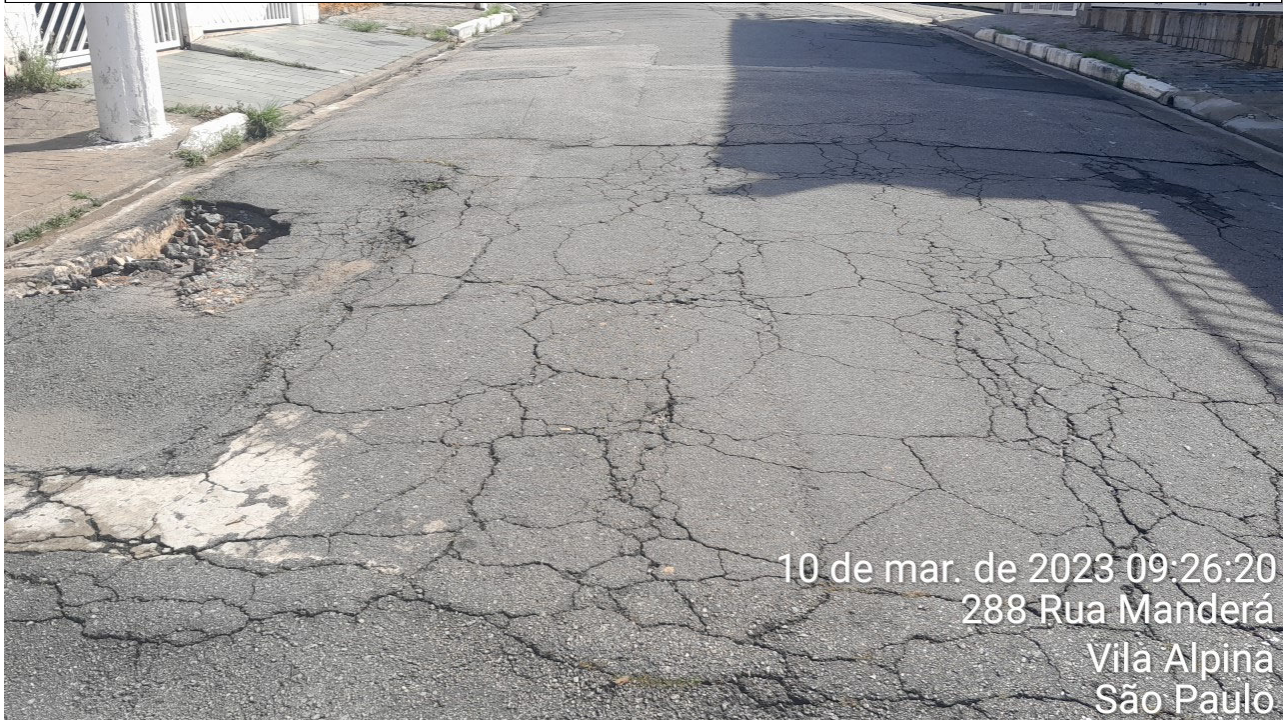
5 | OS TAPA BURACO CONSERVACAO PAVIMENTO Origem: 6816087 - (Foto Capturada Em: 10/03/23 09:27, Por: JHONATAM RODRIGUES)
