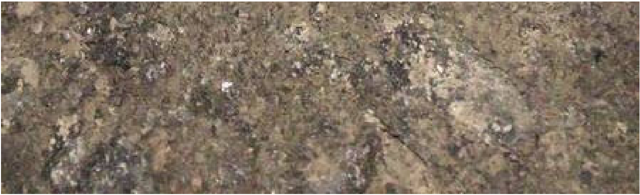
6 | ACABAMENTO → Irregularidade da via após caixa pronta: Item de OS APLICAÇÃO DE MASSA Origem: 6877494 - (Foto Capturada Em: 27/03/23 10:49, Por: mxintadm)
