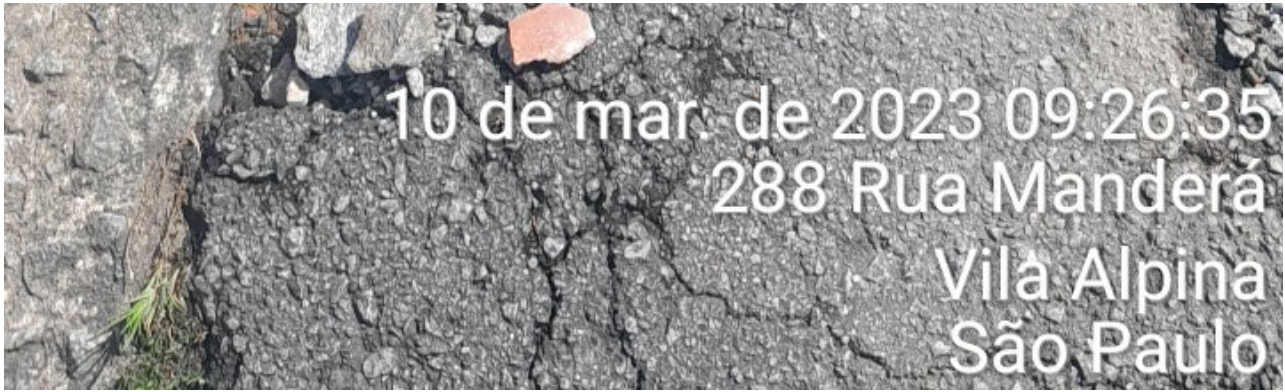
3 | OS TAPA BURACO CONSERVACAO PAVIMENTO Origem: 6816087 - (Foto Capturada Em: 10/03/23 09:27, Por: JHONATAM RODRIGUES)
