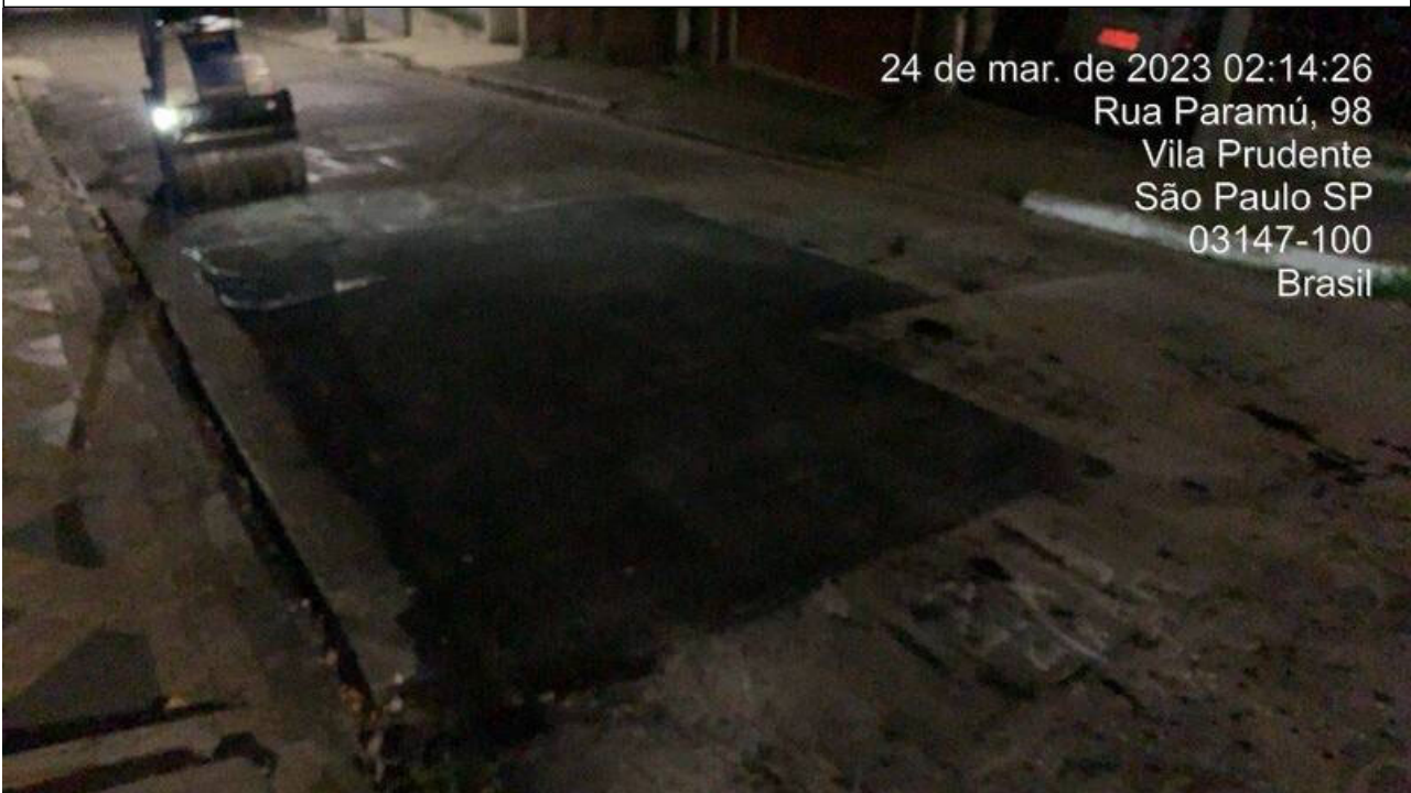
3 | ACABAMENTO → Irregularidade da via após caixa pronta: Item de OS APLICAÇÃO DE MASSA Origem: 6877494 - (Foto Capturada Em: 27/03/23 10:49, Por: mxintadm)
