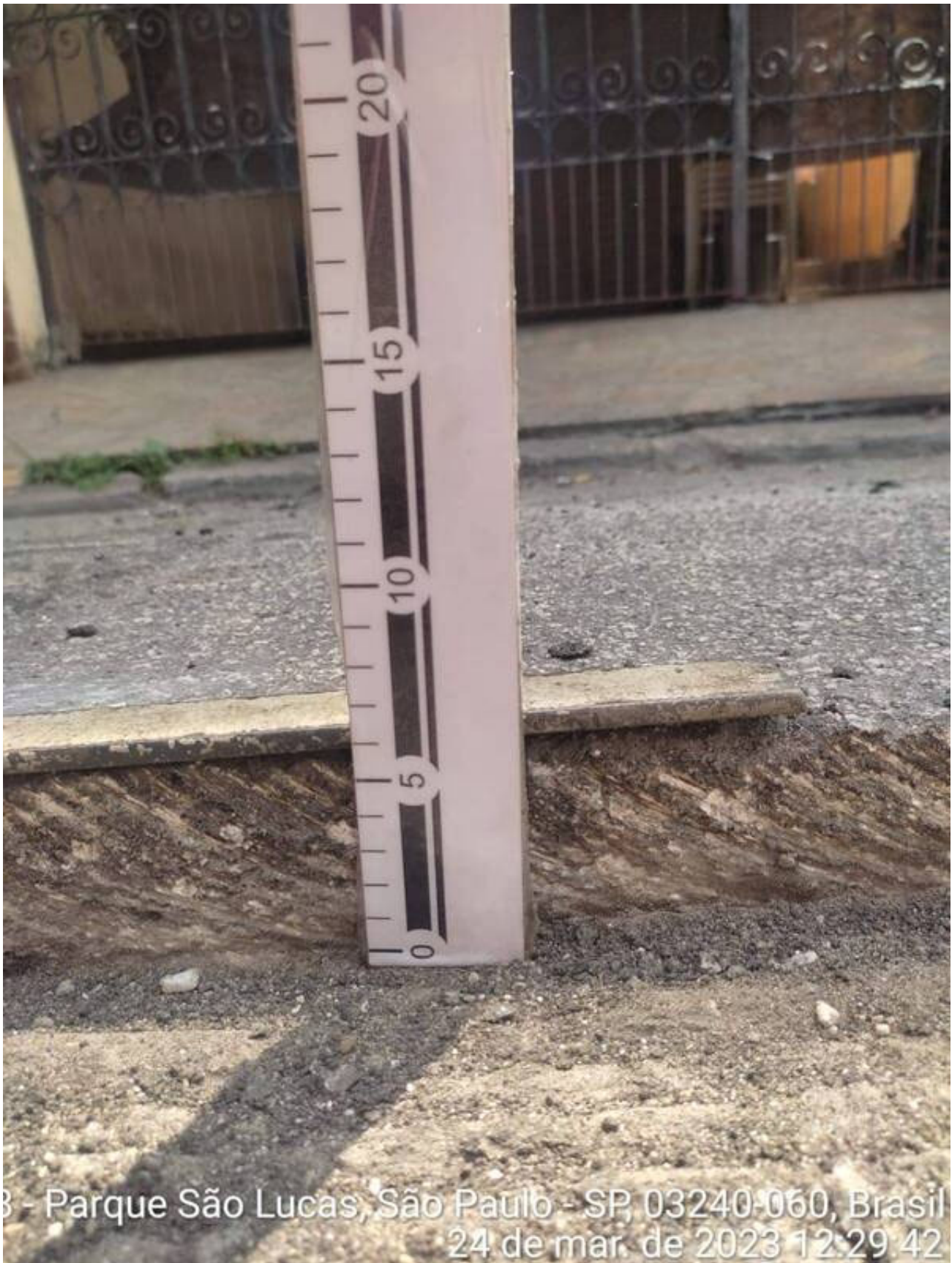
9 | ACABAMENTO → Irregularidade da via após caixa pronta: Item de OS APLICAÇÃO DE MASSA Origem: 6877467 - (Foto Capturada Em: 27/03/23 14:34, Por: mxintadm)
