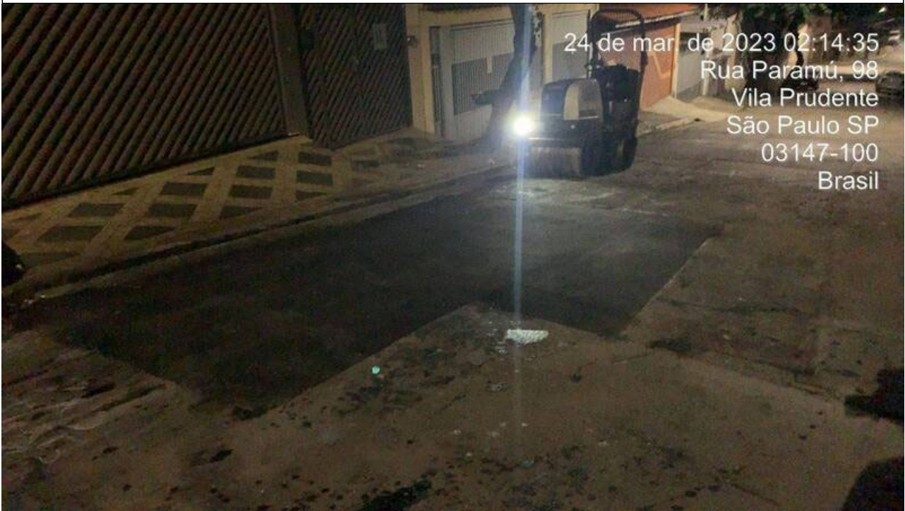
7 | ACABAMENTO → Irregularidade da via após caixa pronta: Item de OS APLICAÇÃO DE MASSA Origem: 6877494 - (Foto Capturada Em: 27/03/23 10:49, Por: mxintadm)
