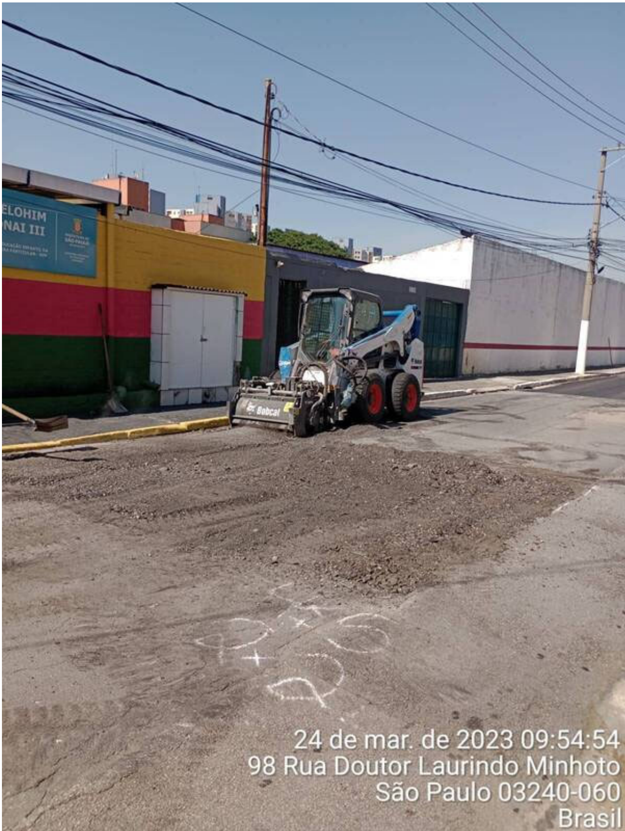
3 | Demarcação da caixa: Item de OS Origem: 6877459 - (Foto Capturada Em: 27/03/23 06:33, Por: mxintadm)
