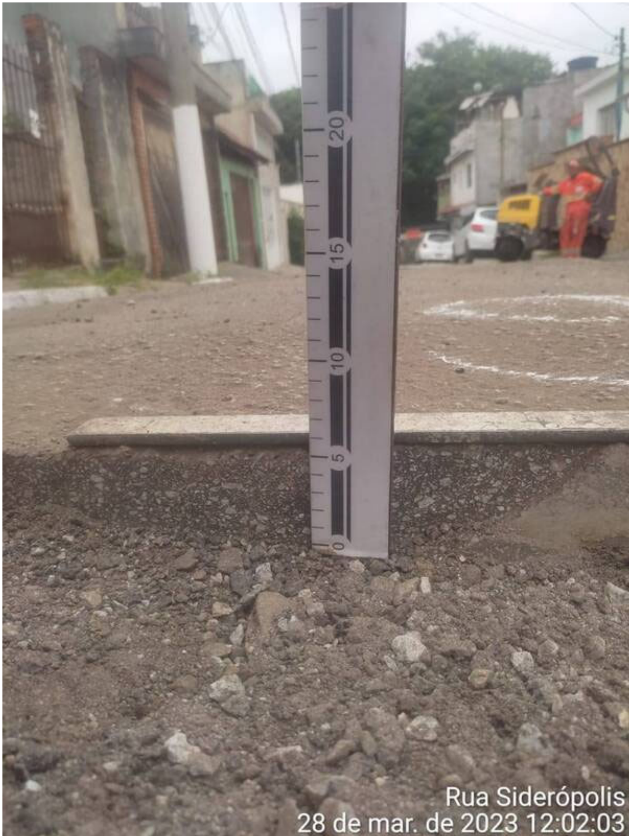
5 | ACABAMENTO → Irregularidade da via após caixa pronta: Item de OS APLICAÇÃO DE MASSA Origem: 6877487 - (Foto Capturada Em: 30/03/23 09:09, Por: mxintadm)
