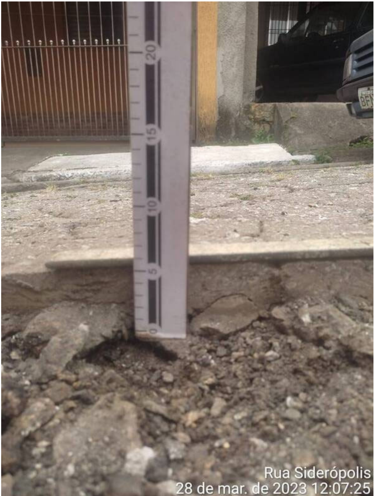
2 | ACABAMENTO → Irregularidade da via após caixa pronta: Item de OS APLICAÇÃO DE MASSA Origem: 6877487 - (Foto Capturada Em: 30/03/23 09:09, Por: mxintadm)
