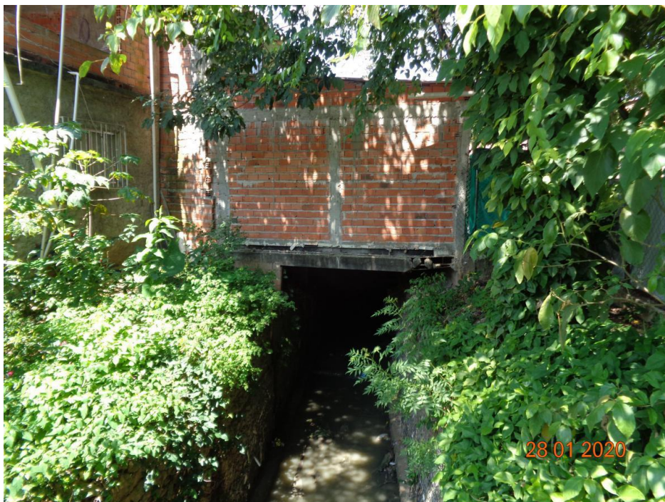
FC.MB-56-02.2: Vista geral do setor MB-56-02 - Risco Alto (R3): notar padrão construtivo das moradias sob o córrego “canalizado”.
