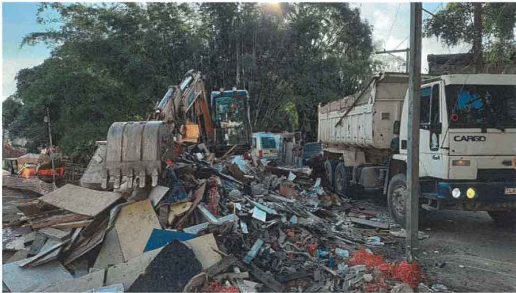
Figura 1: Local com descarte irregular de entulho
