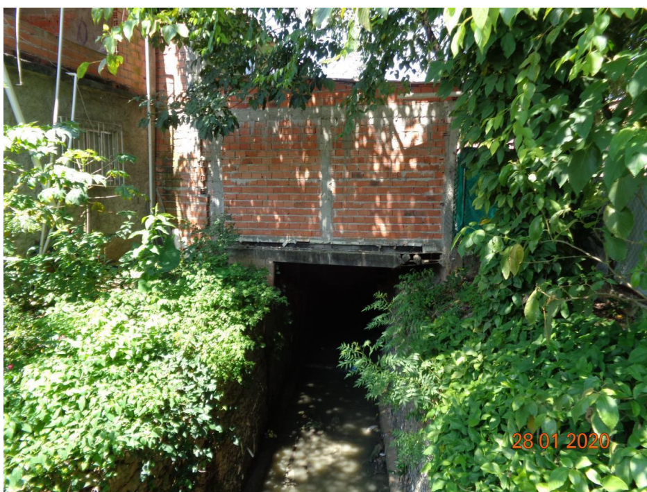
FC.MB-56-02.2: Vista geral do setor MB-56-02 - Risco Alto (R3): notar padrão construtivo das moradias sob o córrego “canalizado”.
