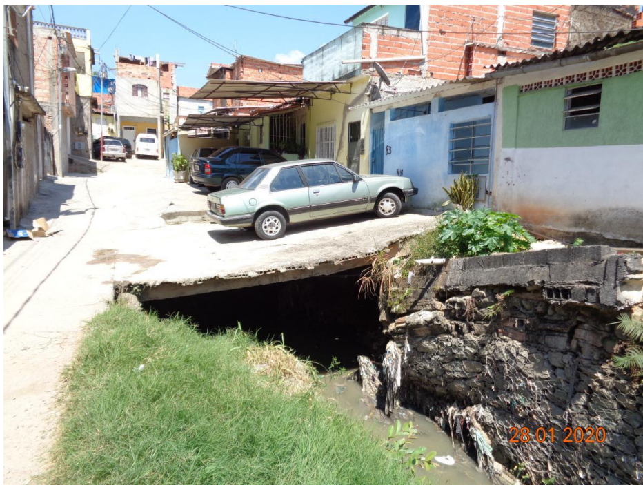
FC.MB-56-02.1: Vista geral do setor MB-56-02 - Risco Alto (R3): observar o padrão construtivo das moradias sob o córrego “canalizado”. Notar a ocorrência de solapamento na estrutura do muro de gabião às margens do córrego em trecho próximo a viela paralela a Estrada do Guavirutuba.
