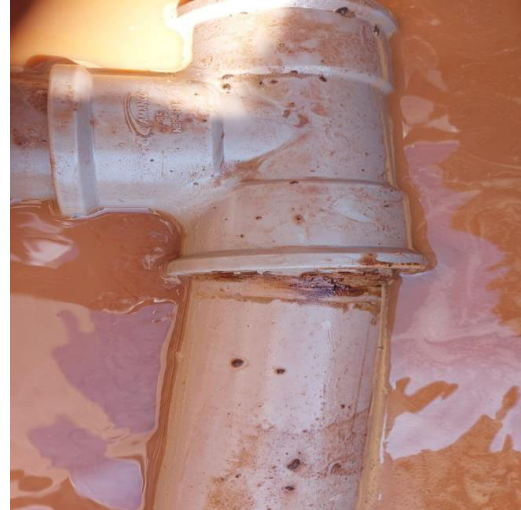
TP 1443 B T CEMEI Hidr - Vazamento da água de Reuso no playground da CEMEI - Vídeo E3
