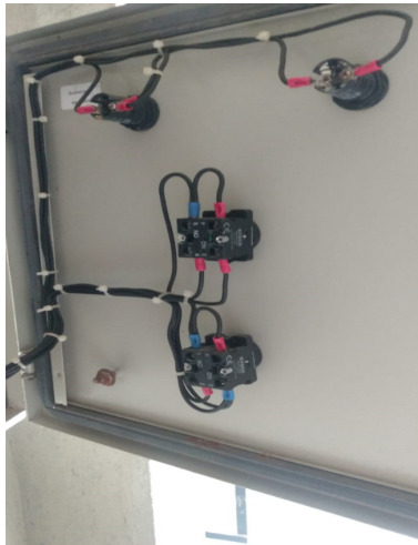
PI 1296 E T PiscInf Elétr - Quadro de Comando da Piscina Infantil - Foto A1
