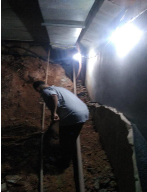
Foto 9: Escavação do talude em direção a tubulação com vazamento
