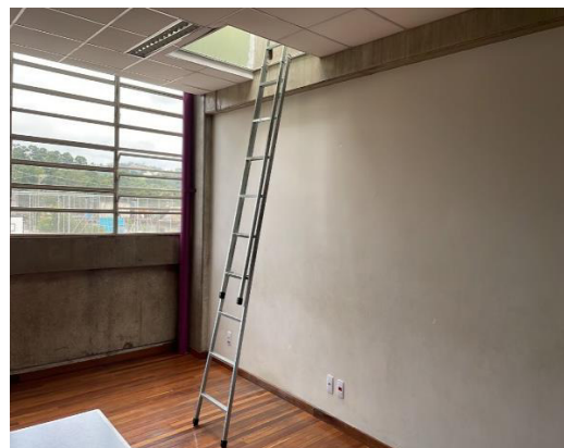
Infiltração no acesso a cobertura, sala de dança 3.
