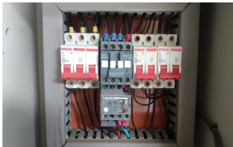
PI 1296 E T PiscInf Elétr - Quadro de Comando da Piscina Infantil - Foto A3
