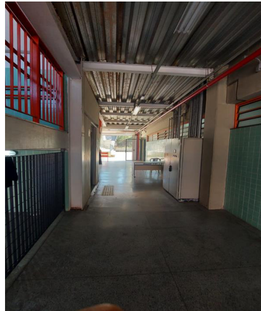
Foto 27 Elevador 5: Vista do corredor, sem CFTV
