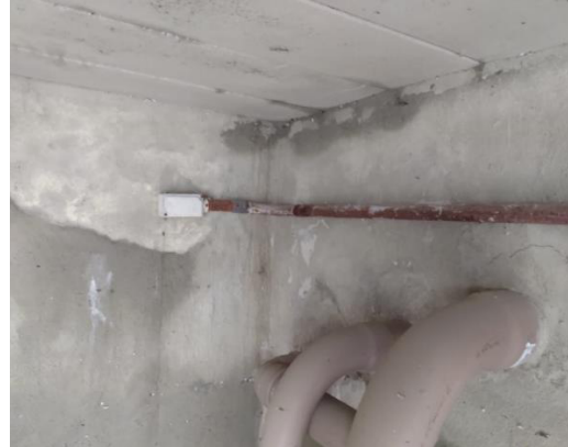
PI 1297 E T Pisc Elétr - Quadro de Comando da Piscina Semi-Olímpica - Foto A2
