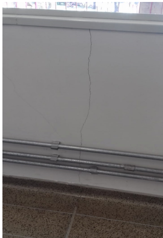
JB 1276 B 1 Biblio ObrCiv - Rachaduras na parede da biblioteca - Foto A1
