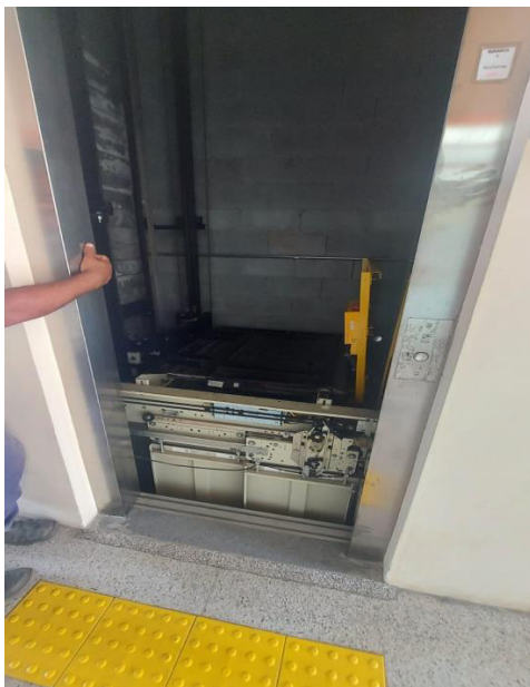
Foto 20 Elevador 5: Vista do elevador parado devido quebra da Barreira Eletrônica
