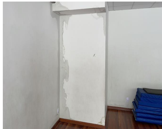
Umidade na parede da sala de dança 1, causada pela infiltração na cobertura.
