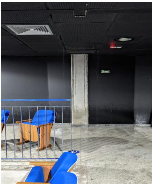
FG 1450 B 4 Vários ObrCiv - Infiltração na salas, corredores e teatro devido a forte chuva Foto A4
