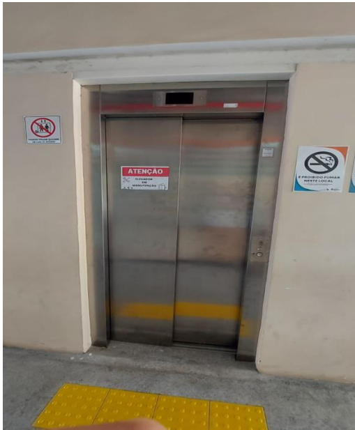
Foto 18 Elevador 5: Vista frontal do elevador
