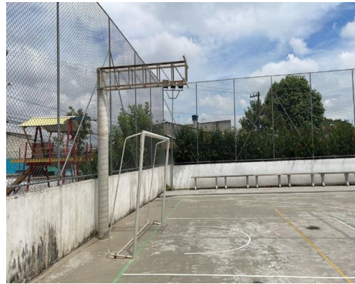
As tabelas foram retiradas por serem de madeira, material inadequado para área externa.
