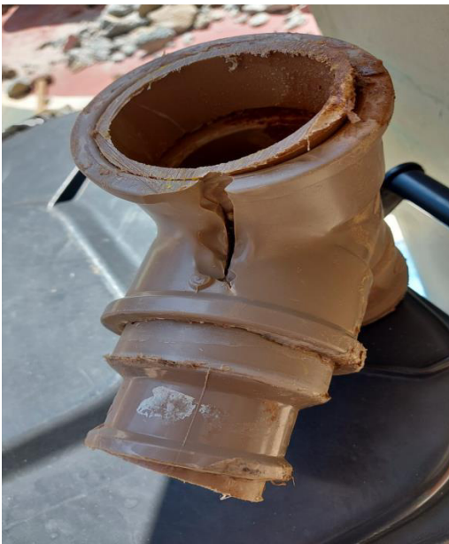
TP 1443 B T CEMEI Hidr - Vazamento da água de Reuso no playground da CEMEI - Vídeo E4
