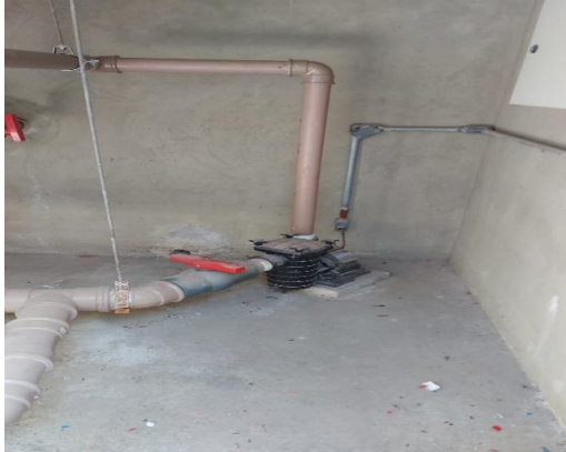
PI 1452 E T PiscInter Hidr - Bomba da Piscina Interna - Foto A1
