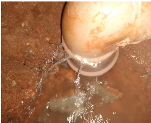
Foto 19: Tubulação com vazamento
