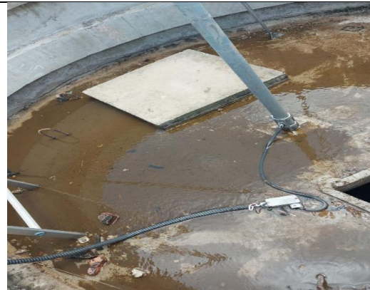
TP 1294 E C ResÁgu ObrCiv - Acúmulo de agua em torre de caixa d'agua Céu Taipas - Foto A1
