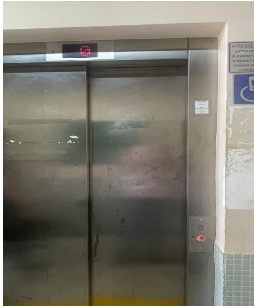
Foto 1 Elevador 1 – Elevador, falha no freio e choque com o topo da estrutura
