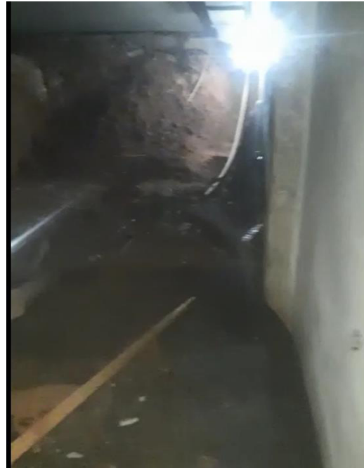
Foto 8: Vista interna do porão e do talude a ser escavado para acesso a tubulação com vazamento.
