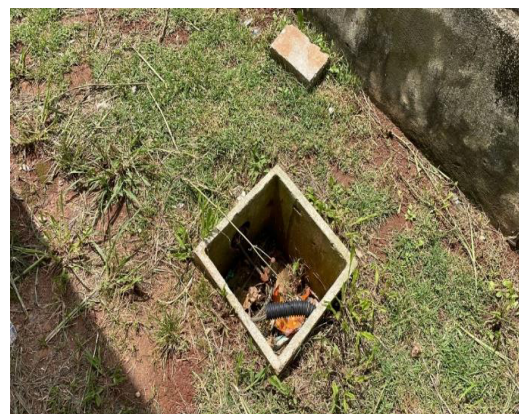
Caixas sem tampa, podendo ocasionar acidentes.
