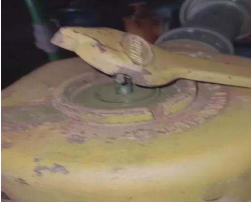
JB 1277 C T Pisc Hidr - Filtro da Piscina Externa Quebrado - Vídeo A1
