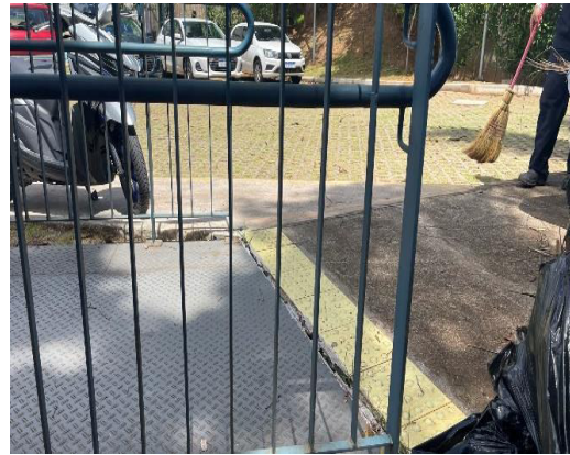
TR - Fissura - Junta de dilatação diferença de material - Estacionamento e Passarela - 09.03.23
