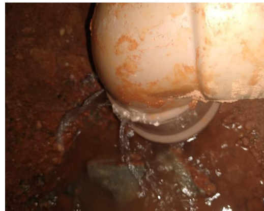
Foto 20: Tubulação com vazamento
