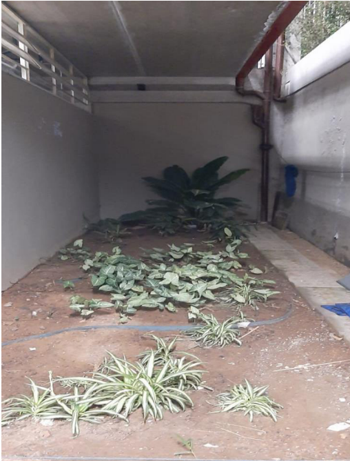
Figura 5: Sala da Limpeza, localização da tubulação danificada
