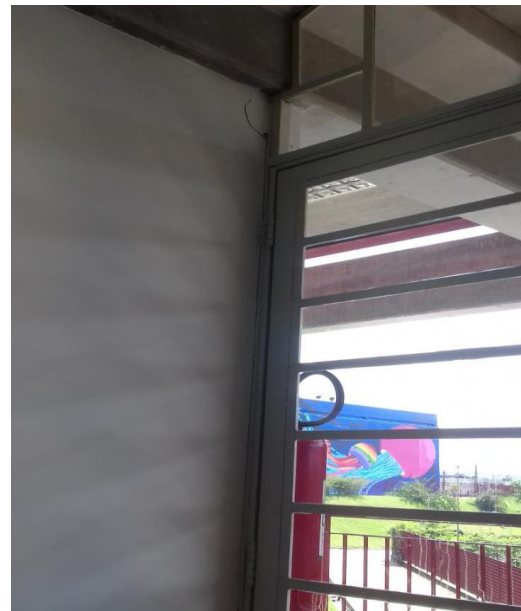
JB 1276 B 1 Biblio ObrCiv - Rachaduras na parede da biblioteca - Foto A4
