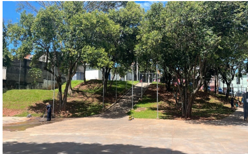
FG 1185 E T Jard ObrCiv - Deslizamento de terra - Foto A1
