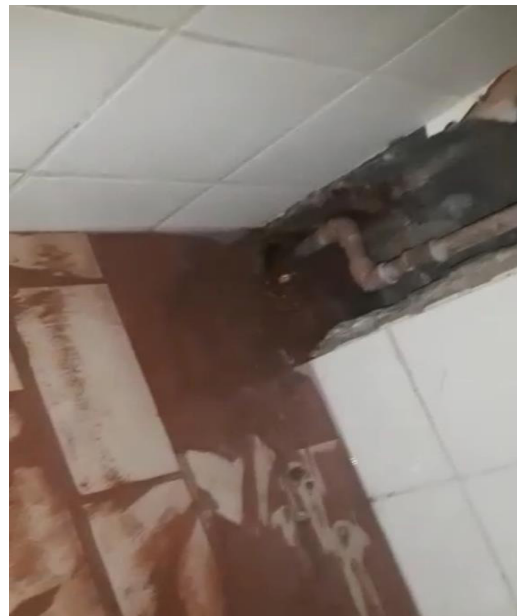
CT 1281 B S SanitVest Hidr - Vazamento Subsolo do bloco cultural - Vídeo A3
