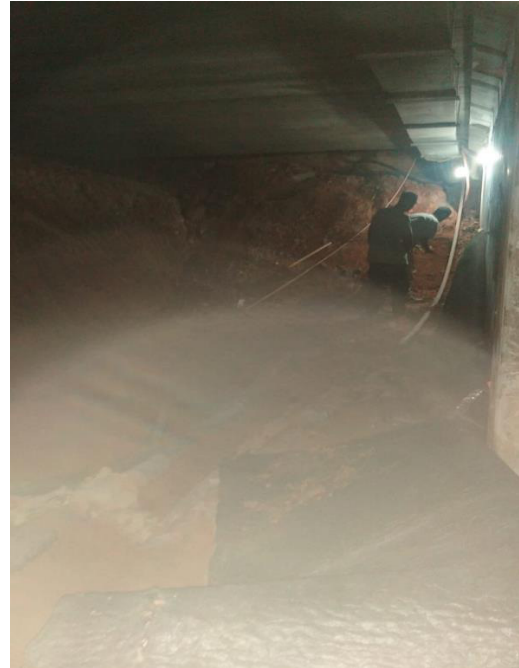
Foto 10: Escavação do talude em direção a tubulação com vazamento
