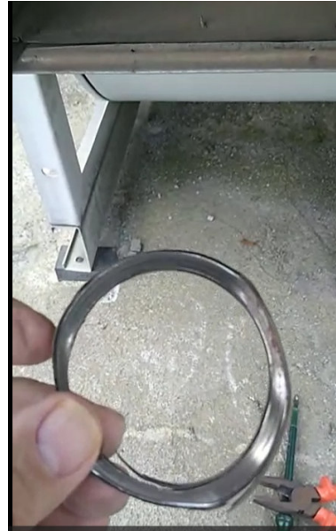
TP 1187 B C Tea ArCond - Manutenção do Ar Condicionado do Teatro - Foto A2
