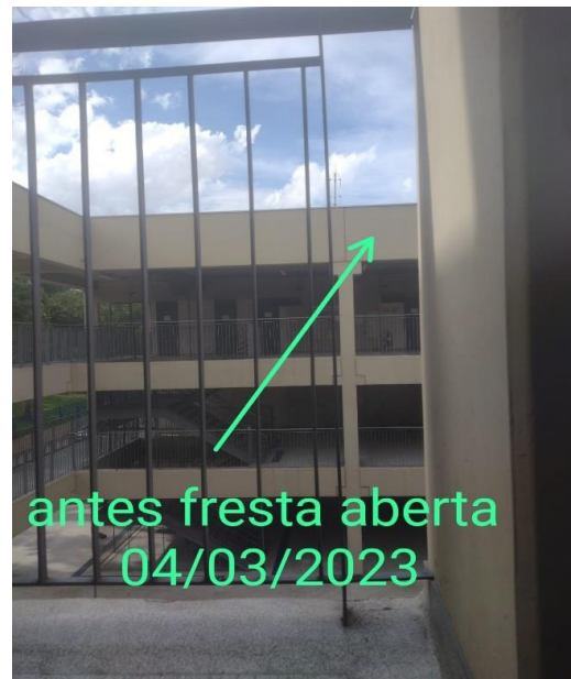
CA 1280 Td G Vários Serr - Vão excessivo no gradil - Foto A1
