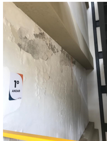
AA 1178 C T PiscInter ObrCiv - Relatório de Vistoria - Vazamento piscina interna - Foto A4
