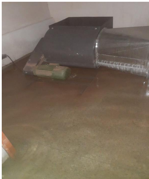
AA 1445 C SanitVest ConsEsp - Sistema de exaustão dos banheiros - Foto A1
