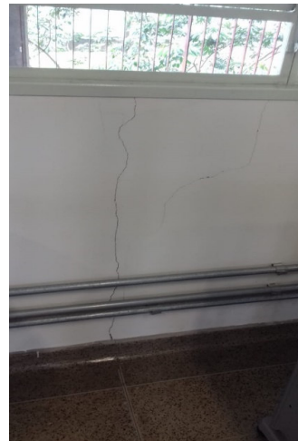
JB 1276 B 1 Biblio ObrCiv - Rachaduras na parede da biblioteca - Foto A2
