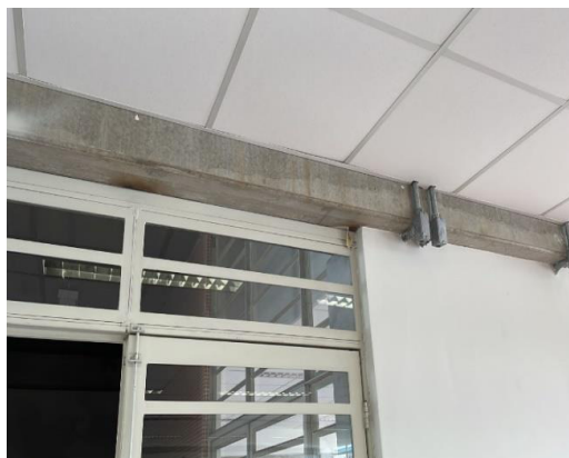
Umidade na parede da sala de dança 2, causada pela infiltração na cobertura.
