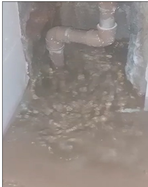
CT 1281 B S SanitVest Hidr - Vazamento Subsolo do bloco cultural - Foto A2
