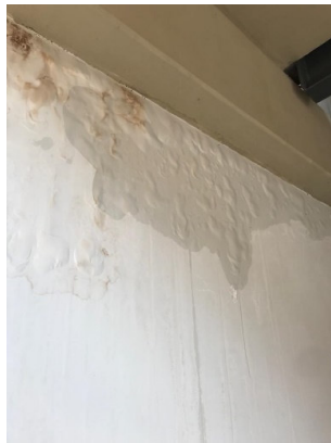
AA 1178 C T PiscInter ObrCiv - Relatório de Vistoria - Vazamento piscina interna - Foto A1
