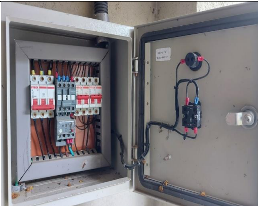
PI 1296 E T PiscInf Elétr - Quadro de Comando da Piscina Infantil - Foto D1
