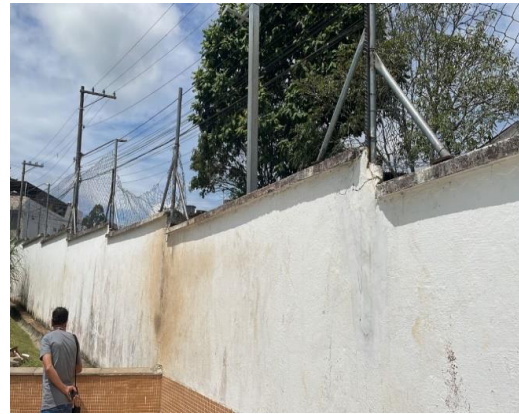
Alambrado danificado devido as invasões. Foi sugerido a substituição por gradil.
