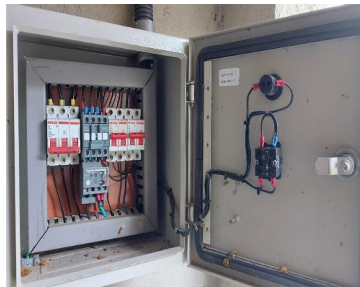
PI 1298 E T PiscInter Elétr - Quadro de Comando da Piscina Interna - Foto D1
