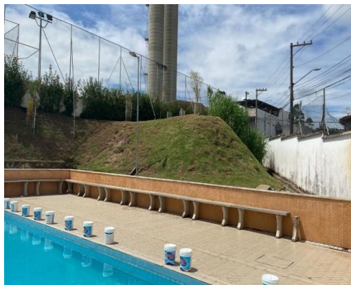
Erosão no talude na área da piscina.
