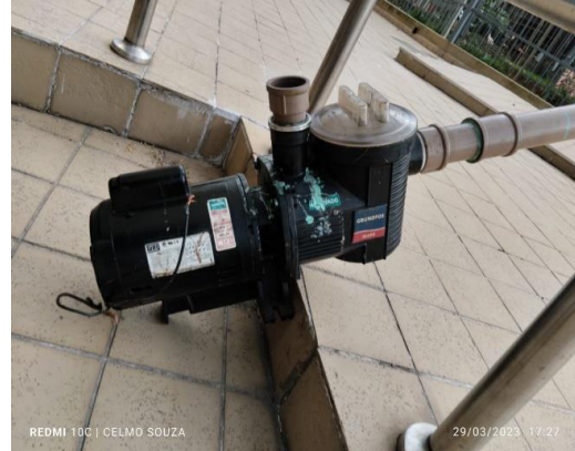
PI 1452 E T PiscInter Hidr - Bomba da Piscina Interna - Foto D6
