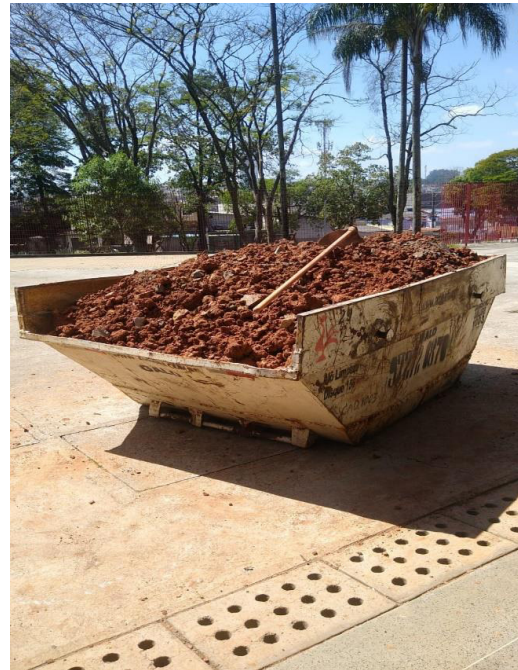
Foto 22: Caçamba com entulho
