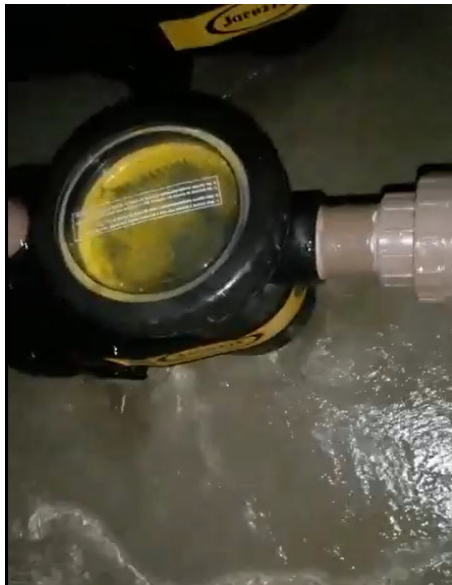
CT 1267 C 1 PiscInf Hidr - Manutenção Urgente Bomba da Piscina - Foto A1
