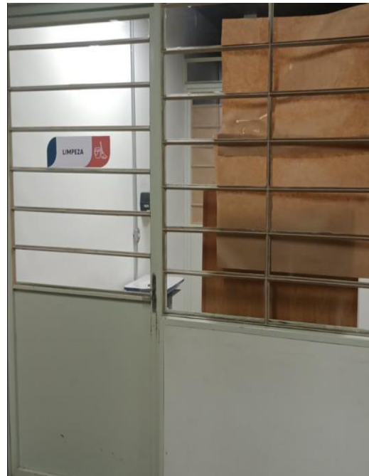
Figura 4: Sala da Limpeza, localização da tubulação danificada
