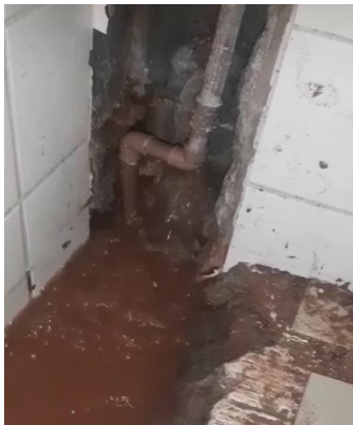
CT 1281 B S SanitVest Hidr - Vazamento Subsolo do bloco cultural - Vídeo A4
