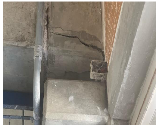
Trinca - Estrutura na piscina interna - 09.03.23
