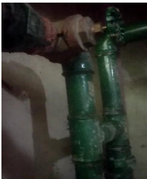
CA 1446 E G ResÁgu Hidr - Bomba Caixa d'água suspeita de vazamento - Vídeo A1
