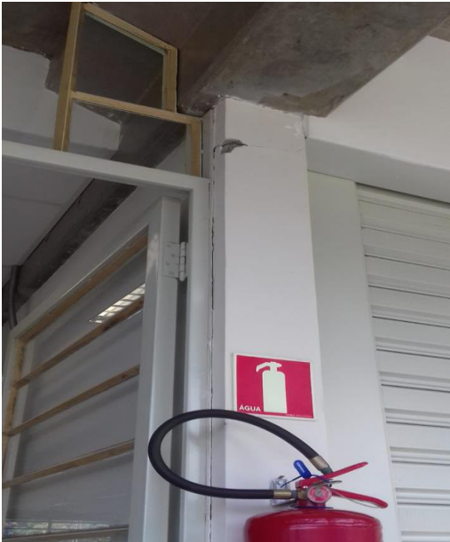
JB 1276 B 1 Biblio ObrCiv - Rachaduras na parede da biblioteca - Foto A3
