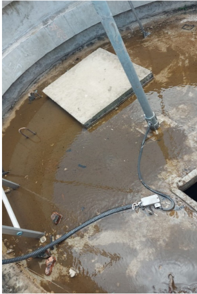
TP 1294 E C ResÁgu ObrCiv - Acúmulo de água em torre de caixa d'água - Foto A1
