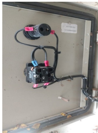
PI 1296 E T PiscInf Elétr - Quadro de Comando da Piscina Infantil - Foto A5
