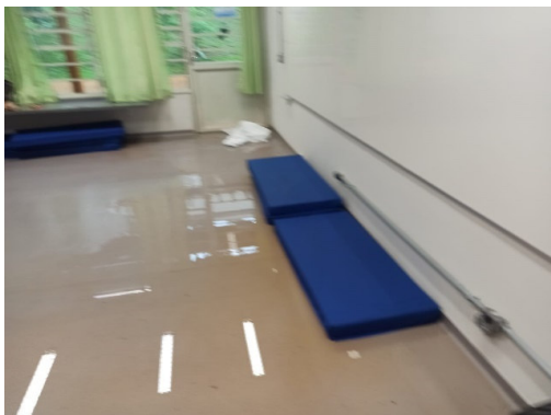
JB 1278 Td G Vários ObrCiv - Alagamento de vários ambientes devido forte chuva -Foto A1
