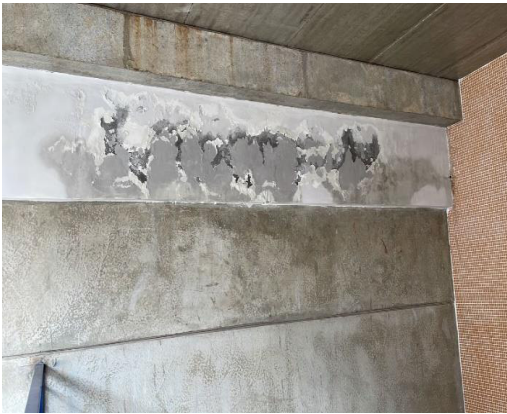
Umidade constante na parede.
