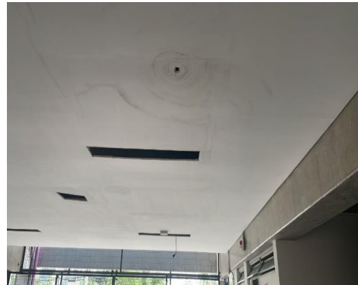
Umidade no forro causada por vazamento na rede Hidráulica.
