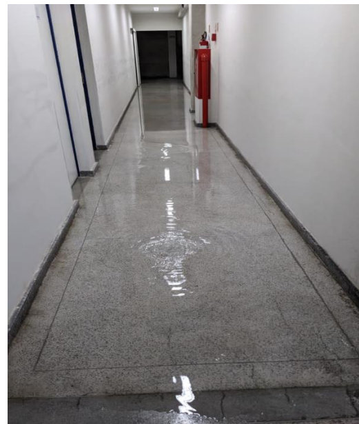
FG 1450 B 4 Vários ObrCiv - Infiltração nas salas, corredores e teatro devido à forte chuva Foto A6
