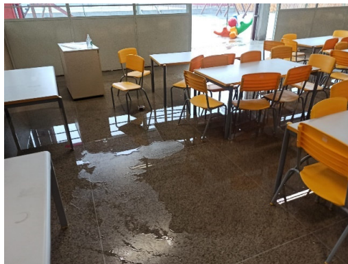
JB 1278 Td G Vários ObrCiv - Alagamento de vários ambientes devido forte chuva - Foto A4
