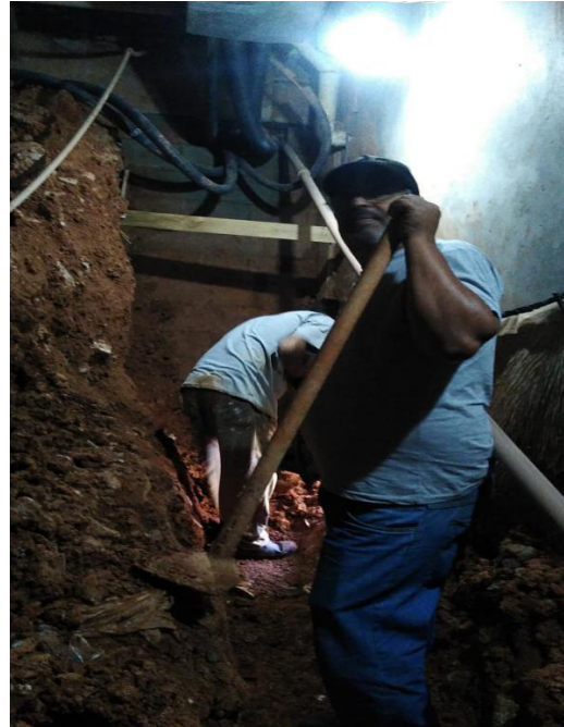
Foto 14: Escavação do talude em direção a tubulação com vazamento
