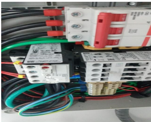
PI 1298 E T PiscInter Elétr - Quadro de Comando da Piscina Interna - Foto D1
