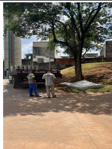
FG 1185 E T Jard ObrCiv - Deslizamento de terra - Foto A6
