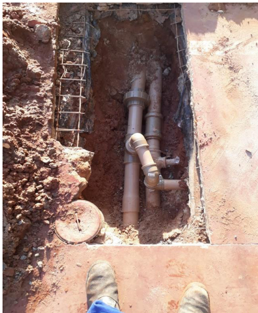
TP 1443 B T CEMEI Hidr - Vazamento da água de Reuso no playground da CEMEI - Vídeo D1
