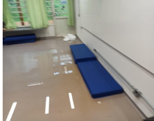
JB 1278 Td G Vários ObrCiv - Alagamento de vários ambientes devido forte chuva - Foto A1
