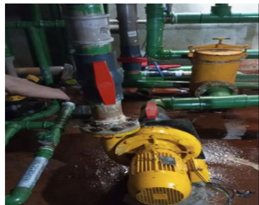
SM 1299 E T Pisc ConsEsp - Reparo Urgente em Bomba da Piscina - Vídeo A1
