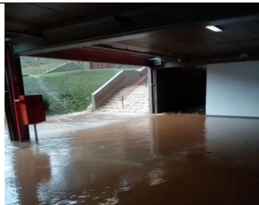
JB 1278 Td G Vários ObrCiv - Alagamento de vários ambientes devido forte chuva Vídeo A2
