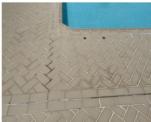
Trincas no deck da piscina, foram apontadas como manutenção.
