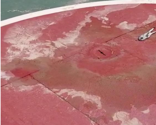
TP 1443 B T CEMEI Hidr - Vazamento da água de Reuso no playground da CEMEI - Vídeo A1
