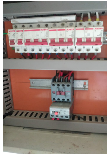
PI 1296 E T PiscInf Elétr - Quadro de Comando da Piscina Infantil - Foto A2
