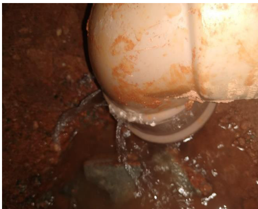
Tubulação com vazamento
