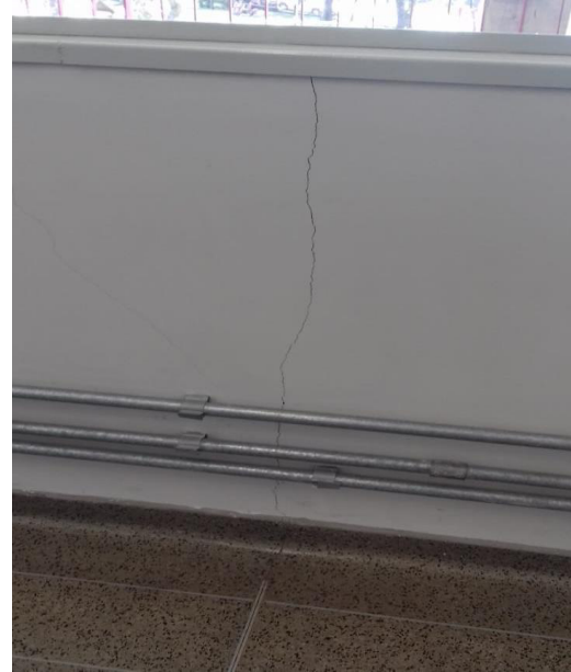
JB 1276 B 1 Biblio ObrCiv - Rachaduras na parede da biblioteca - Foto A1
