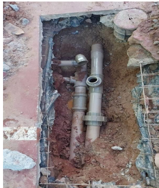
TP 1443 B T CEMEI Hidr - Vazamento da água de Reuso no playground da CEMEI - Vídeo E6
