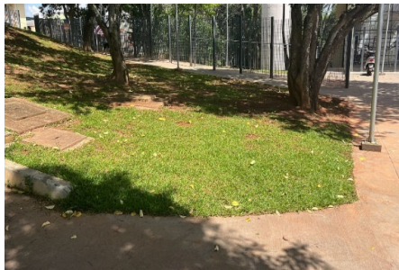
FG 1185 E T Jard ObrCiv - Deslizamento de terra - Foto A4
