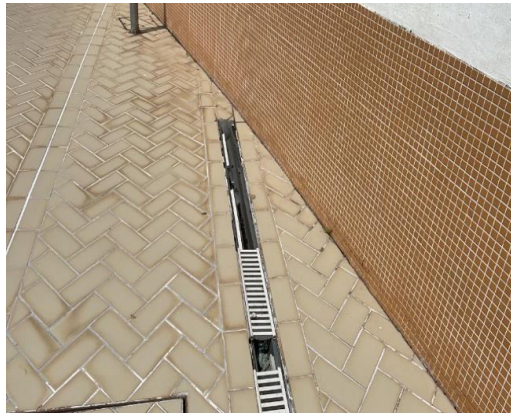
Ralos na área da piscina danificados.
