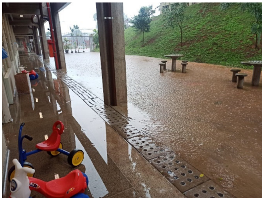
JB 1278 Td G Vários ObrCiv - Alagamento de vários ambientes devido forte chuva - Foto A3
