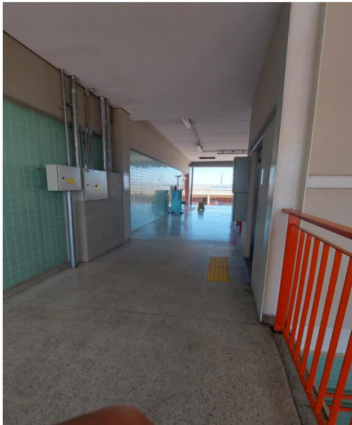
Foto 22 Elevador 5: Vista do corredor, sem CFTV
