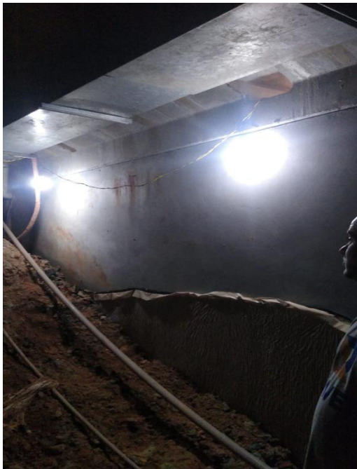
Foto 11: Escavação do talude em direção a tubulação com vazamento
