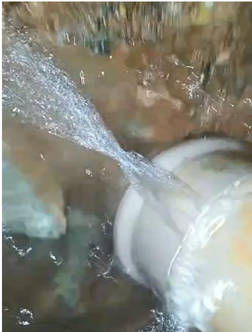
Foto 21: Tubulação com vazamento
