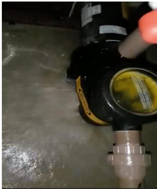
CT 1267 C 1 PiscInf Hidr - Manutenção Urgente Bomba da Piscina - Video A1
