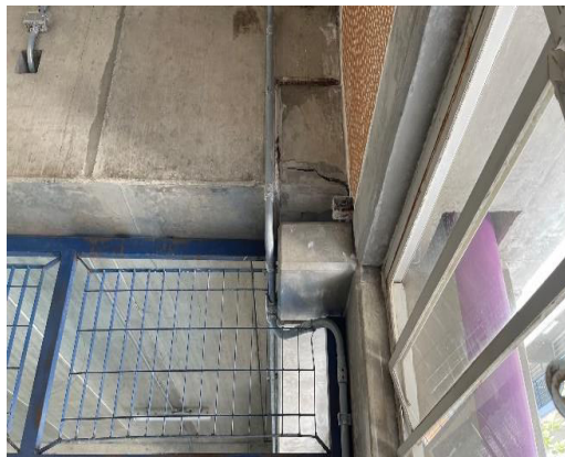
Trinca - Estrutura na piscina interna - 09.03.23
