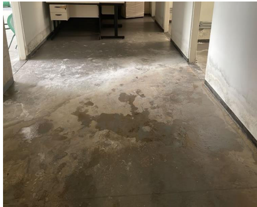
Manchas no piso causadas pela umidade no solo.
