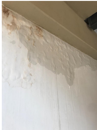
AA 1178 C T PiscInter ObrCiv - Relatório de Vistoria - Vazamento piscina interna - Foto A5
