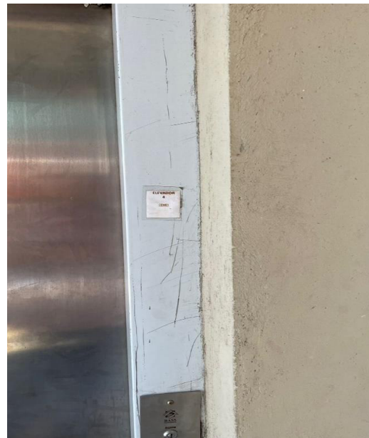
Foto 10 Elevador 4 CEMEI – Elevador externo com infiltração por deficiência de impermeabilização da laje e paredes
