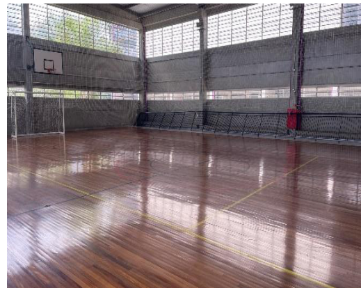
Quadra - Gradil solto - 09.03.23
