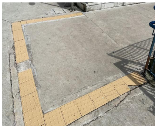
Trinca entre a junção da passarela metálica e o piso de concreto.
