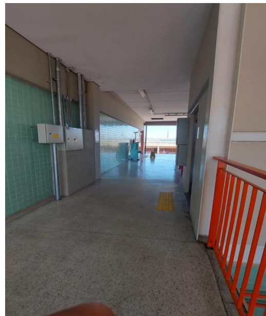
Foto 21 Elevador 5: Vista do corredor, sem CFTV
