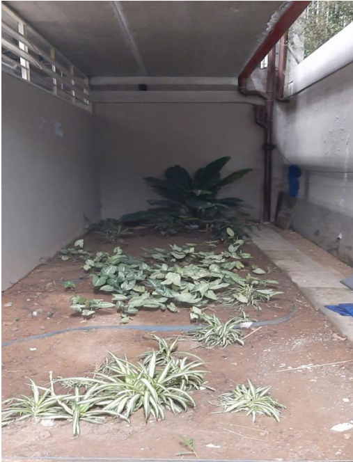
Foto 5: Jardim ao lado da sala de limpeza, localização da tubulação com vazamento
