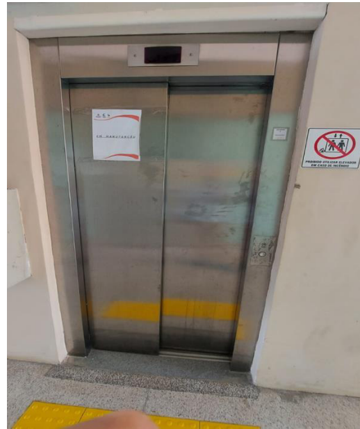
Foto 19 Elevador 5: Vista frontal do elevador
