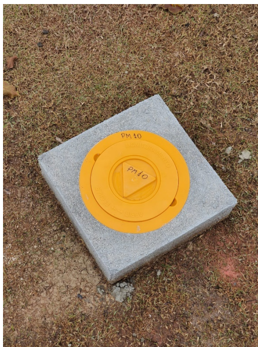
Foto 30 – Poço de Monitoramento 10
