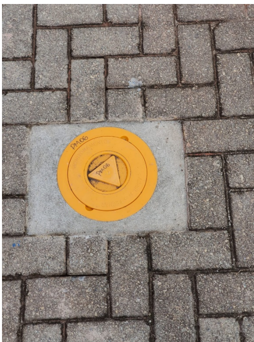
Foto 20 – Poço de Monitoramento 06
