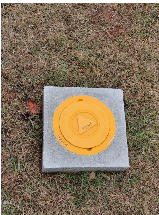
Foto 2 – Poço de Monitoramento 01
