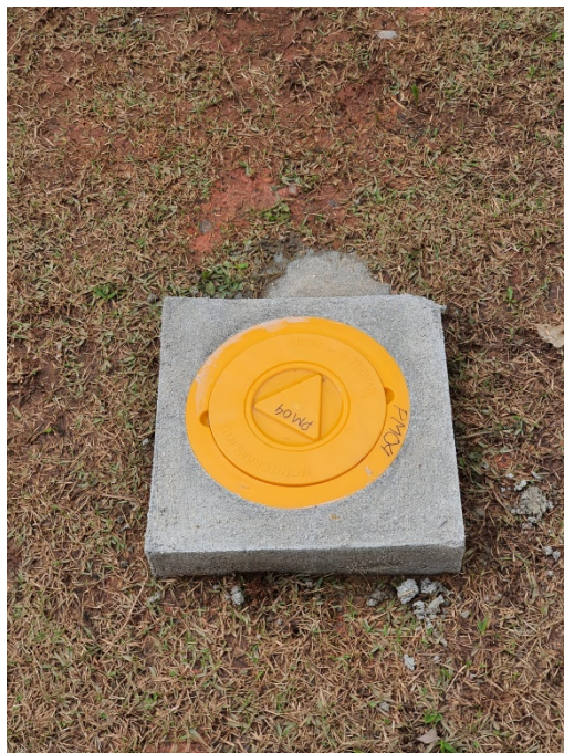
Foto 13 – Poço de Monitoramento 04
