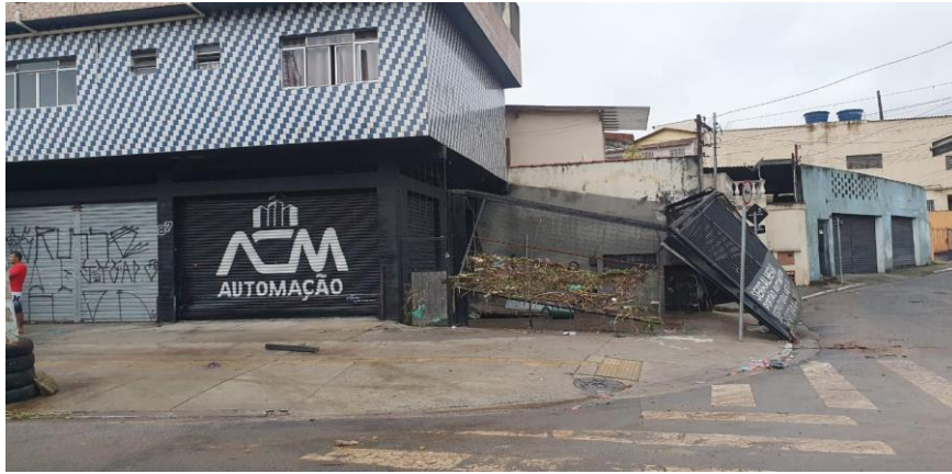
Foto 4 – SIGRC 30182686 - Alagamento - Rua João Ribeiro Pereira, 112 - Jd Belem
