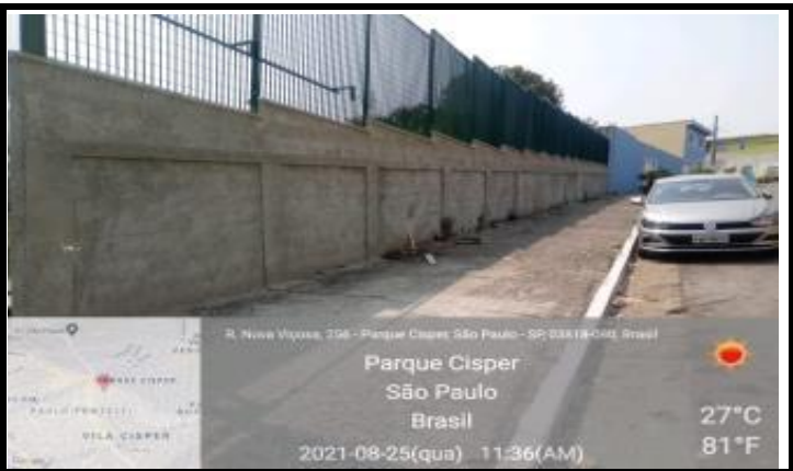
Rua Nova Viçosa Nº 301 (muro do Estacionamento)
