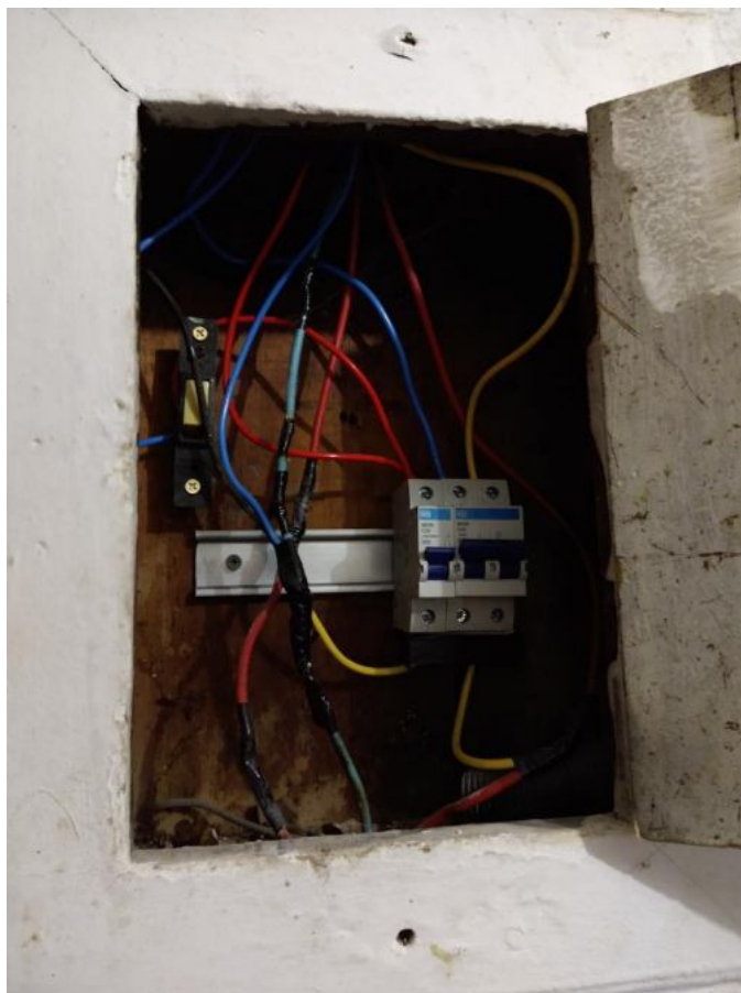
Foto 11. Instalações elétricas: observar o quadro de energia, localizado em 2º pavimento.
