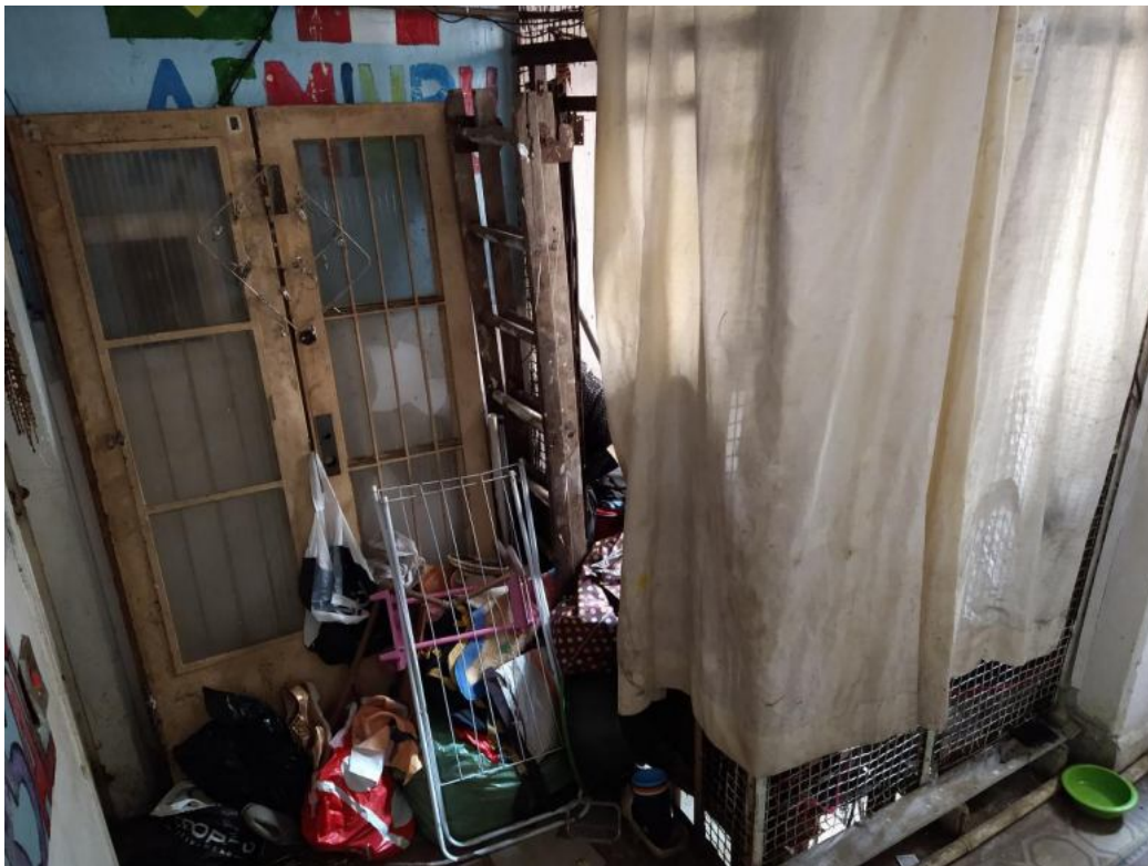
Foto 8. Condições de segurança: observar o excesso de material em poço de elevador.
