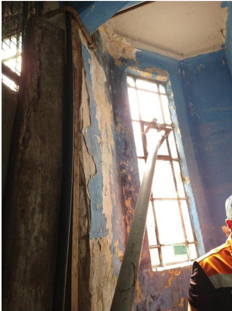
Foto 5. Manifestações patológicas: observar a falta de impermeabilização e destacamento do revestimento em área interna.
