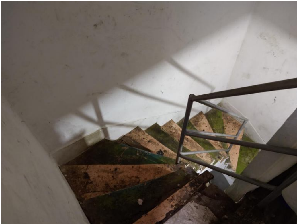
Foto 6. Condições de segurança: observar os degraus de madeiras em péssimas condições de utilização.
