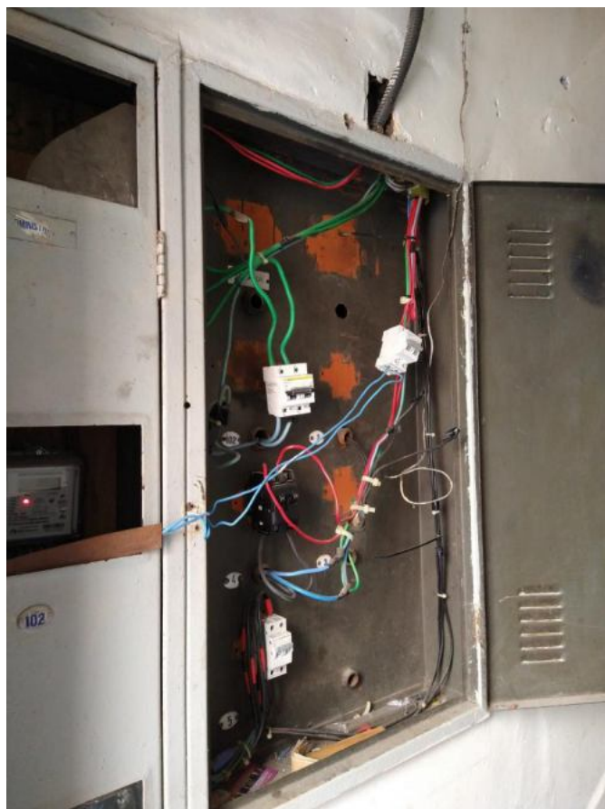
Foto 12. Instalações elétricas: observar o quadro de energia com disjuntores desorganizados, localizado na entrada do imóvel.
