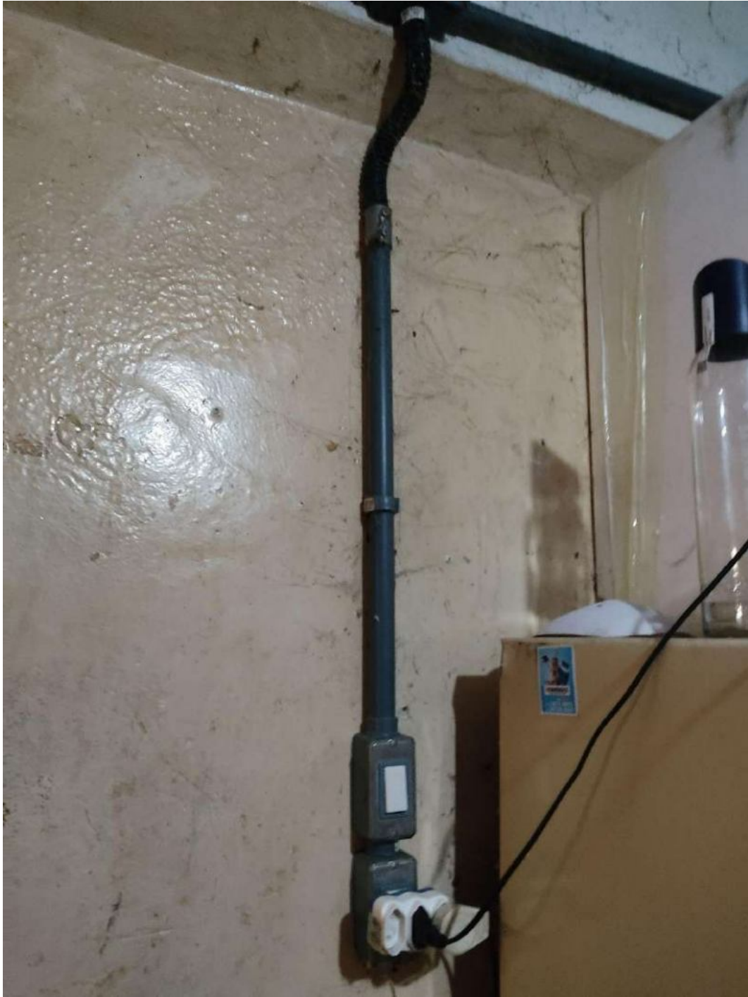
Figura 11: tubulação de energia no interior de uma das unidades, devidamente instalada e isolada.
