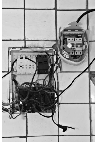
FOTO 2 – Quadro com vários circuitos ligados a poucos disjuntores
