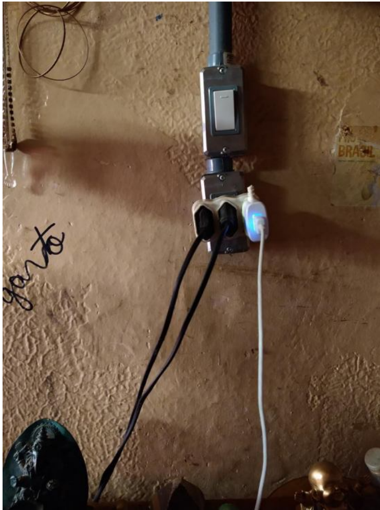
Foto 9. Condições de segurança: observar a presença recorrente de benjamin.
