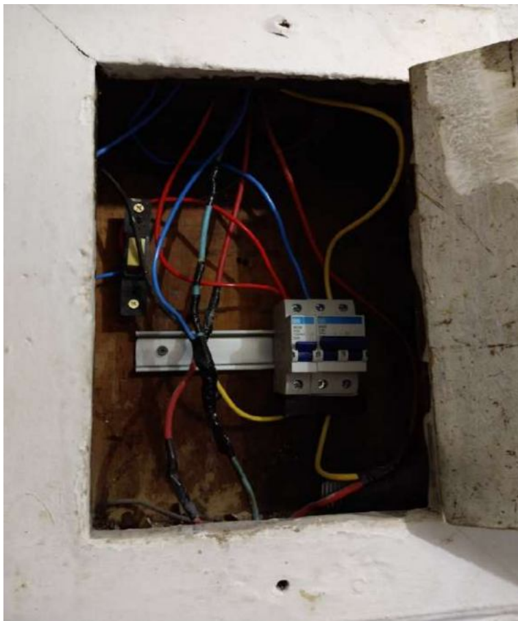
Figura 7: quadro de energia com disjuntor instalado no segundo pavimento.
