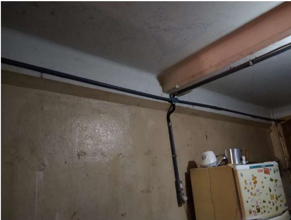
Figura 6: Fios elétricos acomodados em condutores.
