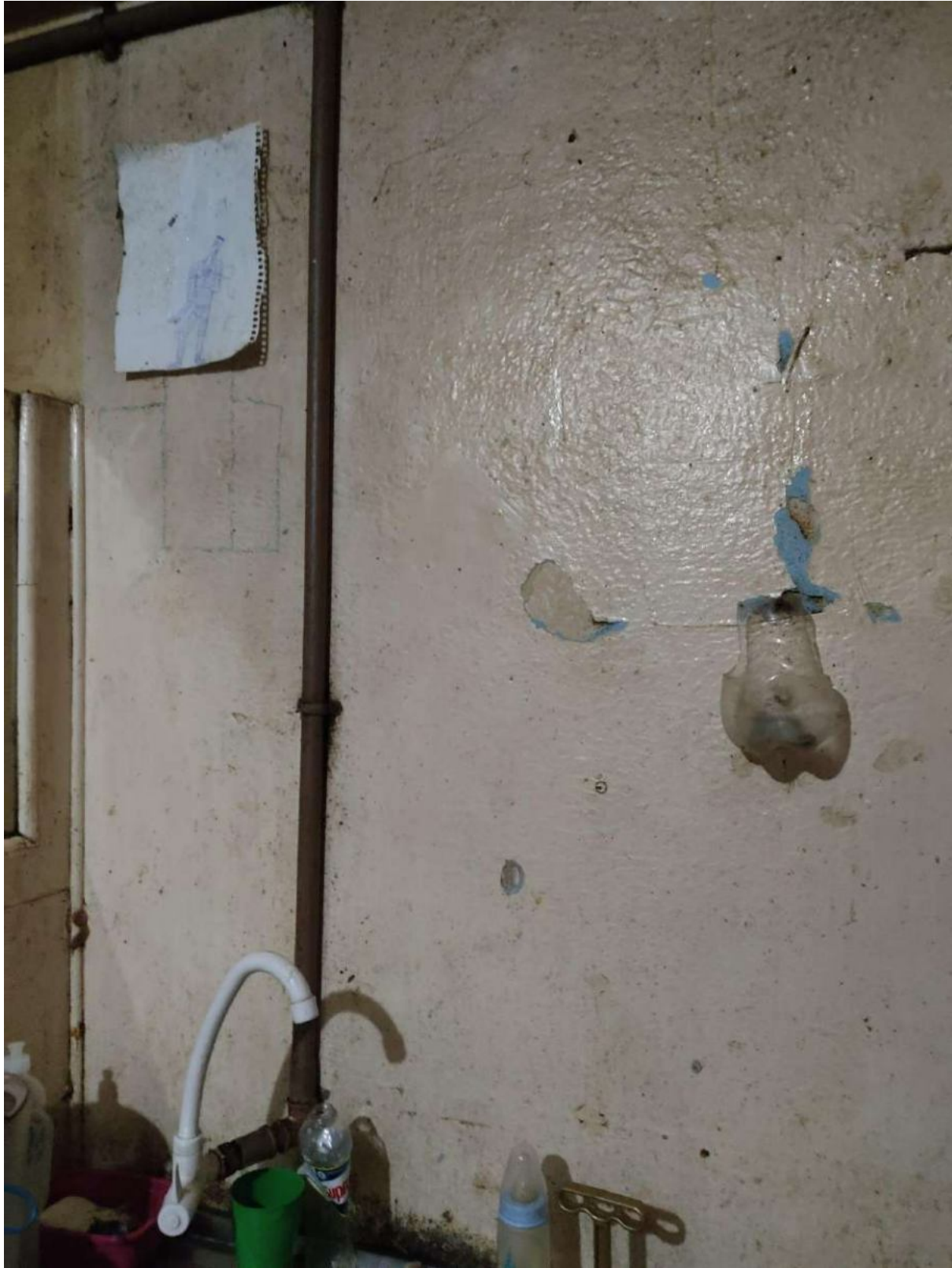
Figura 10: tubulação de água no interior de uma das unidades.
