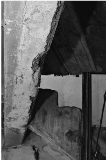
FOTO 1 – Exposição de armadura da viga, reforço estrutural da escada.
