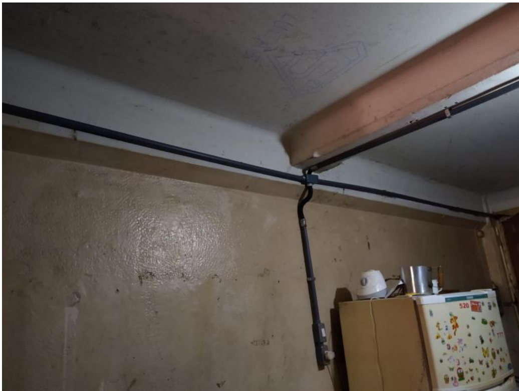
Foto 10. Instalações elétricas: observar o acondicionamento da fiação em eletroduto.
