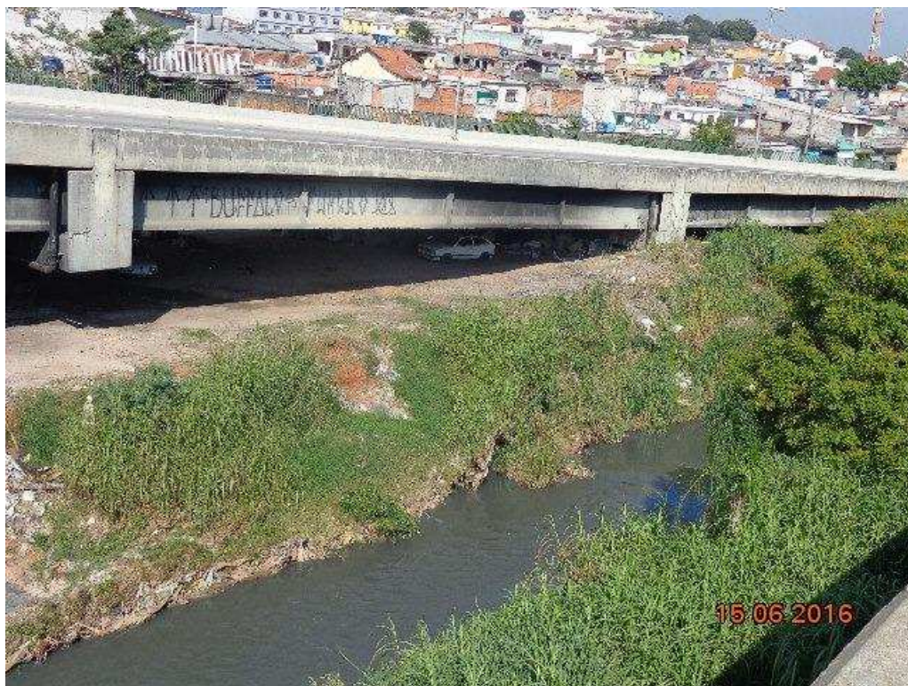
trecho onde o rio alaga Avenida Musgo de flor.
