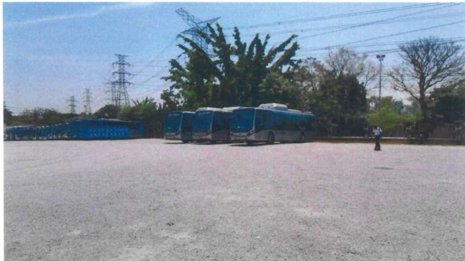
Infraestrutura de recarga da Frota Piloto instalada na operadora Transwolff, capacidade para 18 veículos.
