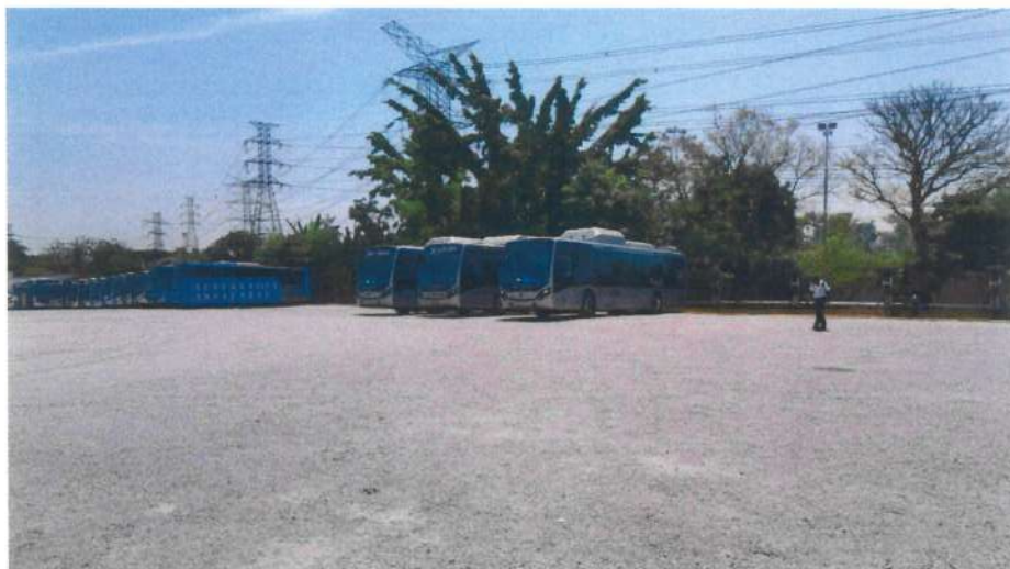
Infraestrutura de recarga da Frota Piloto instalada na operadora Transwolff, capacidade para 18 veículos.
