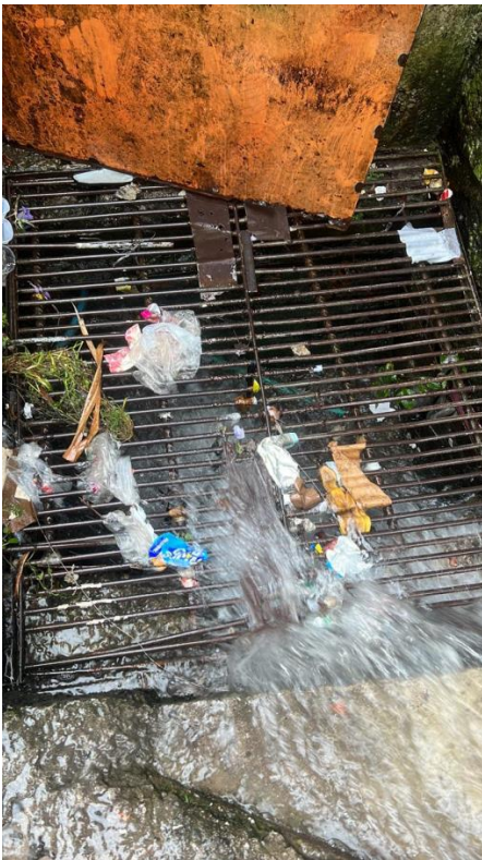
Acúmulo de lixo na galeria de águas pluviais.
