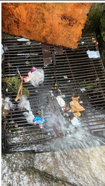
Acúmulo de lixo na galeria de águas pluviais.
