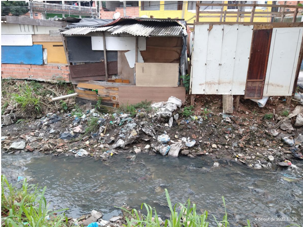
Foto 02 – Aspecto geral das edificações localizadas na rua José de Maistre, altura do número 456: observar a tubulação de lançamento de água servida.
