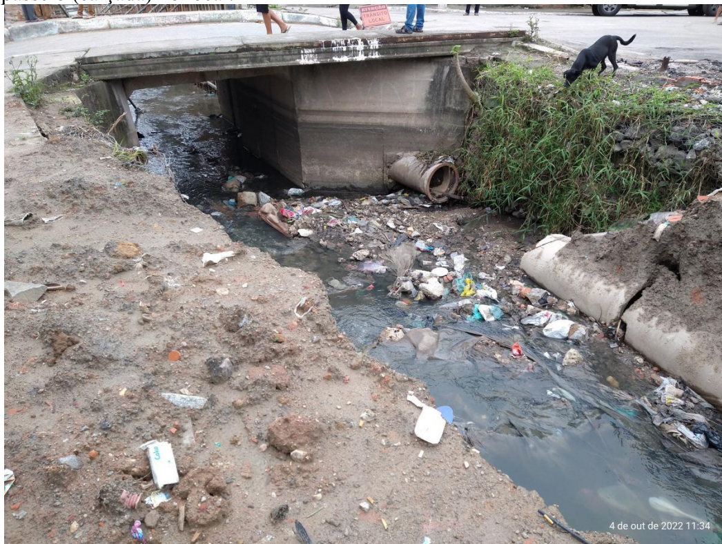
Foto 08 – Aspecto geral do córrego localizado na rua José de Maistre, altura do número 456: observar a necessidade de ações de zeladoria e manutenção da obra analisada.
