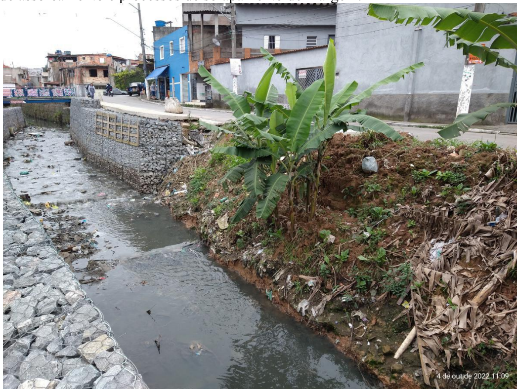
Foto 04 – Aspecto geral do córrego localizado na rua José de Maistre, altura do número 456: observar a presença de assoreamento e processos de solapamento de margem.
