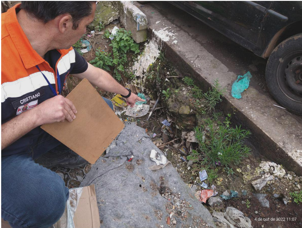
Foto 07 – Aspecto geral do córrego localizado na rua José de Maistre, altura do número 456: observar o colapso do passeio (calçada) no local.
