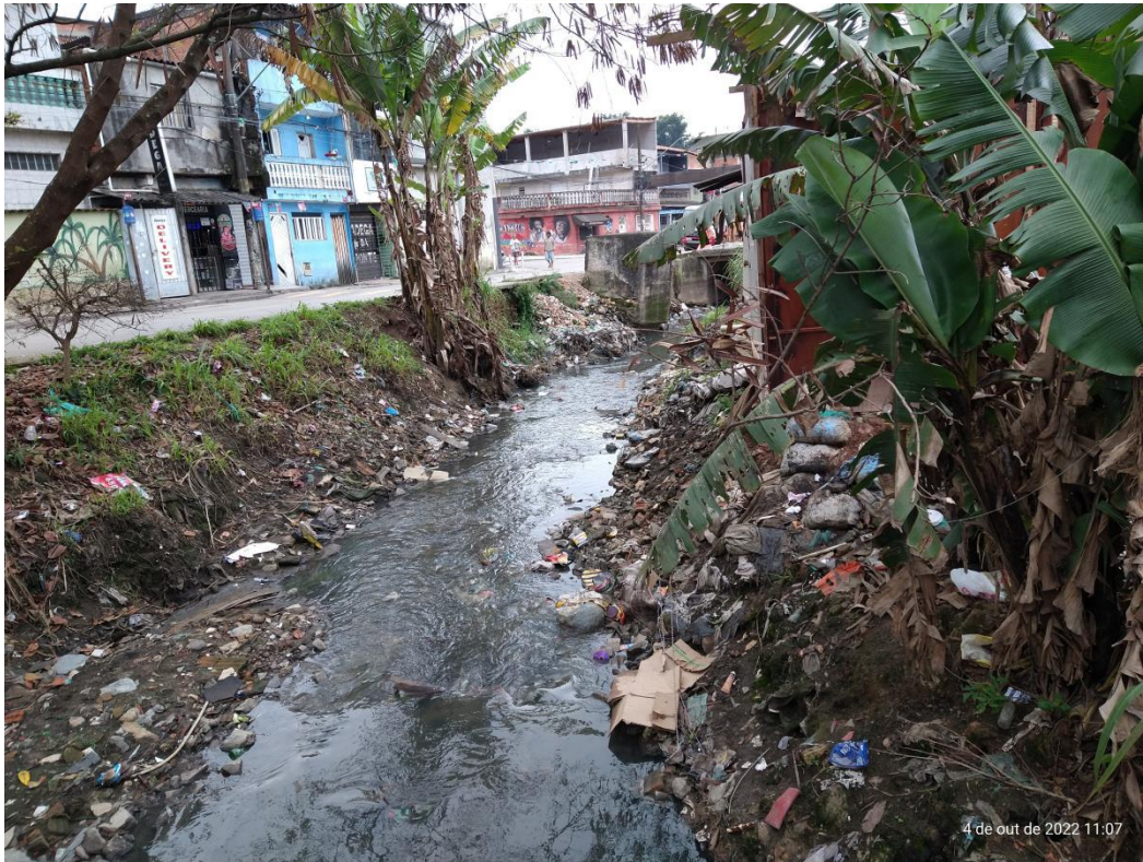
Foto 03 – Aspecto geral do córrego localizado na rua José de Maistre, altura do número 456: observar a presença de assoreamento e processos de solapamento de margem.
