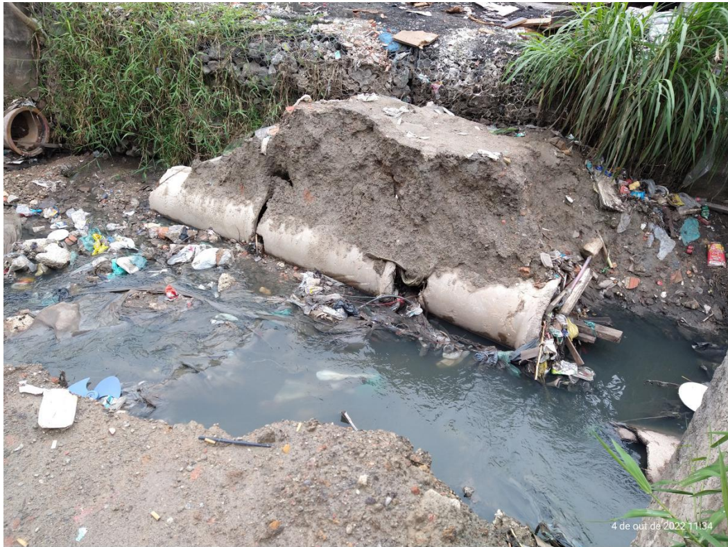
Foto 05 – Aspecto geral do córrego localizado na rua José de Maistre, altura do número 456: observar a presença de assoreamento e lançamentos de lixo e entulho.
