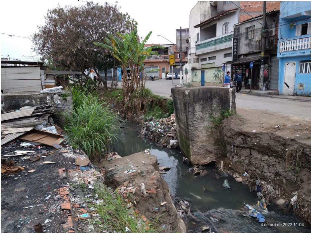
Foto 06 – Aspecto geral do córrego localizado na rua José de Maistre, altura do número 456: observar o colapso da estrutura de antiga ponte no local.
