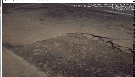
3 | INSPEÇÃO: Item de OS RECORTE 6229186 (02/09/22 08:38 MXINTADM)
