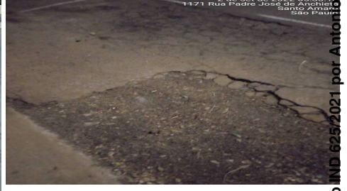
3 | INSPEÇÃO: Item de OS RECORTE 6229186 (02/09/22 08:38 MXINTADM)
