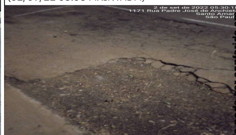
3 | INSPEÇÃO: Item de OS RECORTE 6229186 (02/09/22 08:38 MXINTADM)
