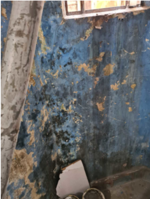
Infiltração na Parede
