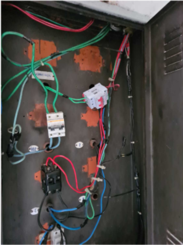
Quadro de Luz Irregular
