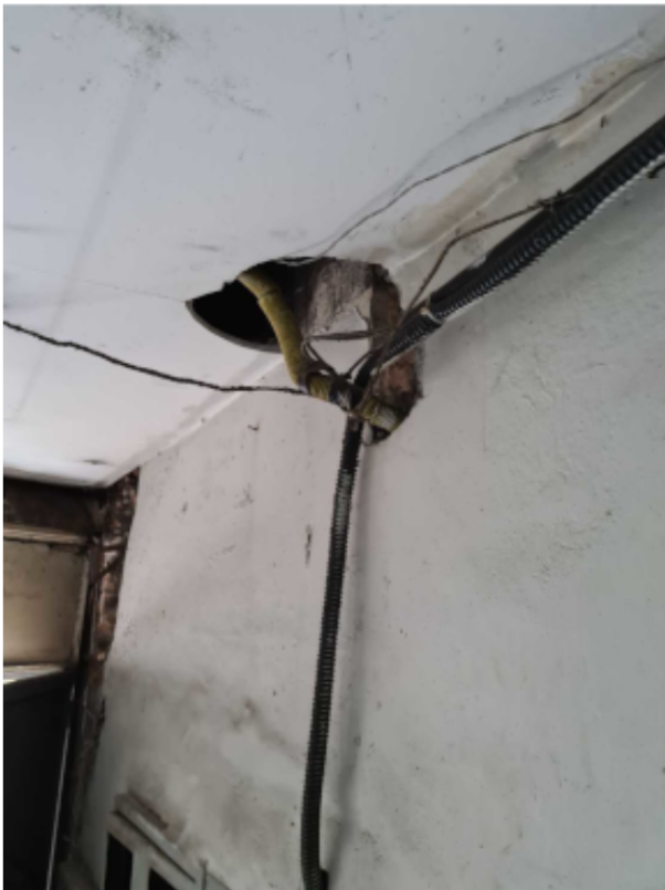
Instalações Elétricas Adaptadas
