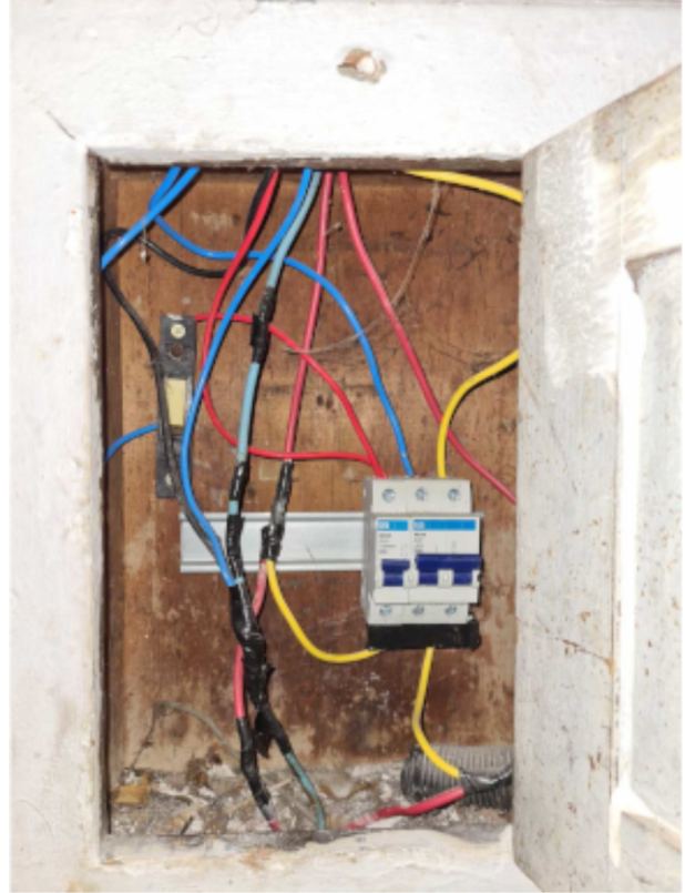
Quadro de Luz Irregular
