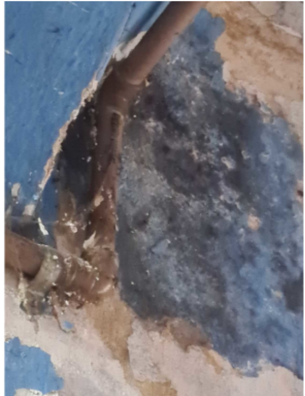
Infiltração no Teto
