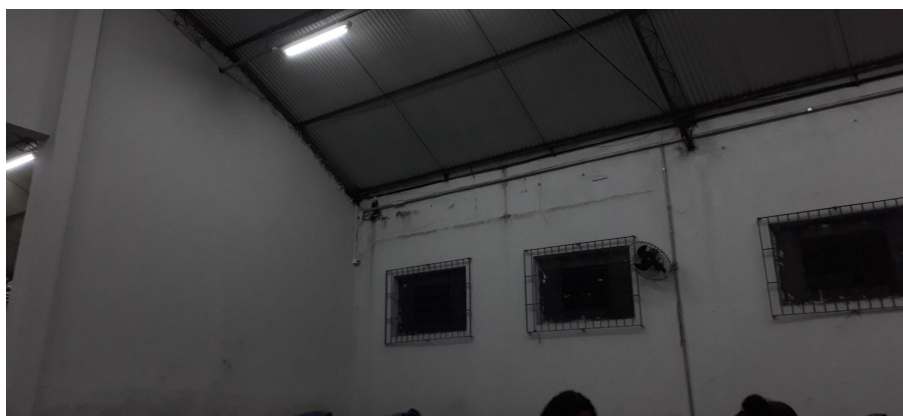
Figura 7: mancha de possível infiltração
