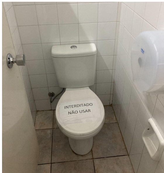
Figura 9: vaso sanitário interditado
