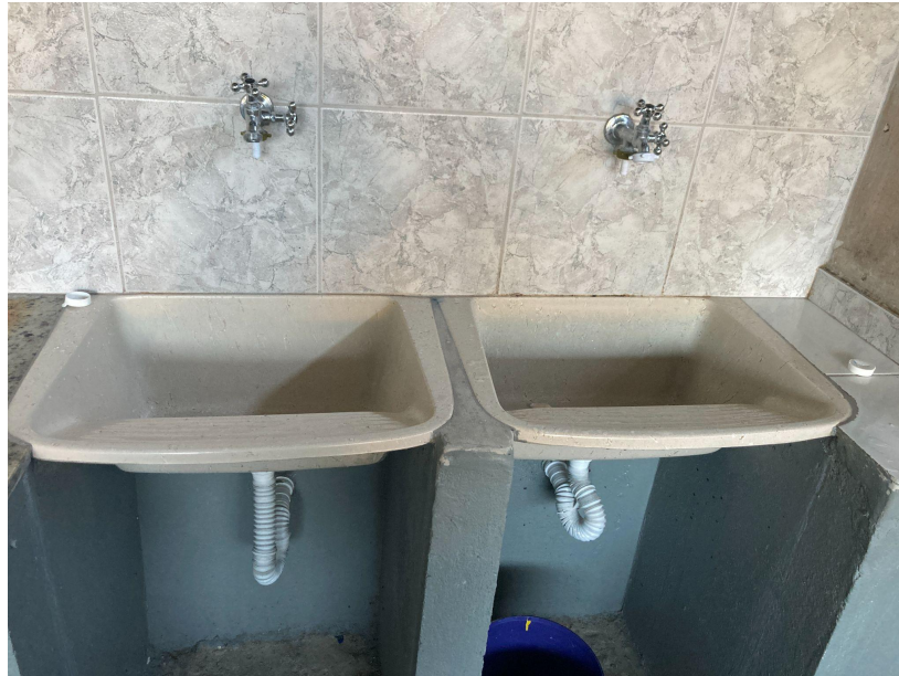
Figura 26: lavanderia com 2 tanques
