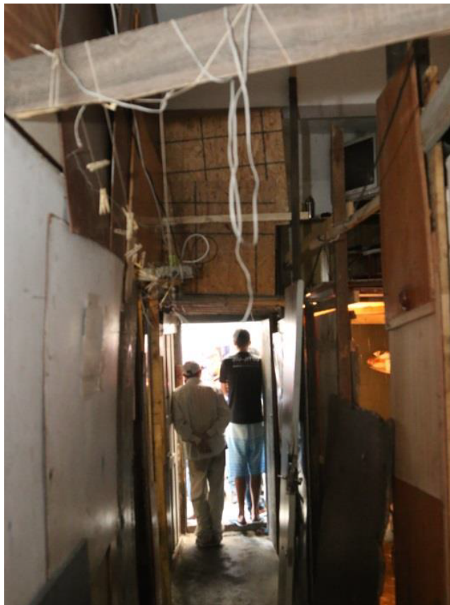
Figura 34: corredor de acesso da ocupação, com divisórias em madeira. Imagem extraída do relatório do COMDEC de 2021
