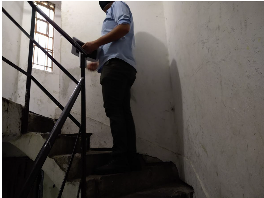
Figura 27:: guarda corpo metálico instalado entre o segundo e quinto pavimento. Imagem extraída do relatório do COMDEC de 2021
