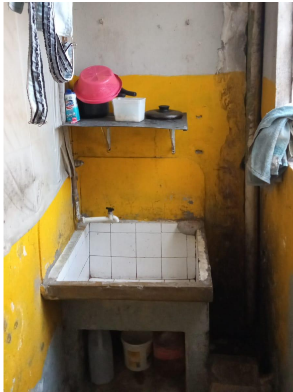
Figura 16: ponto de água, com infiltração nas laterais do cano.
