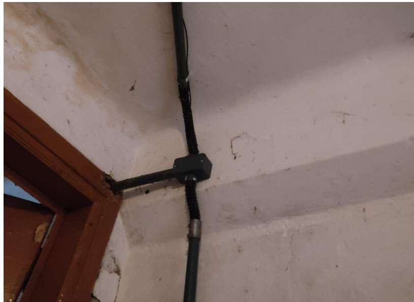
Figura 08: fiação elétrica acomodada em conduítes na entrada de uma das unidades.
