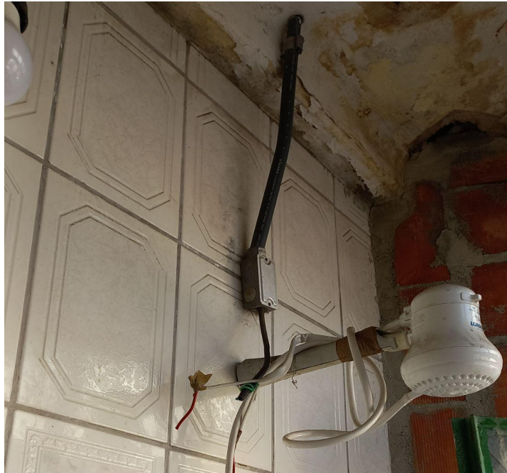
Figura 28: início do processo de acomodação da fiação elétrica, iniciada pelos próprios moradores, sem acompanhamento técnico.
