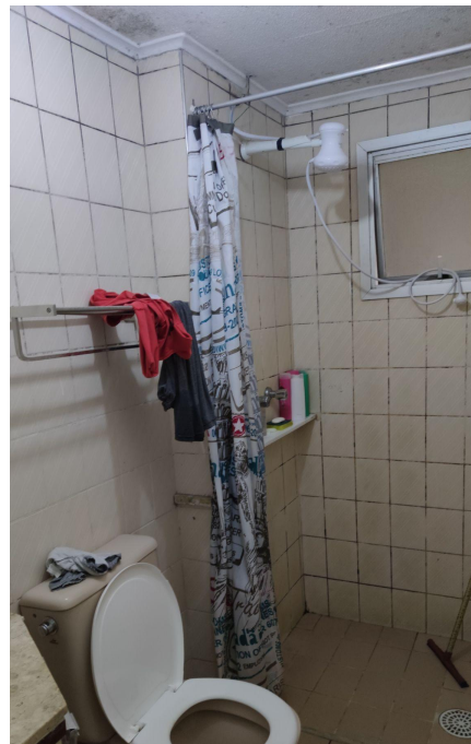
Figura 2: marcas de mofo no teto do banheiro
