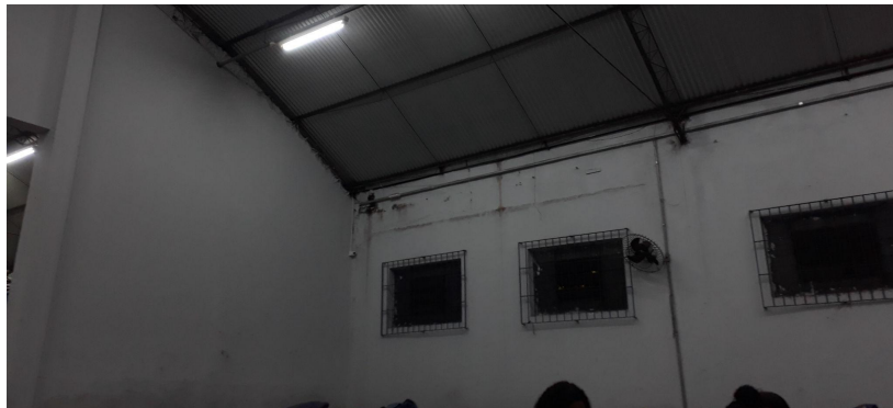
Figura 7: mancha de possível infiltração
