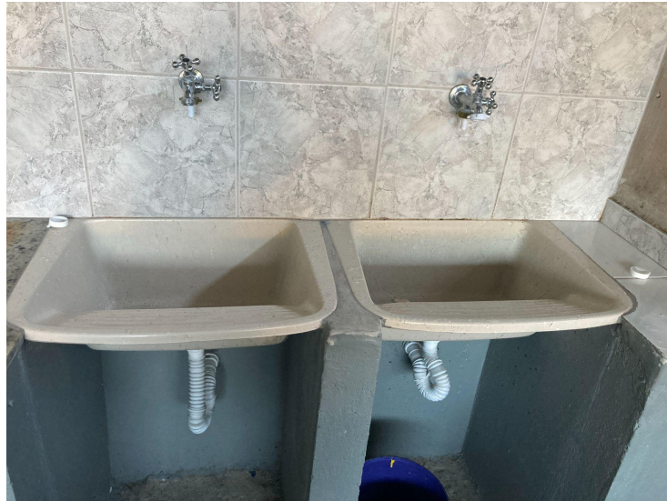
Figura 26: lavanderia com 2 tanques
