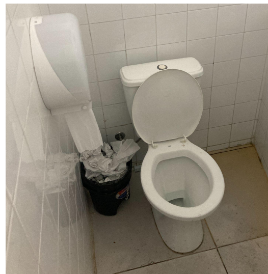
Figura 10: vaso sanitário sem assento
