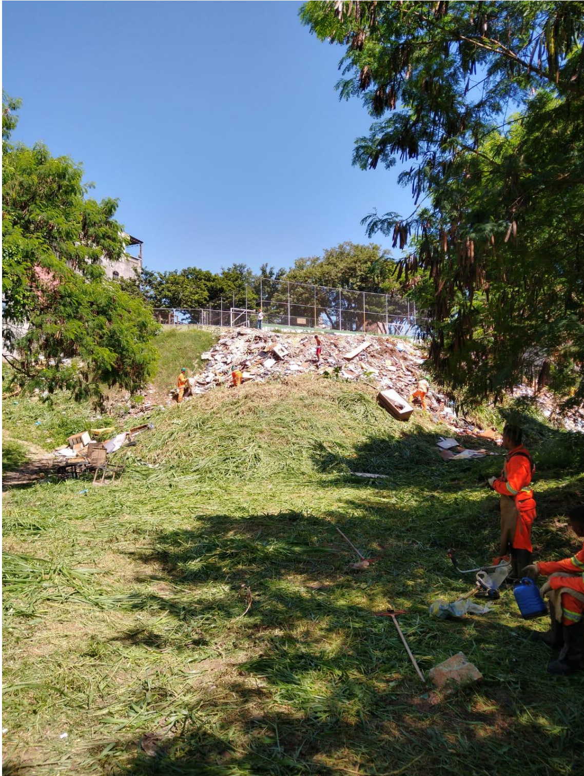
FIGURA 1 – Vista da área capinada e com entulho
