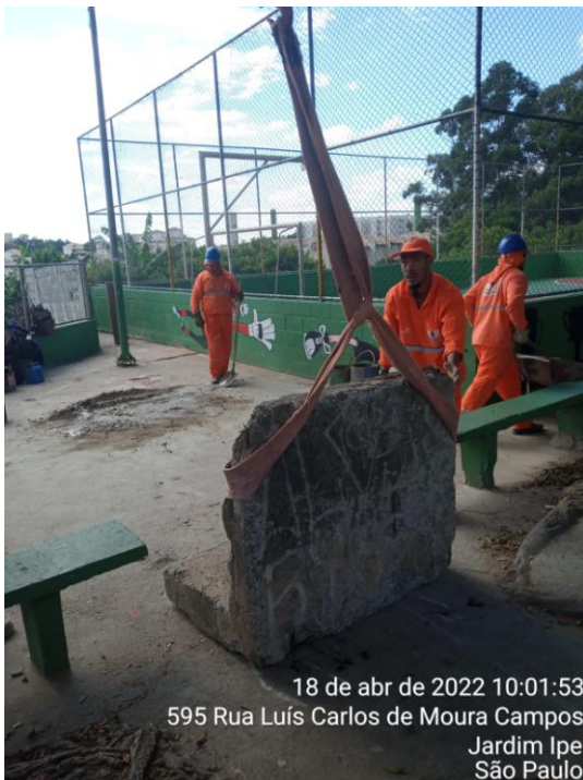
FIGURA 7 – Obstáculo de concreto “malotão” instalado no local para evitar a entrada com carrinho-de-mão
