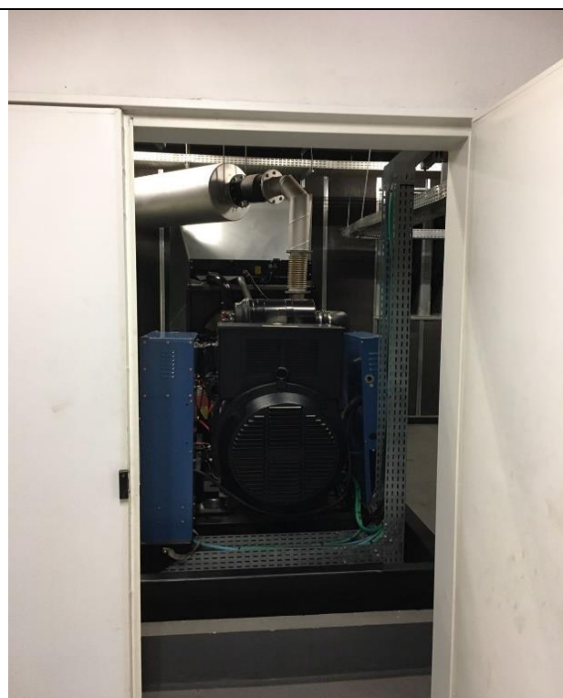
Foto 2 – Entrada Cabine do Gerador
