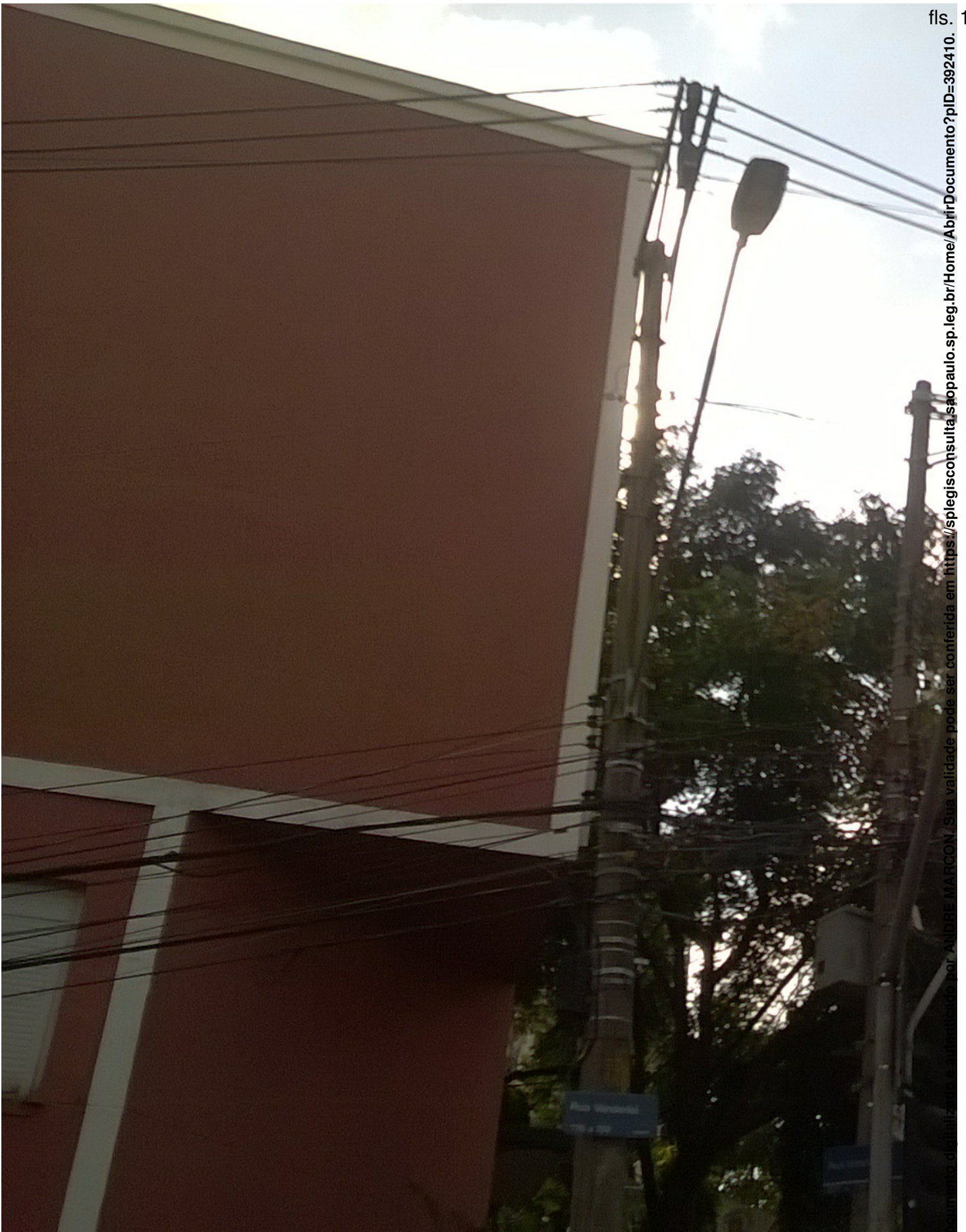
LUMINÁRIA DE LED 120 WATTS NA RUA WANDERLEI 750, ESQUINA COM RUA MINISTRO GODÓI 1384.
