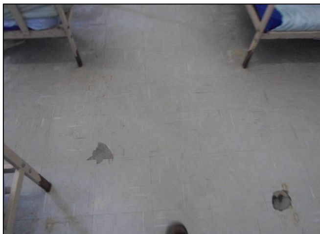
123 – PISO DANIFICADO NO DORMITÓRIO 05
