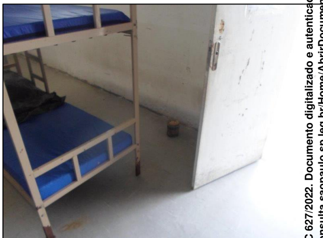
124 – MAÇANETA DANIFICADA NO ACESSO AO DORMITÓRIO 05
