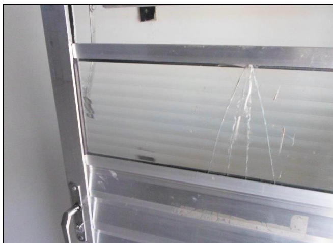
163 – VIDRO DANIFICADO E AUSÊNCIA DE TELA NA PORTA DE ACESSO À COZINHA
