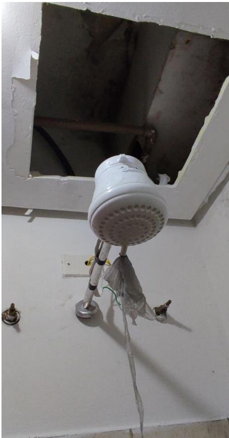
Figura 6: ausência de forro em um banheiro
