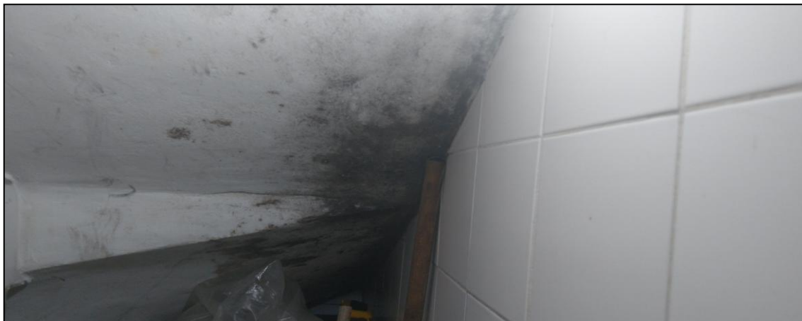
54. MANCHA INFILTRAÇÕES – ALMOX. LIMPEZA
