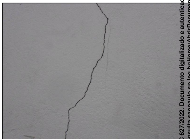
152 – SINAIS DE TRINCAS VERTICAIS NO DORMITÓRIO 06
