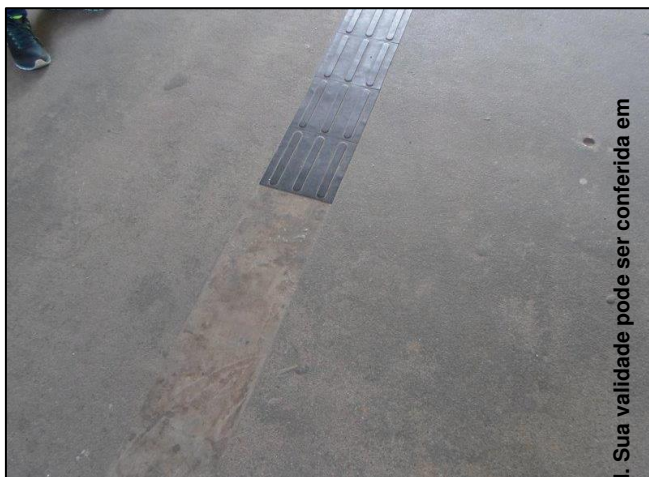
6 – AUSÊNCIA DE PLACAS DO PISO PODOTÁTIL
