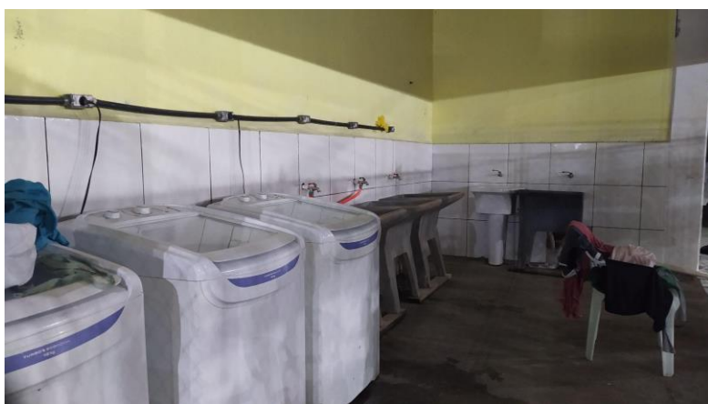
Figura 20: lavanderia - máquinas e tanques
