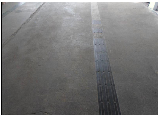
7 – AUSÊNCIA DE PLACAS DO PISO PODOTÁTIL
