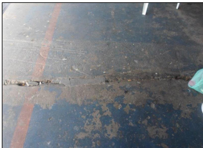
159 – PISO DANIFICADO DO REFEITÓRIO
