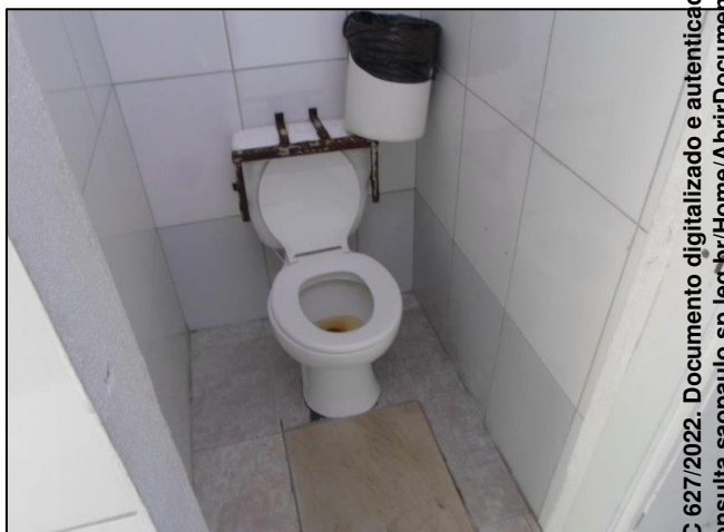
60 – BANHEIRO FEMININO – CABINE 0 TRAVA DE SEGURANÇA COM SINAIS DE FERRUGEM
