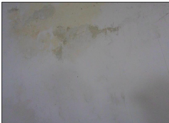
95 – SINAIS DE UMIDADE NA PAREDE LATERAL DO DORMITÓRIO 01
