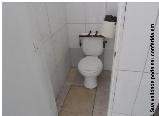
62 – BANHEIRO FEMININO – CABINE 03 TRAVA DE SEGURANÇA COM SINAIS D FERRUGEM
