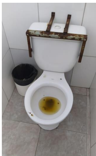
Figura 11: privada entupida e sem assento (banheiro feminino)
