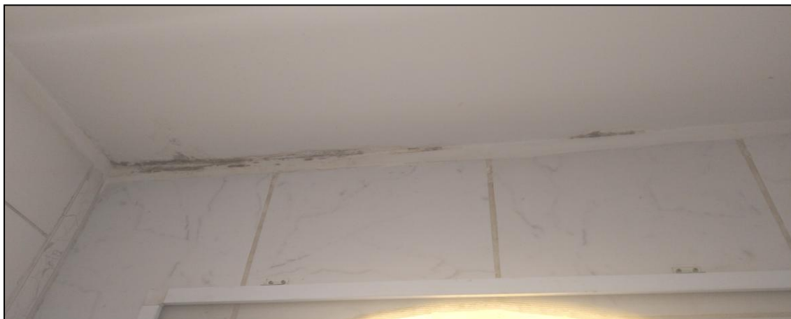
43. MANCHA INFILTRAÇÕES – COPA FUNCIONÁRIOS
