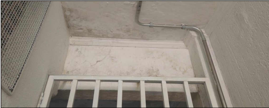
28. MANCHA INFILTRAÇÕES – CORREDOR LATERAL EXTERNO
