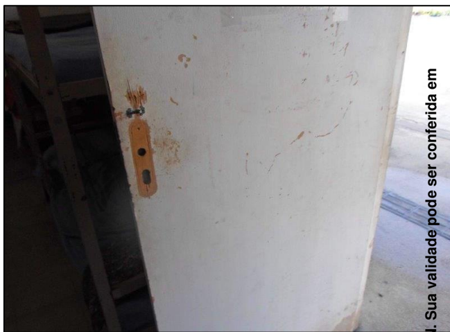
106 – MAÇANETA DANIFICADA NO DORMITÓRIO 02
