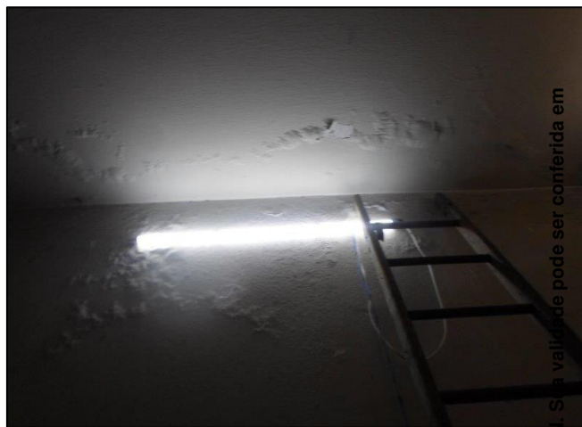
38 – INFILTRAÇÃO NA LAJE DO DEPÓSITO 01
