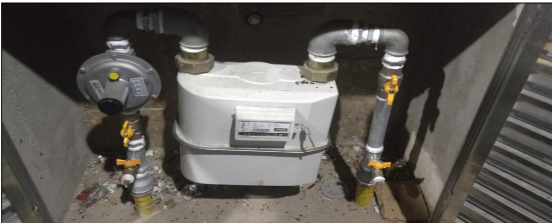
8. ABRIGO DO MEDIDOR DE GÁS NATURAL.
