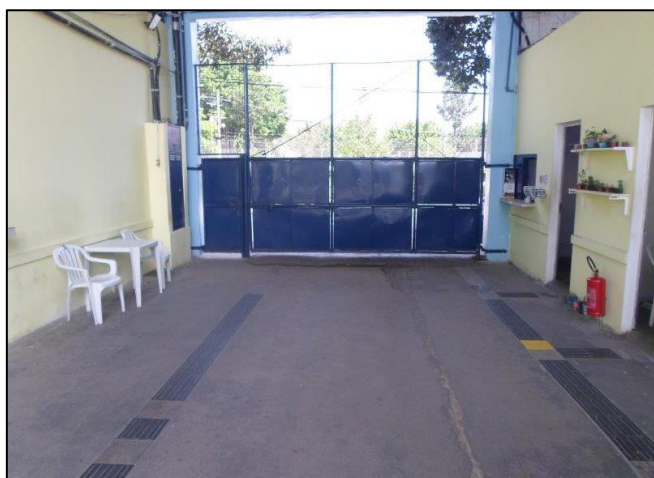
3 – ACESSO AO SERVIÇO – DETALHE PARA A AUSÊNCIA DE PLACAS DO PISO PODOTÁTIL
