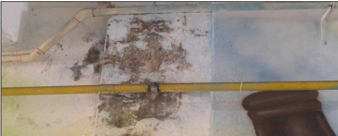
11. MANCHA INFILTRAÇÃO – CORREDOR LATERAL
