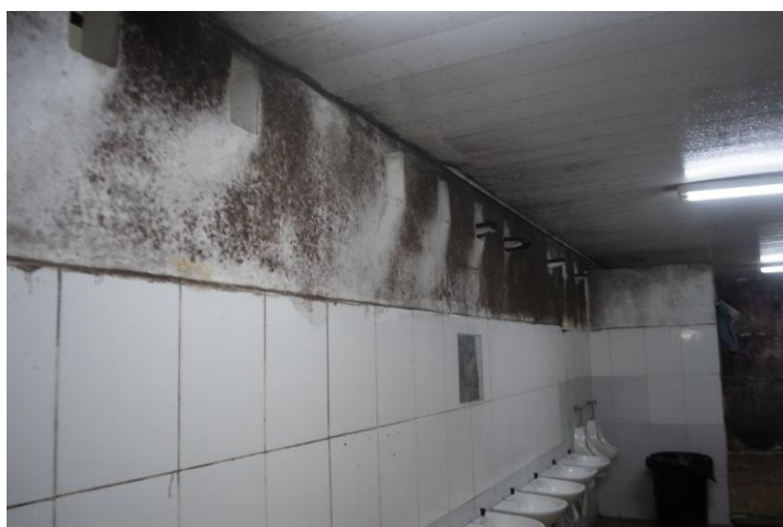
Figura 8: banheiro masculino com mofo nas paredes
