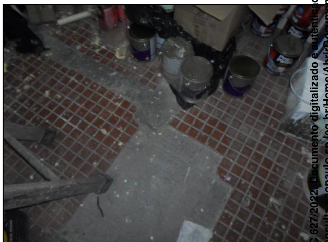
36 – PISO DANIFICADO NO DEPÓSITO 01
