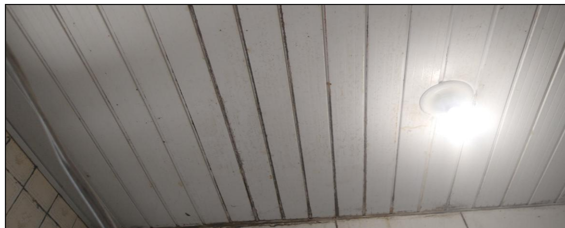
48. INFILTRAÇÕES NO FORRO BANHEIRO – DORMITÓRIO 210.
