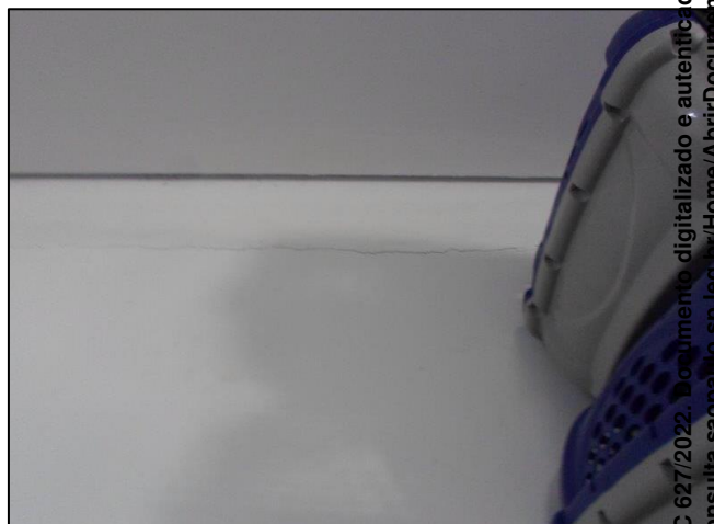
88 – TRINCAS HORIZONTAIS NO DEPÓSITO 03
