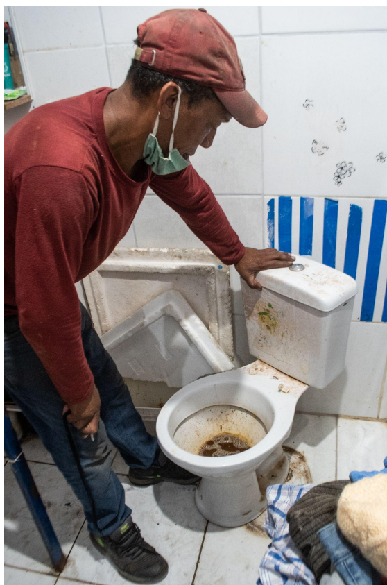
Figura 9: privada quebrada e entupida
