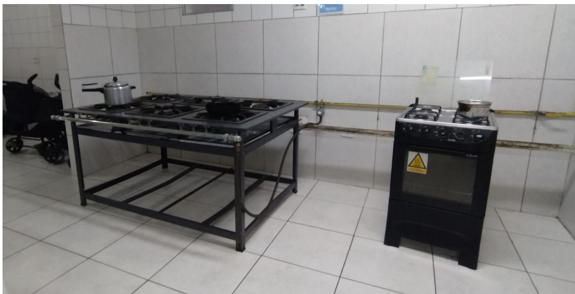
Figura 10: fogões - 6 bocas no industrial, 4 bocas e 1 forno
