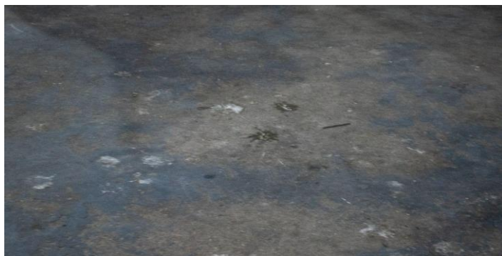
Figura 21: detalhe das fezes de pombos no refeitório
