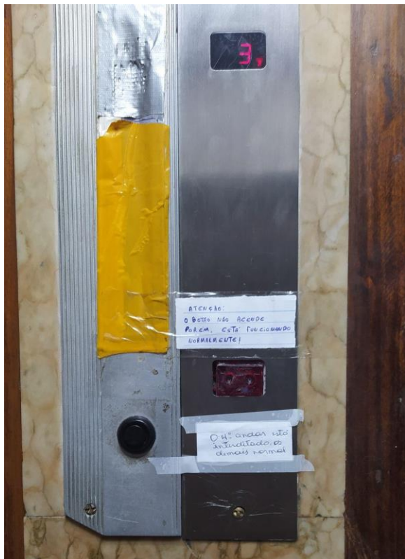
Figura 17: elevador em funcionamento (térreo)
