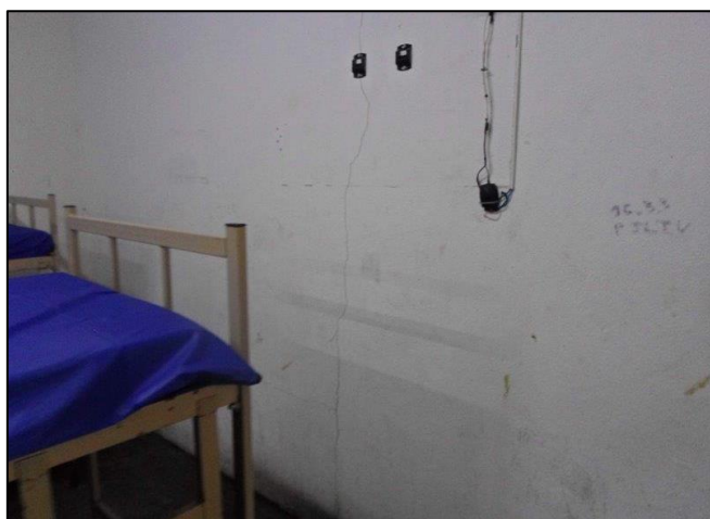
151 – DORMITÓRIO 06 – AUSÊNCIA DE VENTILAÇÃO
