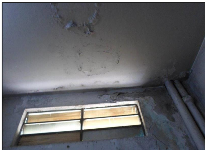
37 – INFILTRAÇÃO NA LAJE DO DEPÓSITO 01
