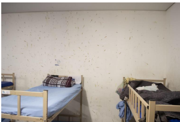
Figura 5: marcas de muquiranas (percevejos) nas paredes
