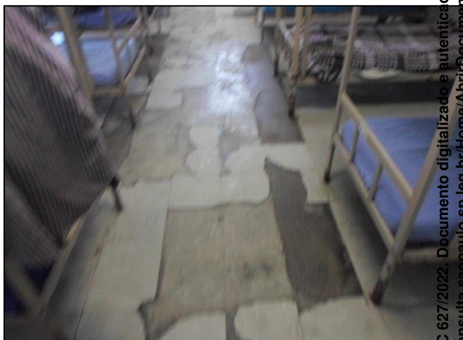
96 – PISO DANIFICADO DORMITÓRIO 01
