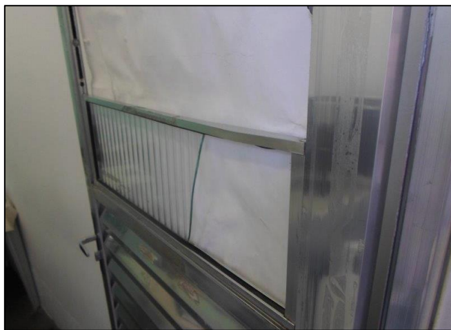
13 – VIDRO DANIFICADO NA PORTA DE ACESSO À SALA DE ATENDIMENTO 02
