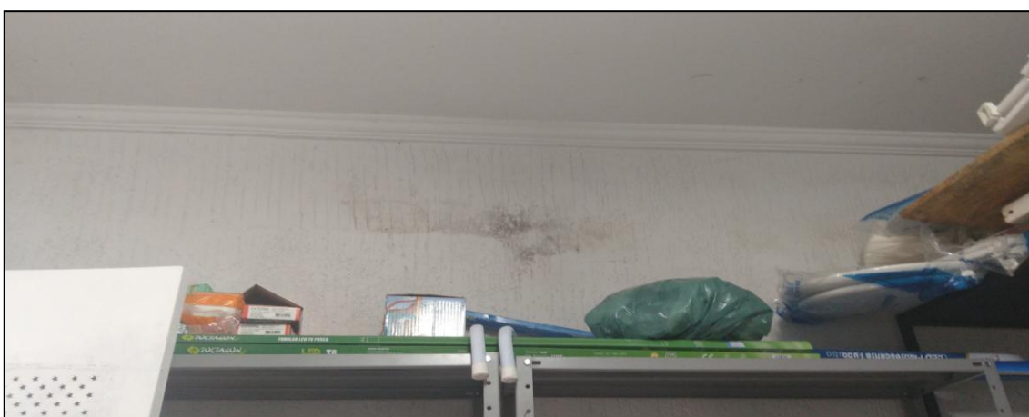
27. MANCHA INFILTRAÇÕES - ALMOXARIFADO
