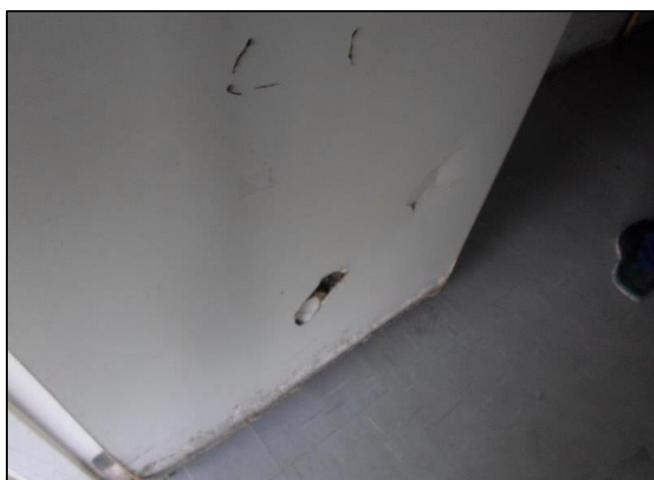
109 – PORTA DANIFICADA NO DORMITÓRIO 03
