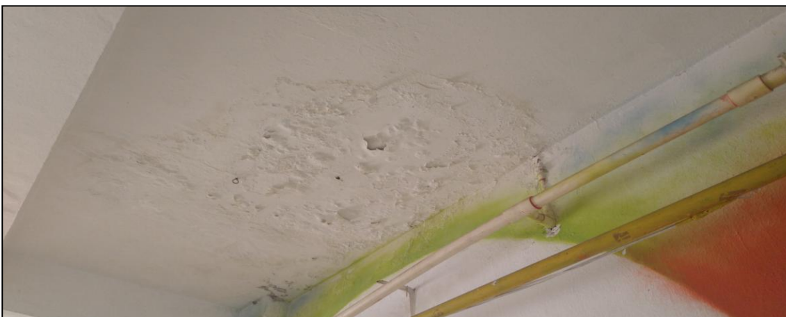
12. MANCHA INFILTRAÇÃO – CORREDOR LATERAL
