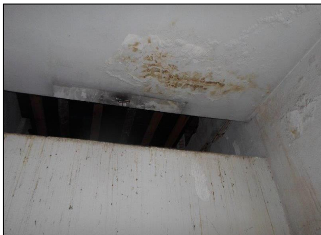
39 – INFILTRAÇÃO NA LAJE DO DEPÓSITO 01
