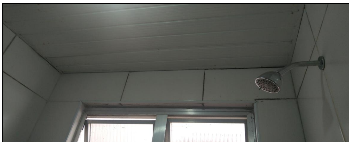
38. VÃO ENTRE O FORRO E ALVENARIA – DORMITÓRIO 116
