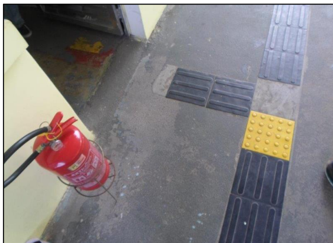
11 – AUSÊNCIA DE PLACAS DO PISO PODOTÁTIL
