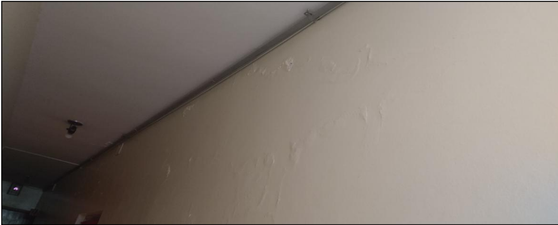
31. DESCOLAMENTO DA PINTURA – CORREDOR 1 ° ANDAR
