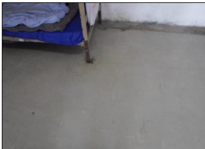
111 – DORMITÓRIO 03 – DETALHE PARA OS BELICHES COM SINAIS DE FERRUGEM
