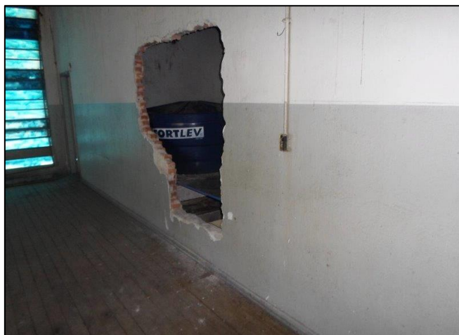
29 – DETALHE PARA O ACESSO IMPROVISADO NA ALVENARIA COM A FINALIZADE DE ACESSAR AS CAIXAS D'ÁGUAS
