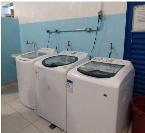
Figura 15: máquinas de lavar
