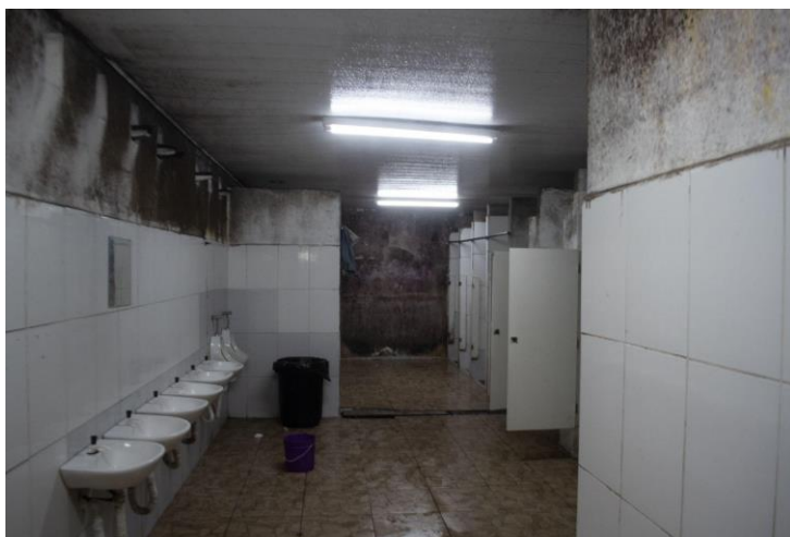
Figura 7: banheiro masculino com mofo nas paredes
