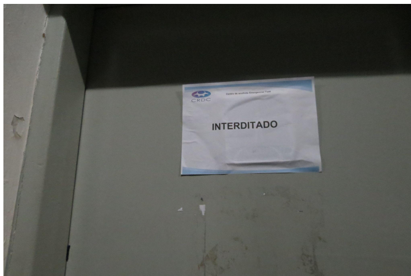
Figura 11: banheiro PCD interditado
