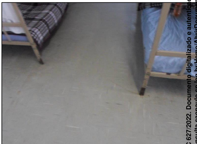
112 – DORMITÓRIO 03 – DETALHE PARA OS BELICHES COM SINAIS DE FERRUGEM
