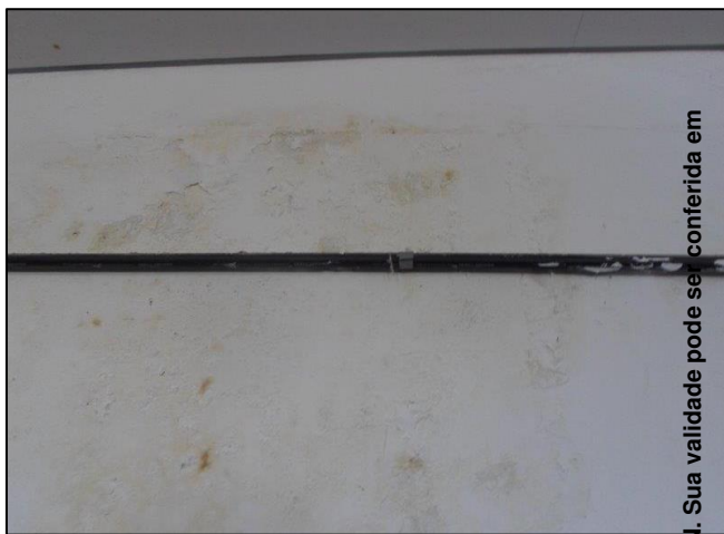
94 – SINAIS DE UMIDADE NA PAREDE LATERAL DO DORMITÓRIO 01
