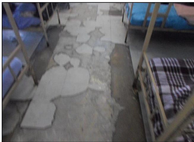
97 – PISO DANIFICADO NO DORMITÓRIO 01
