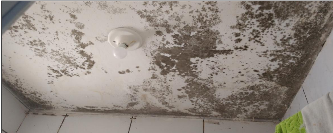
52. MANCHAS PROVENIENTES DO VAPOR, BANHEIRO – DORMITÓRIO 105
