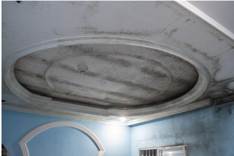
Figura 2: mofo no teto de quarto
