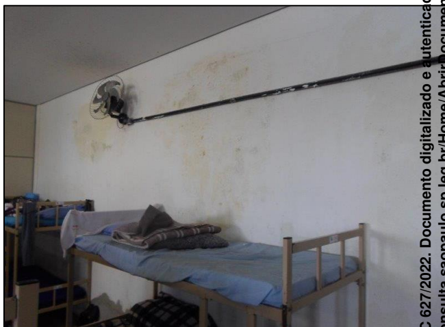
92 – SINAIS DE UMIDADE NA PAREDE LATERAL DO DORMITÓRIO 01
