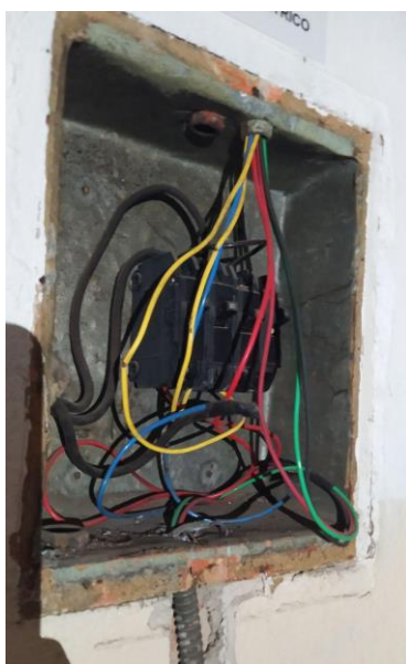
Figura 2: quadro elétrico exposto (6º andar)
