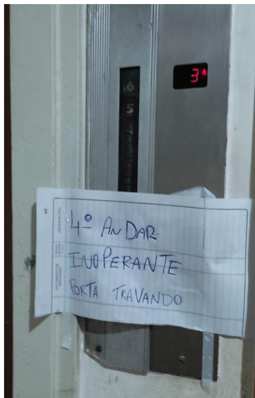
Figura 18: 4º andar inoperante (elevador em funcionamento)
