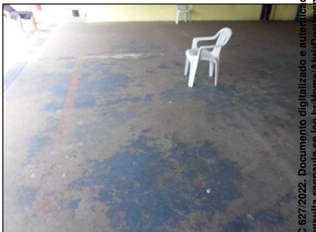
160 – PISO DANIFICADO DO REFEITÓRIO
