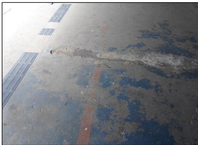
161 – PISO DANIFICADO DO REFEITÓRIO
