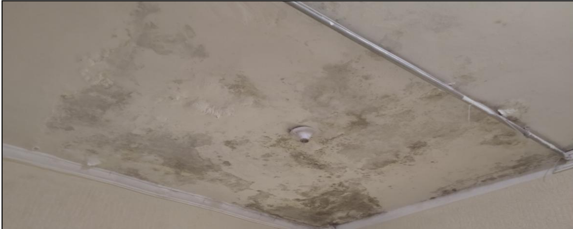
19. MANCHA INFILTRAÇÕES - LAVANDERIA
