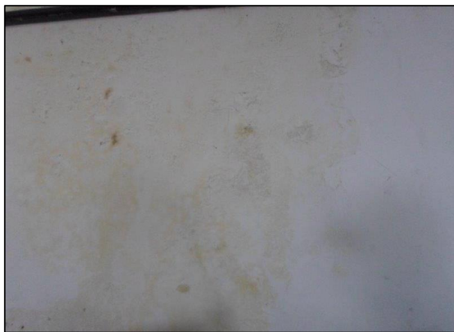
93 – SINAIS DE UMIDADE NA PAREDE LATERAL DO DORMITÓRIO 01
