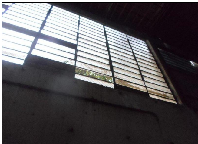
23 – AUSÊNCIA DE VIDROS NA JANELAS DO DEPÓSITO 01
