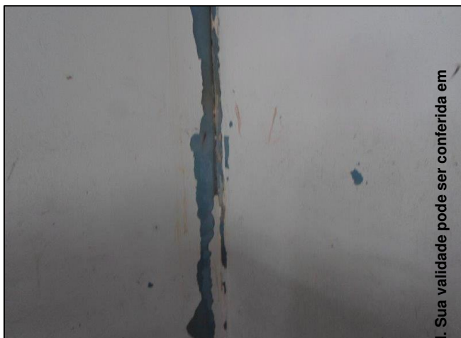
122 – SINAIS DE TRINCAS VERTICAIS NA PAREDE DO DORMITÓRIO 05
