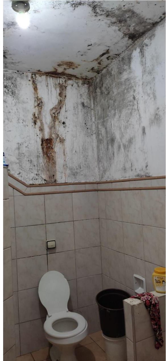
Figura 9: mofo no teto do banheiro
