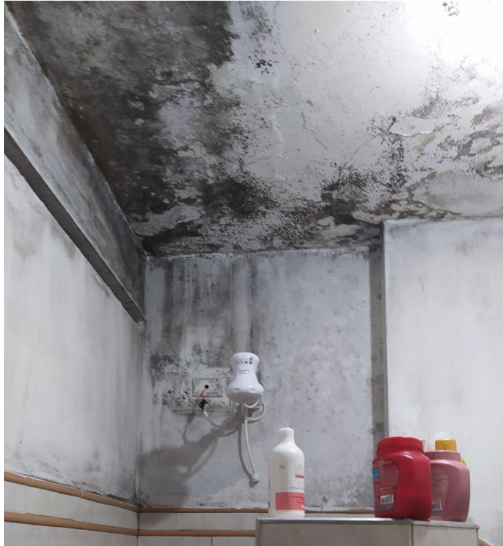
Figura 10: mofo no teto do banheiro
