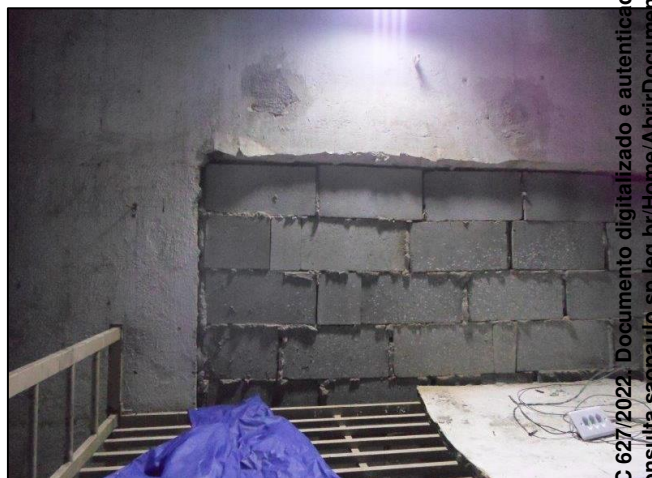
76 – PAREDE SEM ACABAMENTO NO DEPÓSITO 02
