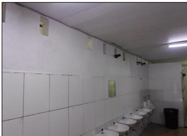
51 – DETALHE PARA FALTA DE VENTILAÇÃO DO BANHEIRO MASCULINO
