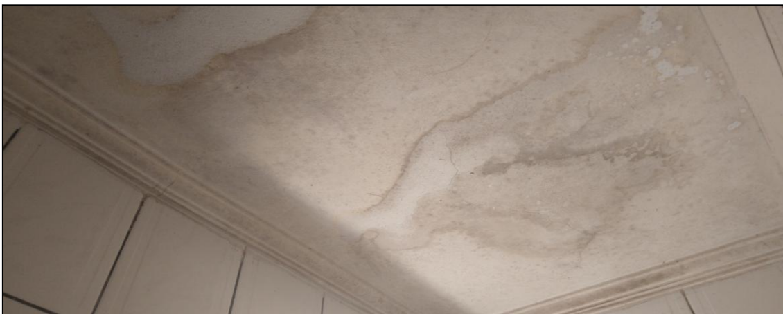
24. MANCHA PROVENIENTES DO VAPOR – BANHEIRO ACESSÍVEL
