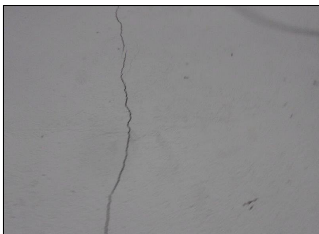
153 – DORMITÓRIO 06 – SINAIS DE TRINCAS VERTICAIS NA PAREDE
