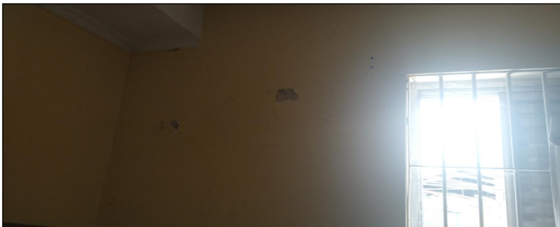
32. DESCOLAMENTO PINTURA DORMITÓRIO 128.
