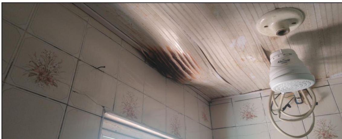
34. FORRO DE PVC DANIFICADO – DORMITÓRIO 127
