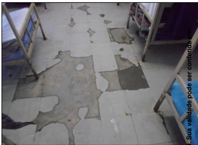
98 – PISO DANIFICADO NO DORMITÓRIO 01
