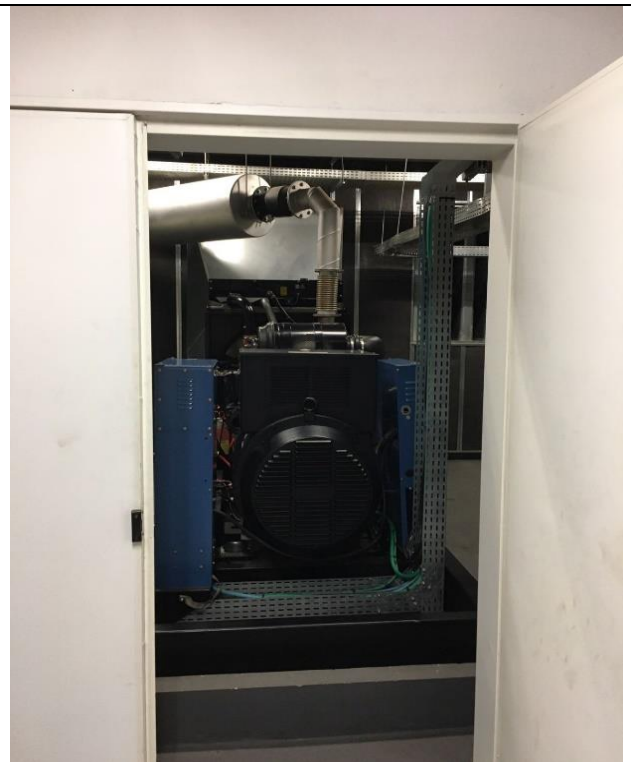
Foto 2 – Entrada Cabine do Gerador
